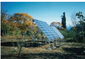
Υβριδικό φωτοβολταϊκό σύστημα με Η/Ζ, που ηλεκτροδοτεί Ιερό καλύβι στο Άγιον Όρος.
