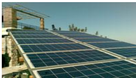
Διασυνδεδεμένο σύστημα 4,5 kWp σε πέργκολα. Τυρός Αρκαδίας, Μάρτιος 2008
