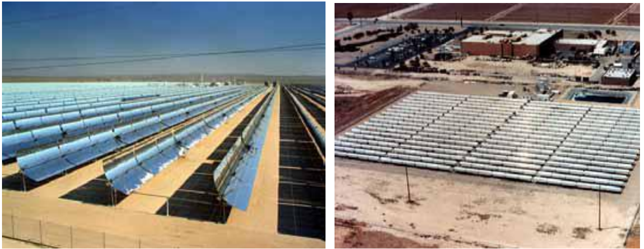
Εικόνα 2.4 Φωτογραφίες απο σταθμό ηλεκτροπαραγωγής παραβολικών κοίλων.
