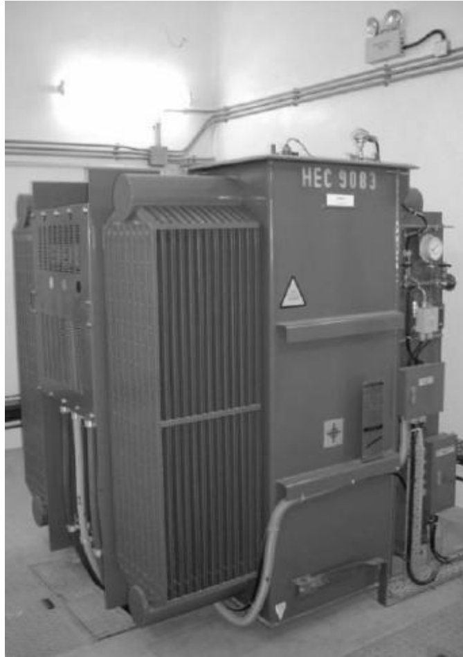
Εικόνα 2-2 Μετασχηματιστής SF6 22 kV/ 390 V Ισχύος 1500 kVA [15]
