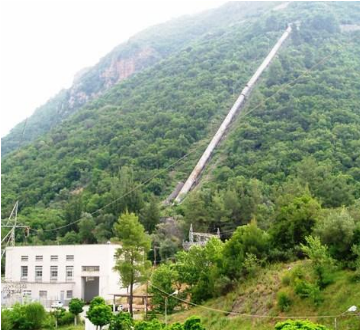
(Αγωγός πτώσεως Υ.Η.Σ. Λάδωνα)
