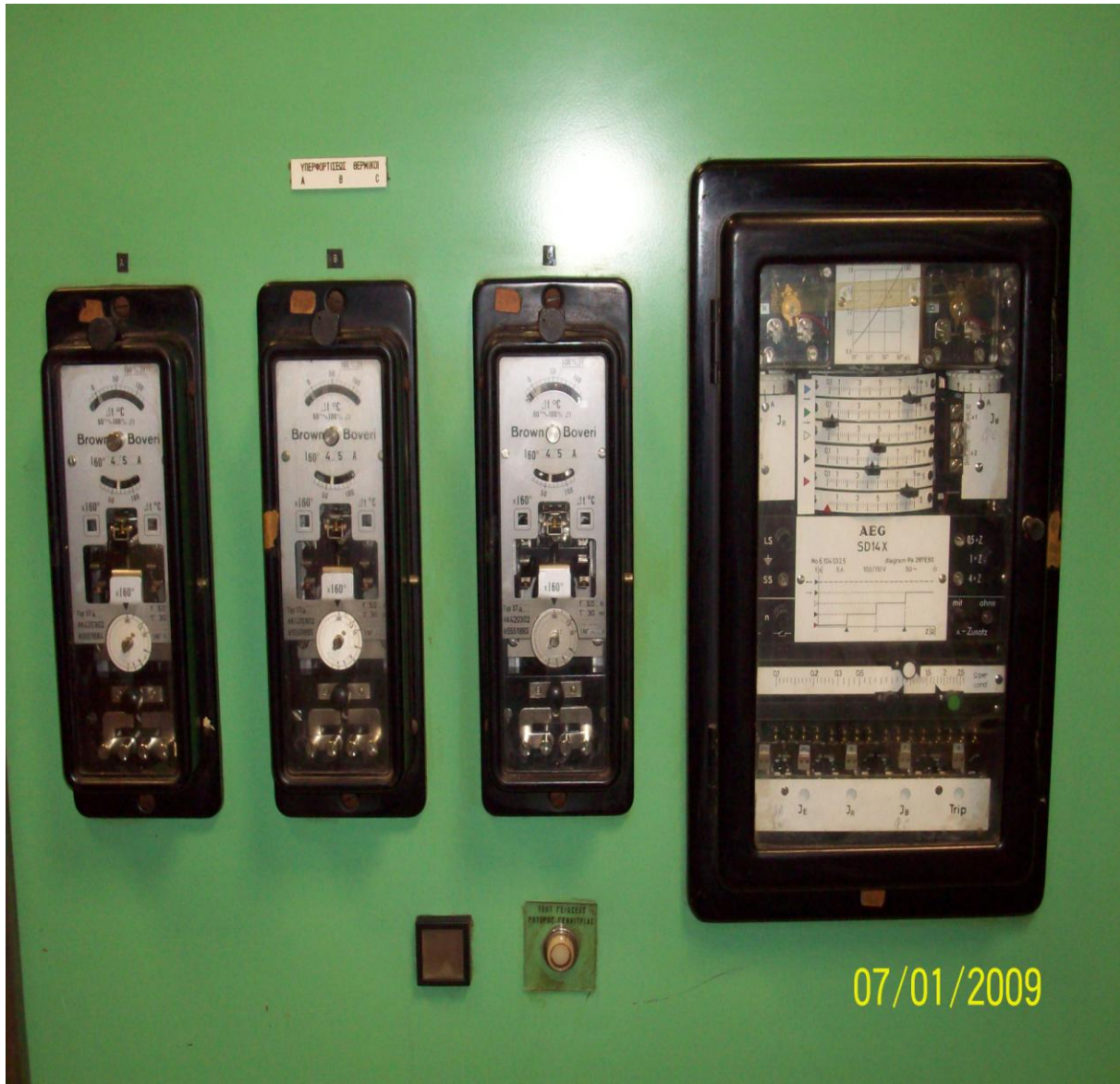
(Ηλεκτρονόμος απώλειας διέγερσης)
