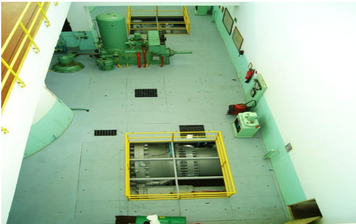
(Αγωγός υπό πίεση διακλαδισμένος όπως είναι ορατός στη μονάδα)
