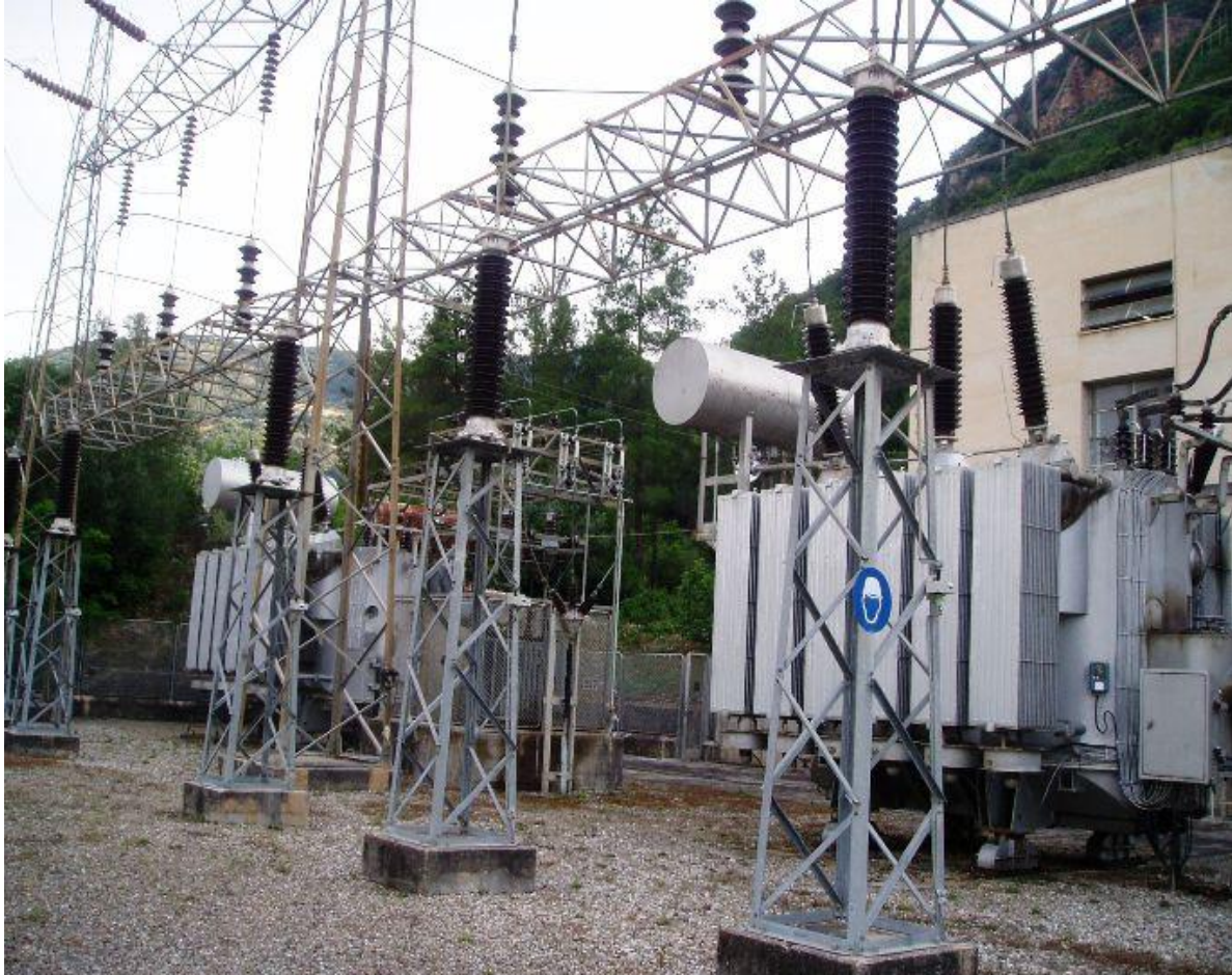
(Άποψη μετασχηματιστών μονάδος 13.1.)
