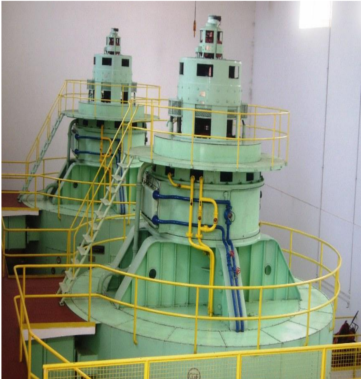
(Άποψη γεννητριών μονάδος)
