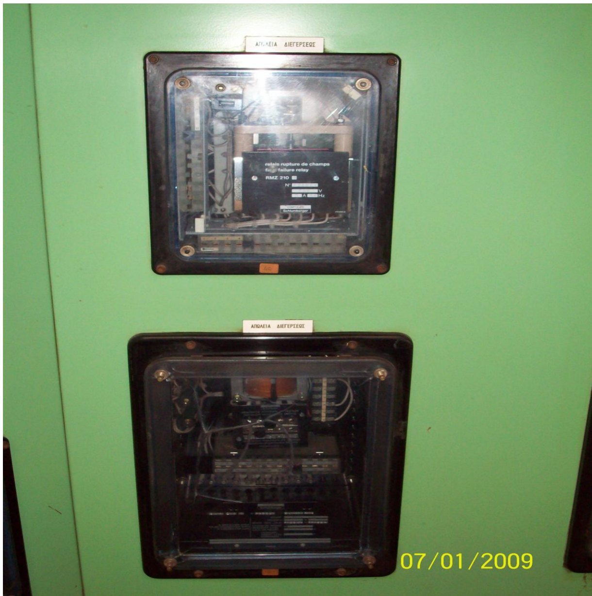
(Ηλεκτρονόμος ασύμμετρης φόρτισης)
