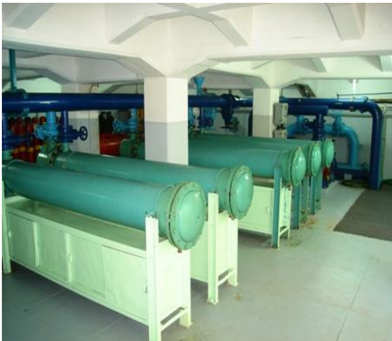
(Άποψη των 5 εναλλακτήρων)
