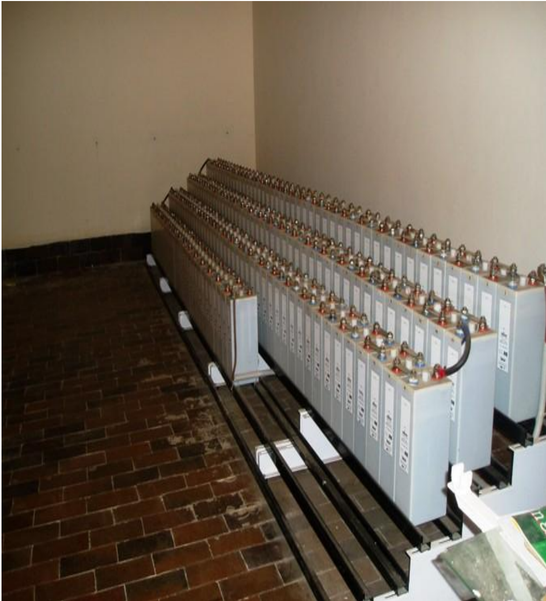
(Βοηθητικοί συσσωρευτές μονάδος)
