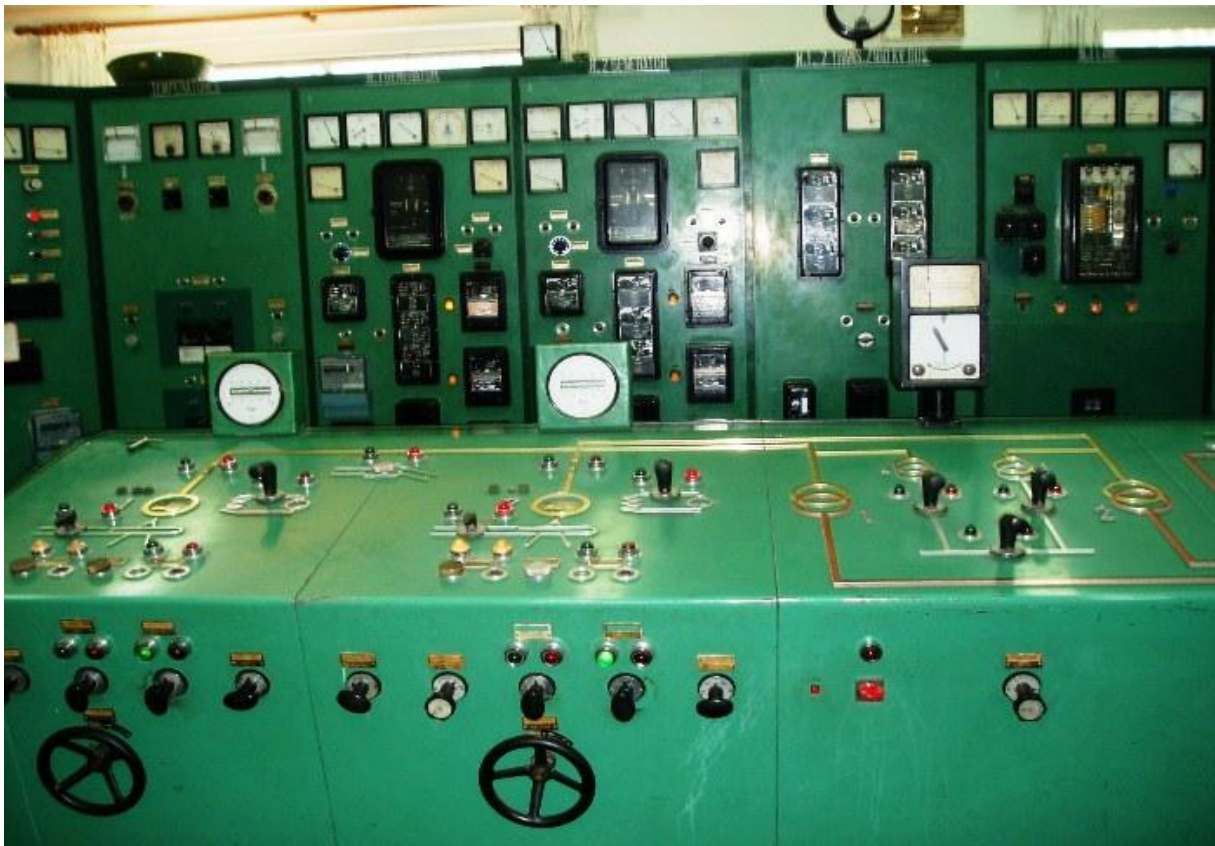
(Πάνελ συγχρονισμού αριστερά και ελέγχου Μ/Σ δεξιά )
