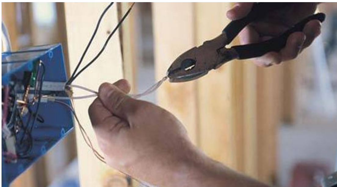
Φωτ.3.2: Κακή χρήση καλωδίων με γυμνά χέρια
