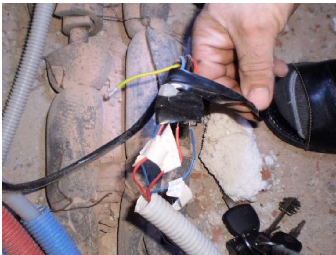
Φωτ.3.1: Κακή εικόνα εγκατάστασης καλωδίων
