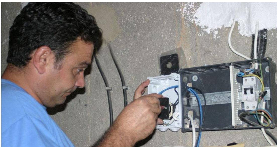
Φωτ.3.3: Κακή χρήση καλωδίων με γυμνά χέρια
