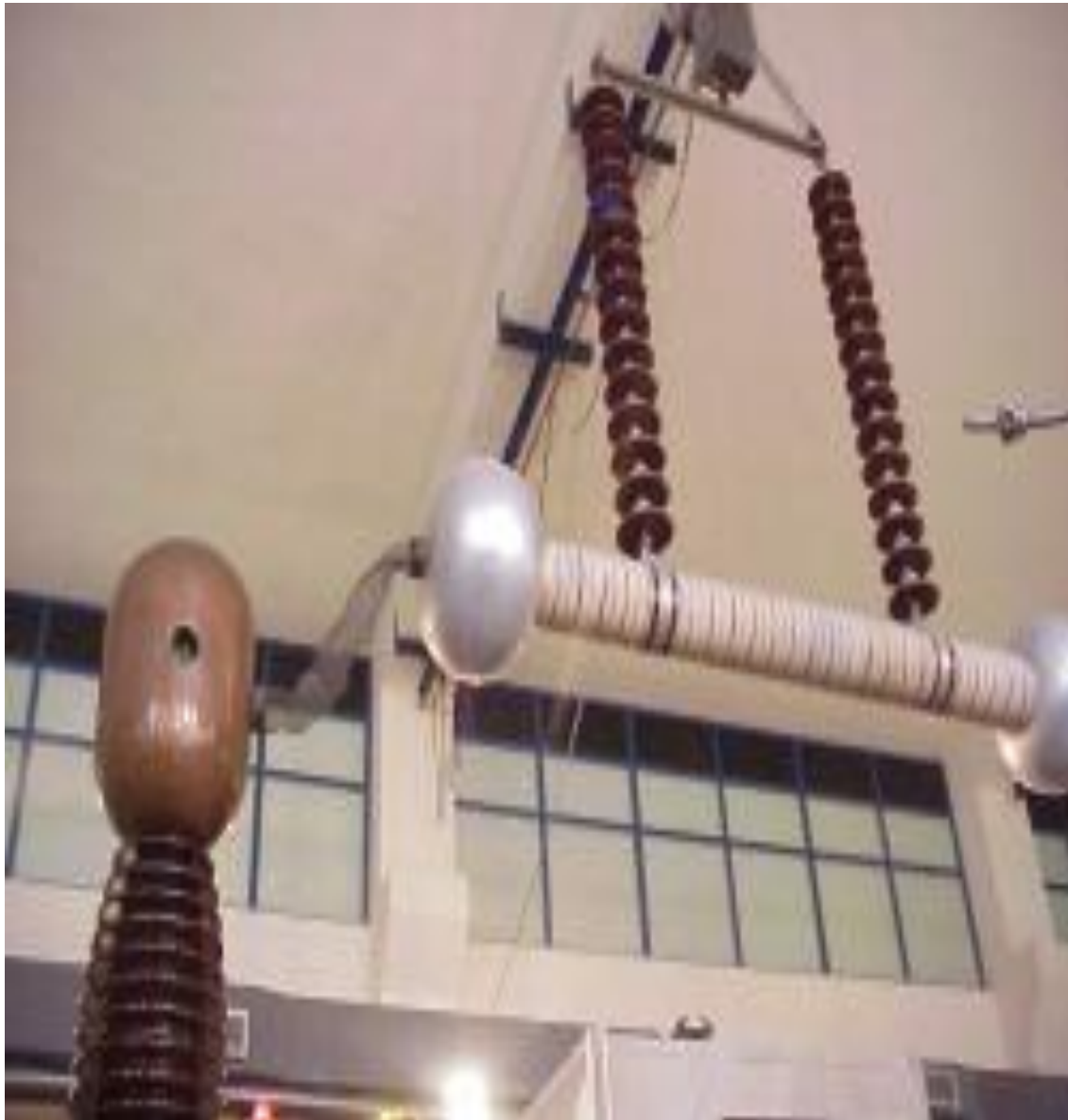
Σχήμα 1: Μια διάταξη παραγωγής υψηλών τάσεων ( από το Εργαστήριο Υψηλών τάσεων του Εθνικού Μετσόβιου Πολυτεχνείου ).
