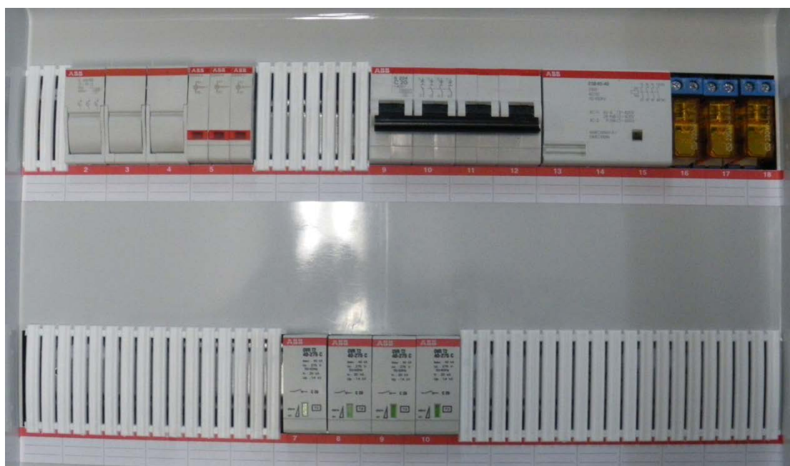
Εικόνα 5.26: Πίνακας για Φ/Β πάρκο 10 KVA με ασφαλειοποξεύκτη 3x25A, ενδεικτικά Led, γενικό διακόπτη, μικροαυτόματο 20 A, ρελέ διαφυγής 40 A, 4 αντικεραυνικά ABB κλάσης T2 και τρεις βοηθητικούς ηλεκτρονόμους που λειτουργούν ως επιτηρητές τάσης.
