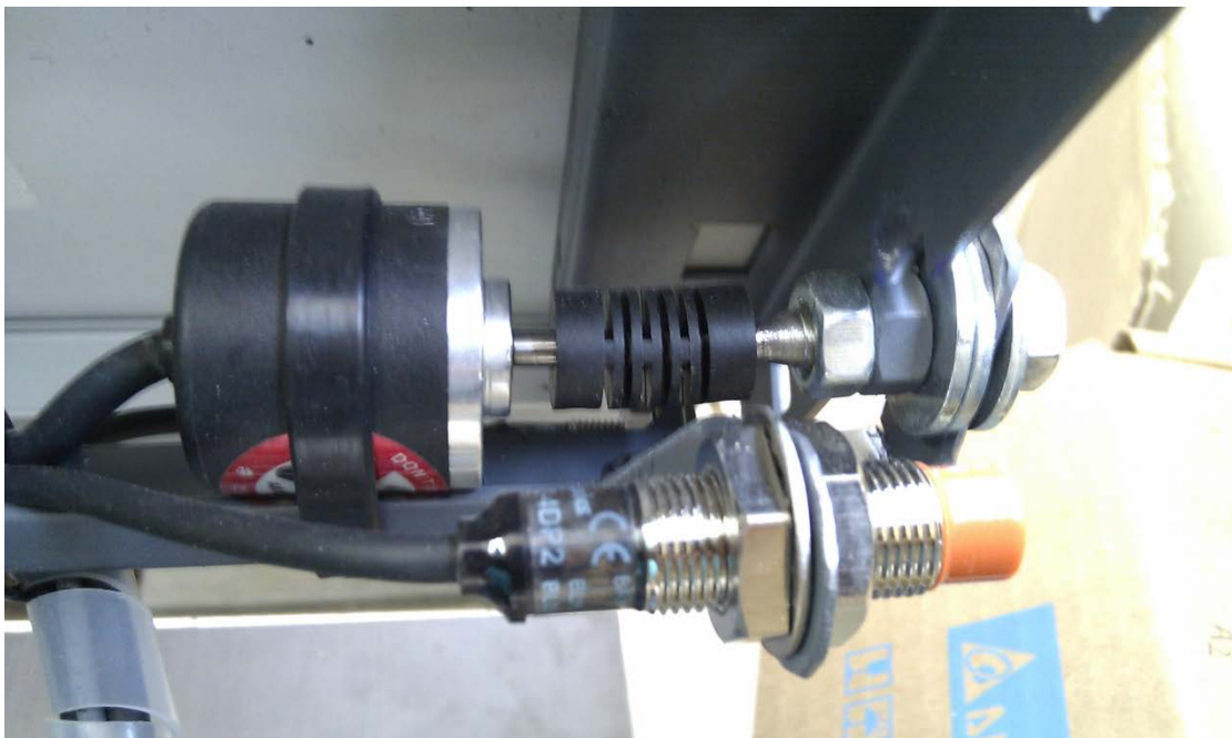
Εικόνα 6.18: Τοποθετημένος επαγωγικός διακόπτης και encoder.
