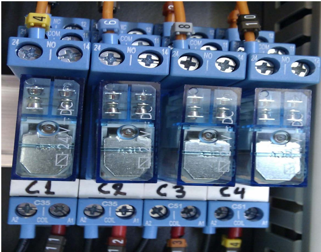
Εικόνα 6.22: Βοηθητικοί ηλεκτρονόμοι για τον τερματισμό του πάνελ στην χειροκίνητη λειτουργία.
