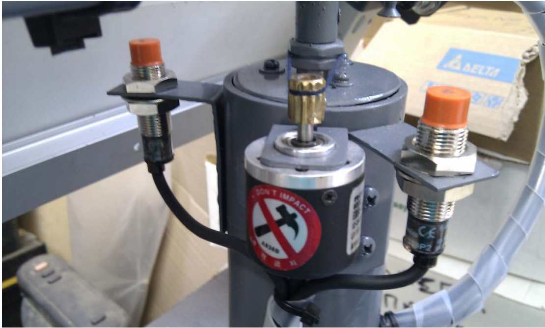
Εικόνα 6.19: Τοποθέτηση επαγωγικών και του encoder για το τέρμα του Φ/Β πάνελ της κίνησης ανατολής – δύσης.
