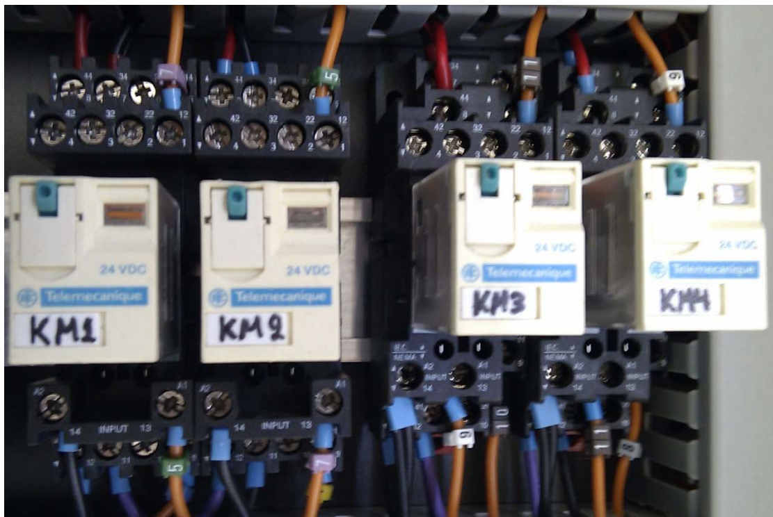
Εικόνα 6.21: Ηλεκτρονόμοι υπεύθυνοι για την κίνηση των μοτέρ.
