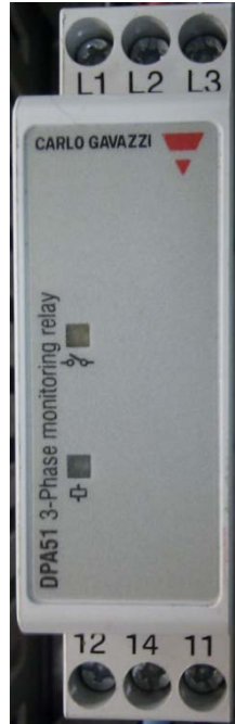
Εικόνα 5.17: Επιτηρητής τάσης χωρίς ρύθμιση που ελέγχει την διαδοχή φάσεων και την έλλειψη κάποιας φάσης.
