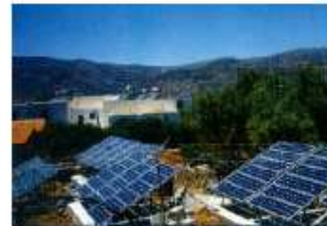
Ξενοδοχείο στην Κρήτη (8,5 kWp) Πηγή: ΣΕΝΕΡΣ ΕΠΕ
