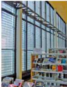
Ημιδιαφανή ΦΒ 53 kWp στις όψεις δημοτικού κτιρίου στην Ισπανία Πηγή: www.pure-eie.com
