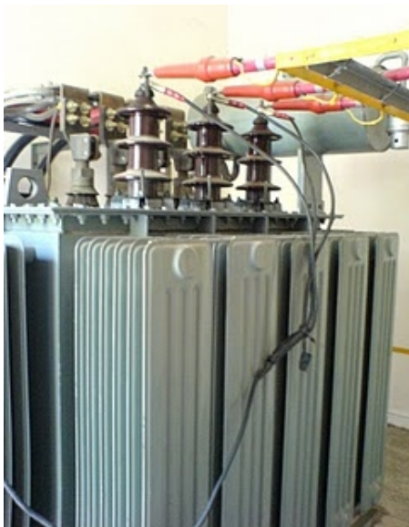
Εικόνα 1.1 ΜΣ μέσης τάσης 20 kV
