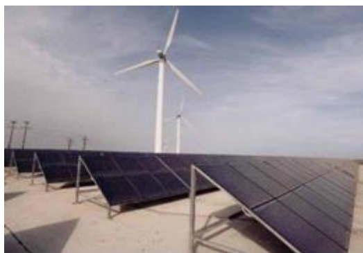
Εικόνα: Φωτοβολταϊκά πλαίσια τοποθετημένα με σταθερή γωνία κλίσης
