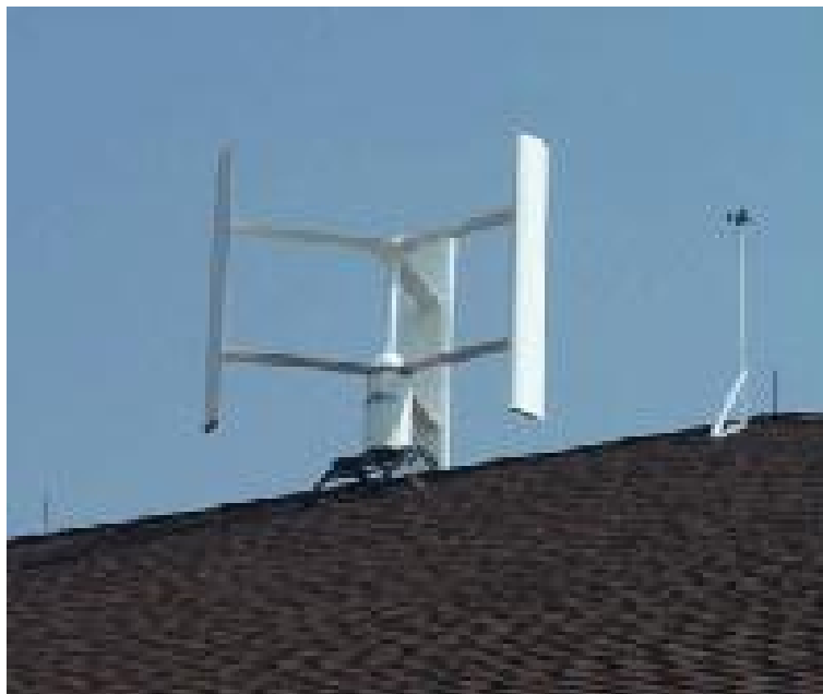
Ανεμογεννήτρια κατακόρυφου άξονα εγκατεστημένη πάνω σε οικία (Πηγή: GreenStrides)
