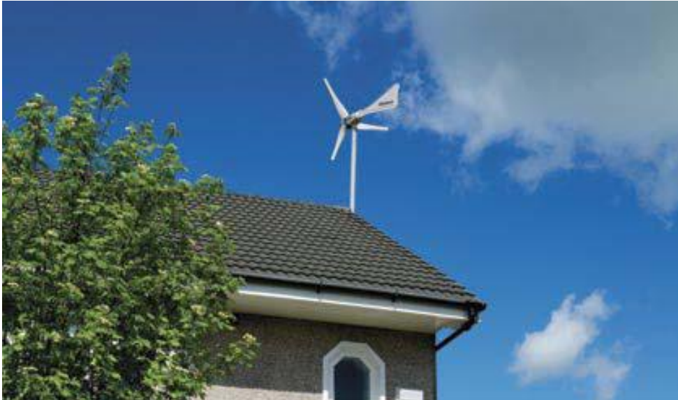
Ανεμογεννήτρια οριζόντιου άξονα εγκατεστημένη πάνω σε οικία
