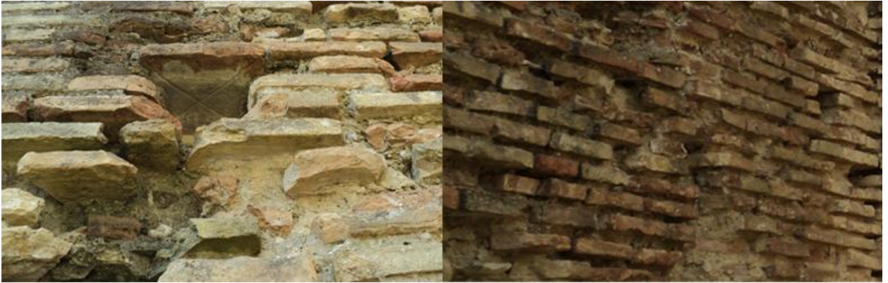
Εικόνα 4. 19 Αποδιοργάνωση, αποσάθρωση και αποκόλληση κονιάματος
