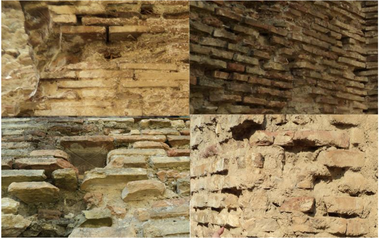
Εικόνα 4. 23 Αποκολλήσεις της τοιχοποιίας
