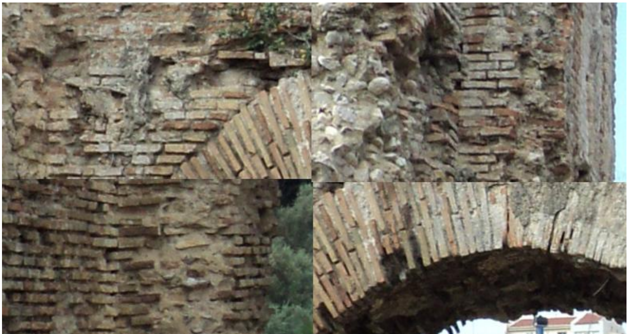
Εικόνα 4. 22 Αποκολλήσεις της τοιχοποιίας
