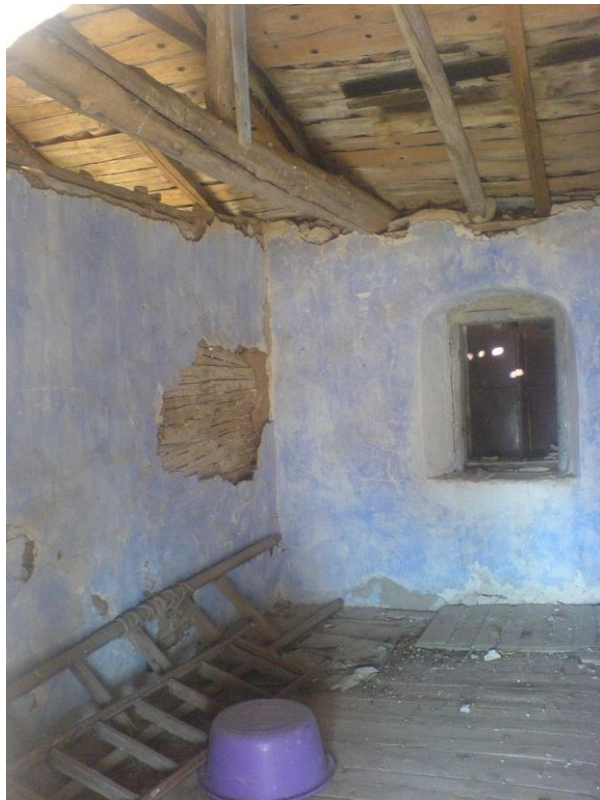
52. Κατάσταση δαπέδου κελιού.
