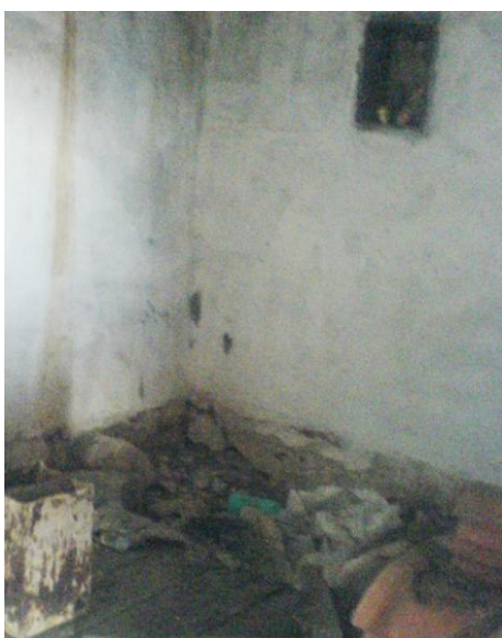
89. Διαβρωμένο δάπεδο σε κελί
