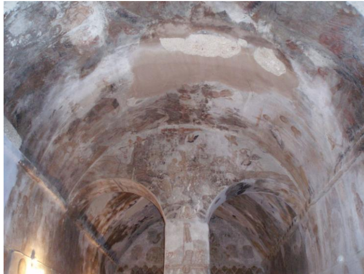
82. Υγρασία στο εσωτερικό του ναού και ρωγμές στα τόξα
