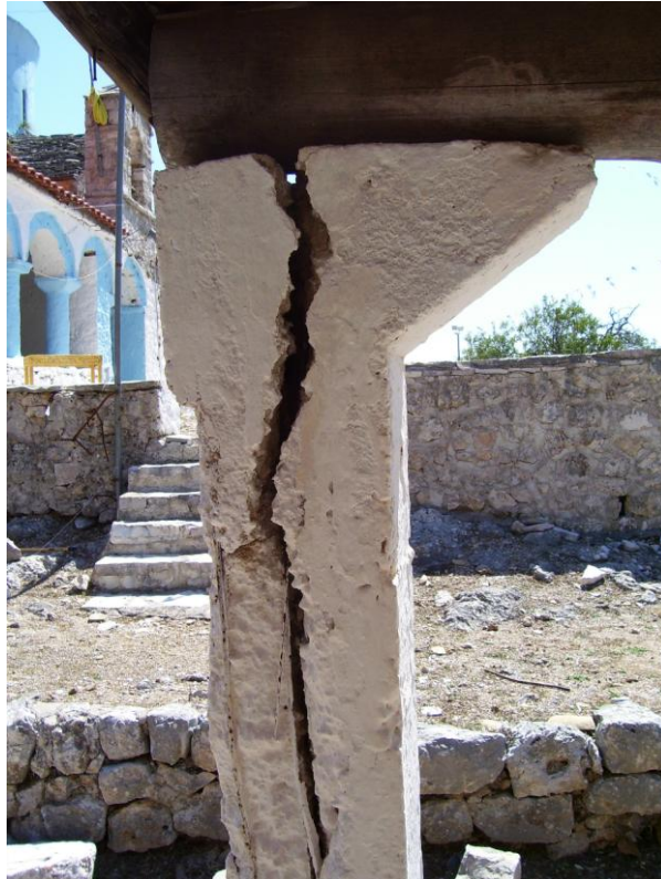
50. Ρωγμή σε πεσσό που στηρίζει τη στέγη των κελιών
