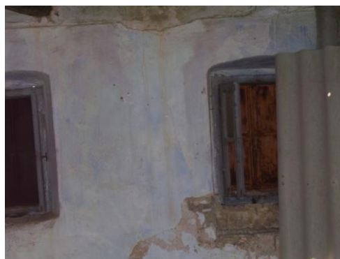
95. Κατάσταση επιχρίσματος στο εσωτερικό κελιού
