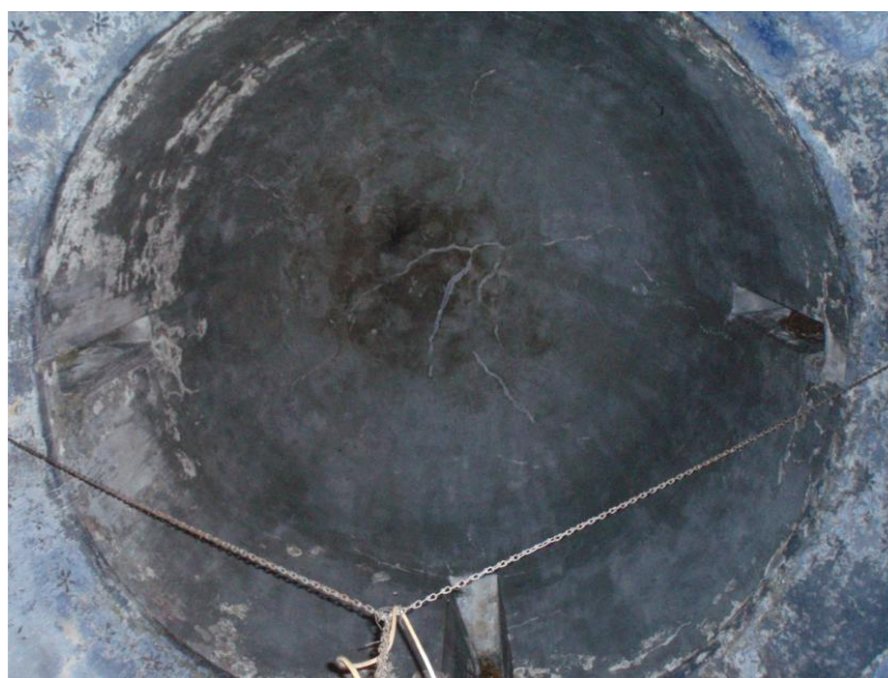
83. Υγρασία στο εσωτερικό του τρούλου
