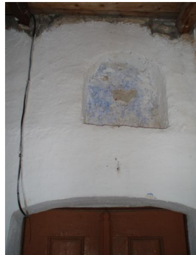
100. Αλλοίωση χρωμάτων σε κόγχη του ιερού
