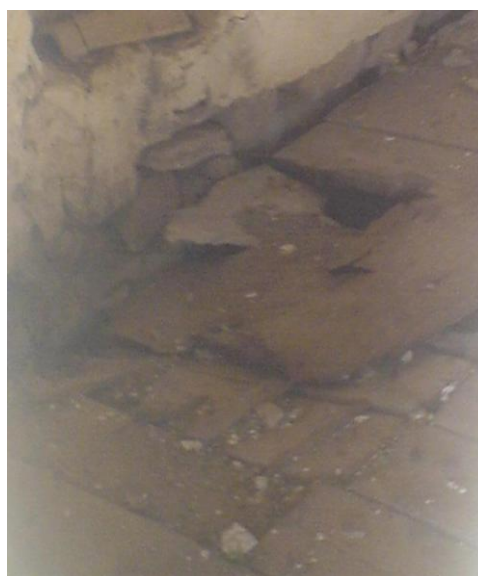
90. Κατάρρευση τμήματος δαπέδου
