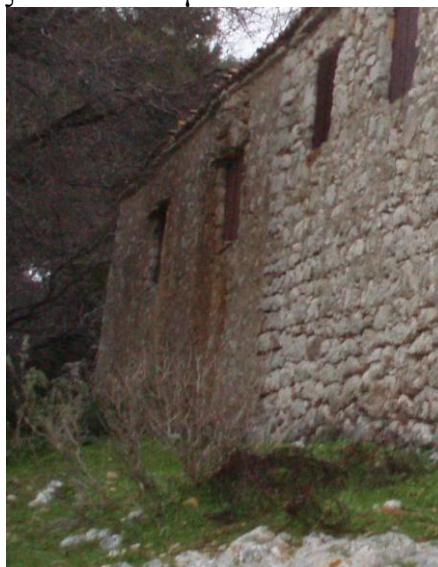
93. Οξείδωση μεταλλικών κουφωμάτων.
