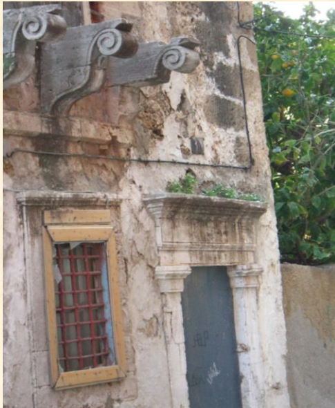
Εικόνα 58: Εμφάνιση πρασινάδας στο πάνω μέρος των ανοιγμάτων
