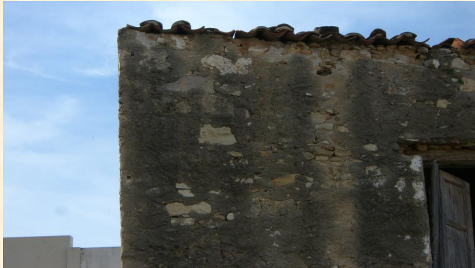
Εικόνα 64: Αποκόλληση επιχρίσματος, εμφάνιση μούχλας
