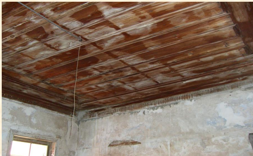
Εικόνα 54: Ταβάνι στον α΄ όροφο όπου έχει παρουσίαση μούχλα και έχει αλλοιωθεί το χρώμα του
