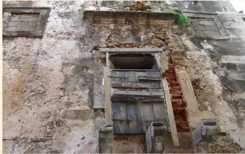
Εικόνα 60: Αποκόλληση επιχρίσματος και εμφάνιση της λιθοδομής
