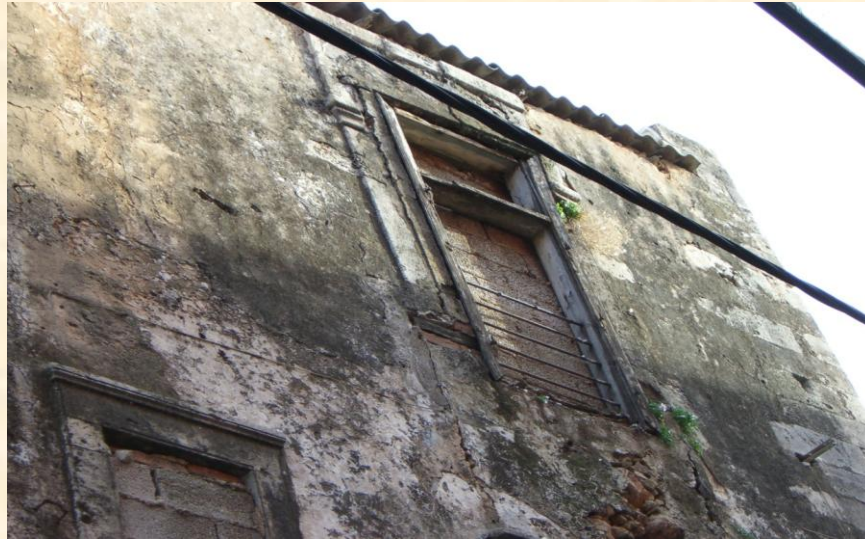
Εικόνα 62: Αλλοίωση του χρώματος του επιχρίσματος
