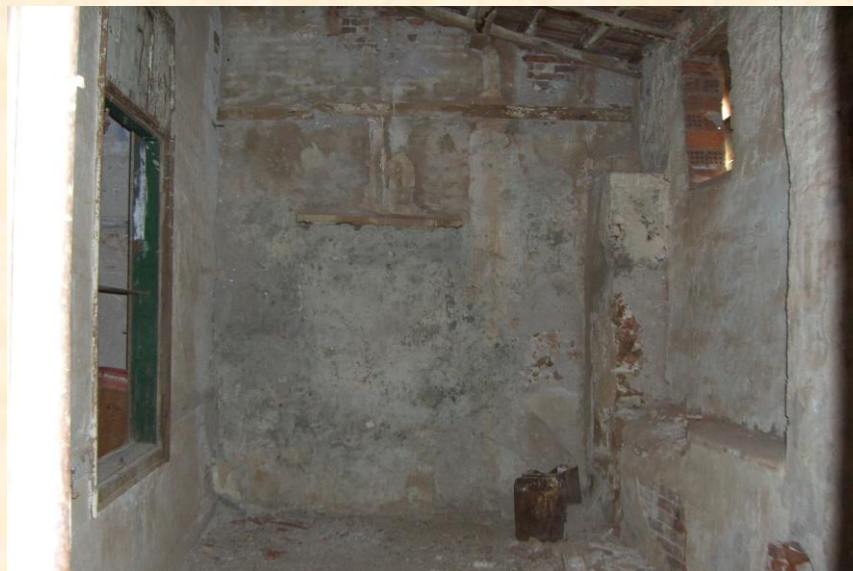
Εικόνα 56: Αποκόλληση επιχρίσματος και καθαίρεση κουφωμάτων
