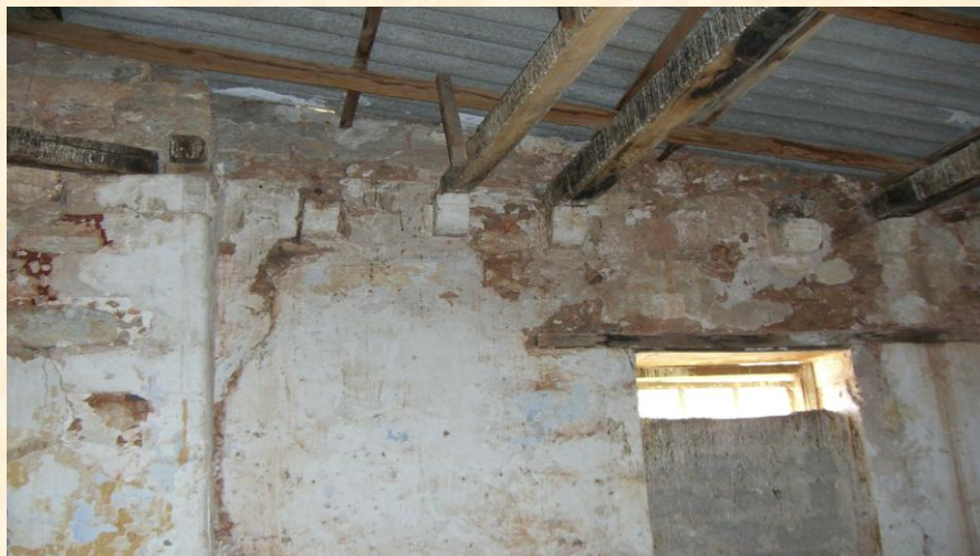
Εικόνα 55: Η τοιχοποιία έχει αποκολληθεί και τα ξύλινα στοιχεία που στηρίζουν τα φύλλα ελλενίτ έχουν αποσαθρωθεί
