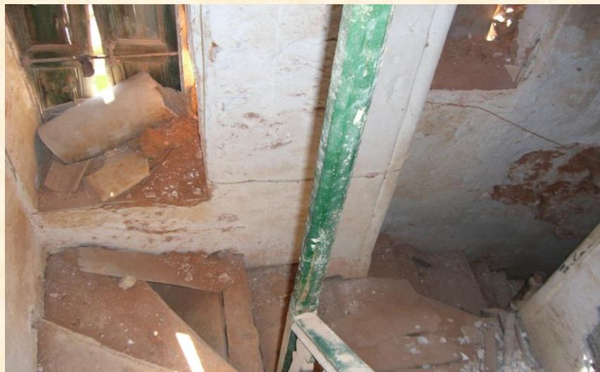
Εικόνα 52: Κατάσταση εσωτερικής ξύλινης σκάλας. Μεγάλο μέρος της είναι σπασμένο και αποκολλημένο
