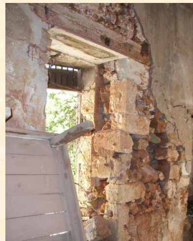
Εικόνα 50: Μέρος τοιχοποιίας στον α΄ όροφο όπου έχει αποκολληθεί
