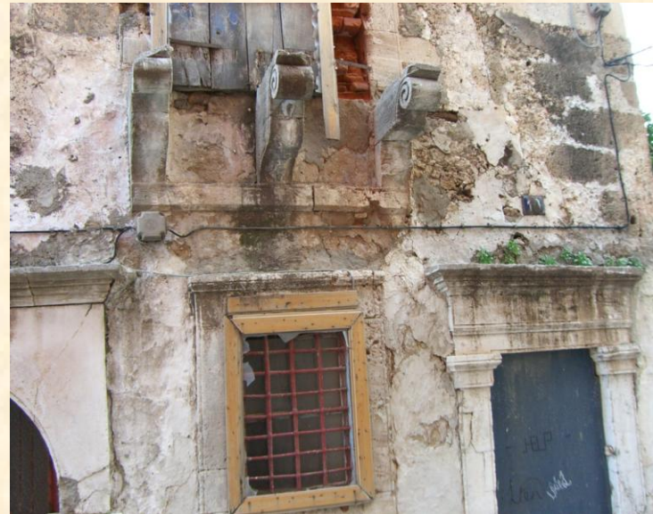
Εικόνα 59: Αποκόλληση διακοσμητικών στοιχείων περιμετρικά των ανοιγμάτων
