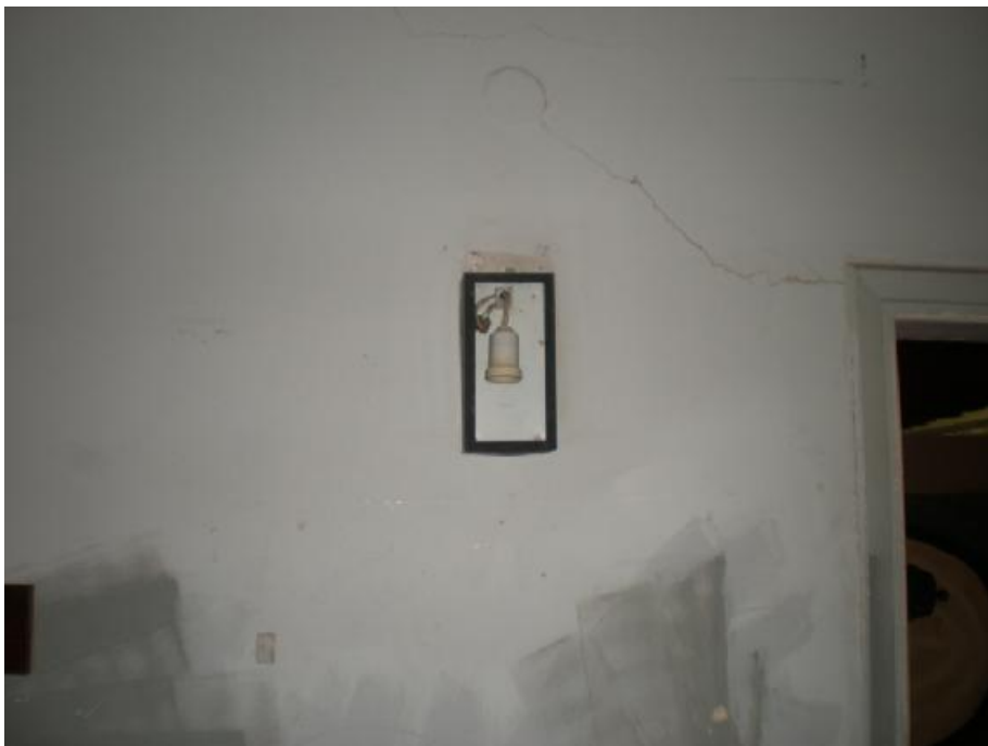
238. Ρωγμή σε κούφωμα
