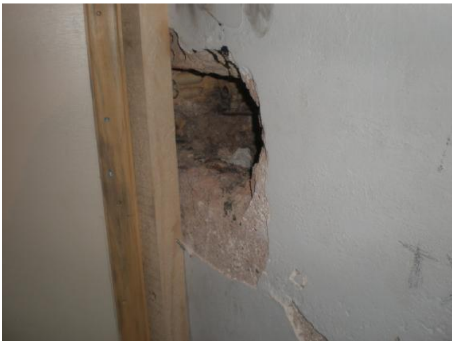
239. Τοπική κατάρρευση σκυροδέματος
