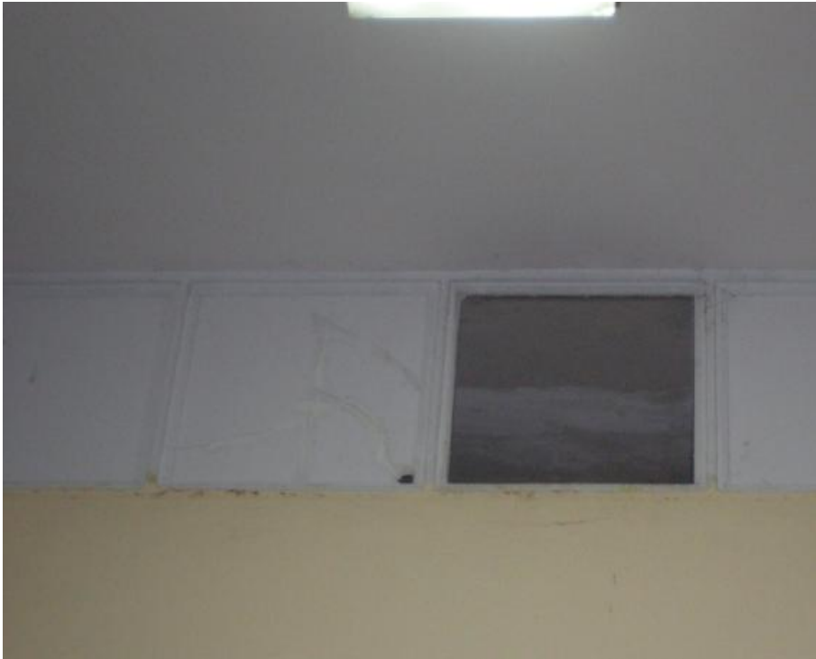
236. Ρωγμή σε σφραγισμένο φεγγίτη
