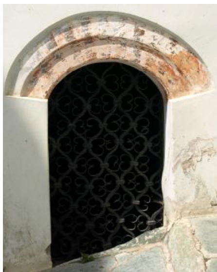
Εικόνα 1. Παράθυρο με τοξωτό υπέρθυρο κοσμημένο με ζωγραφιστούς θολίτες, δεξιά της εισόδου του αρχοντικού (προσωπικό αρχείο του Σ. Μ. Αραμπατζή).
