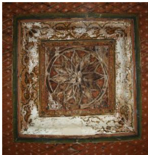
Εικόνα 51. Το φάτνωμα του ταβανιού της κρεβάτας (προσωπικό αρχείο του Σ. Μ. Αραμπατζή).
