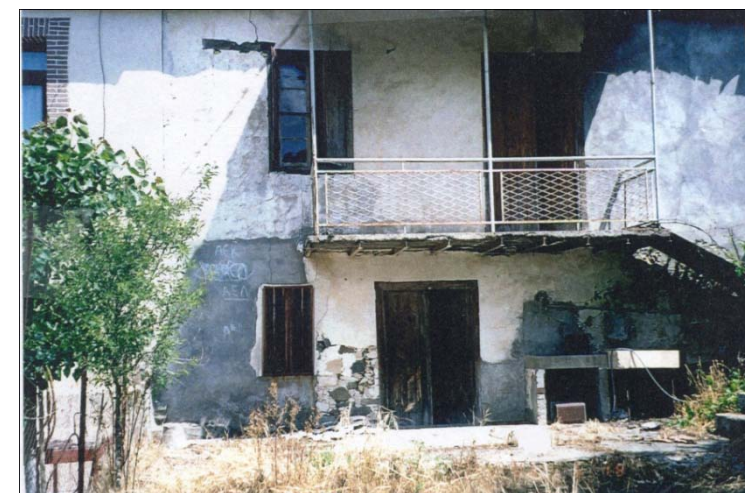
Εικόνα 94 επίχρισμα στην πρόσοψη του κτιρίου
