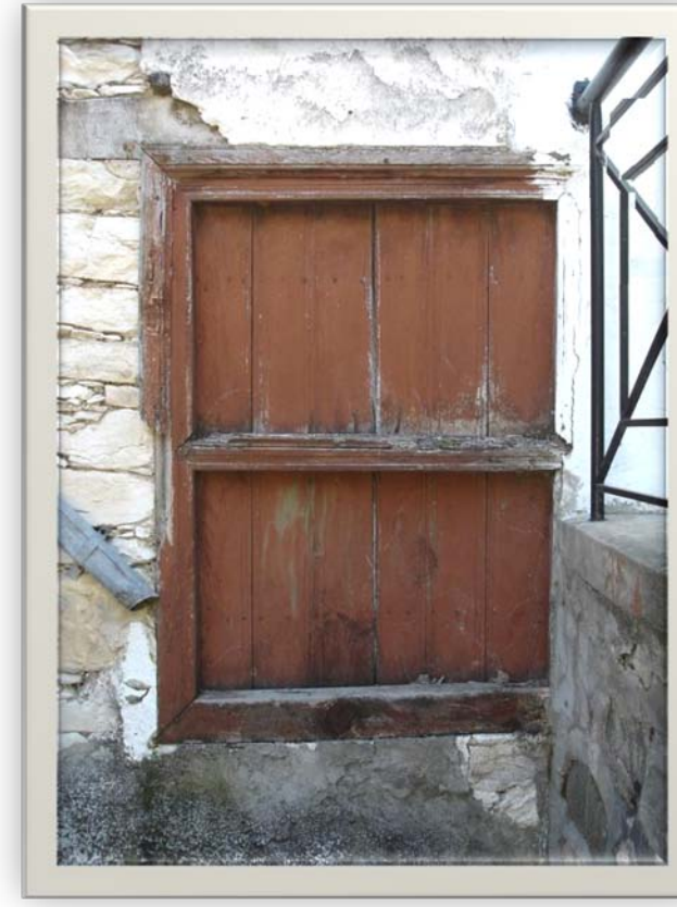
Εικόνα 35 ΠΑΡΑΘΥΡΟ ΣΤΗΝ ΒΟΡΕΙΑ ΟΨΗ ΣΥΝΟΡΑ ΓΕΙΤΟΝΙΚΟΥ ΚΤΙΡΙΟΥ
