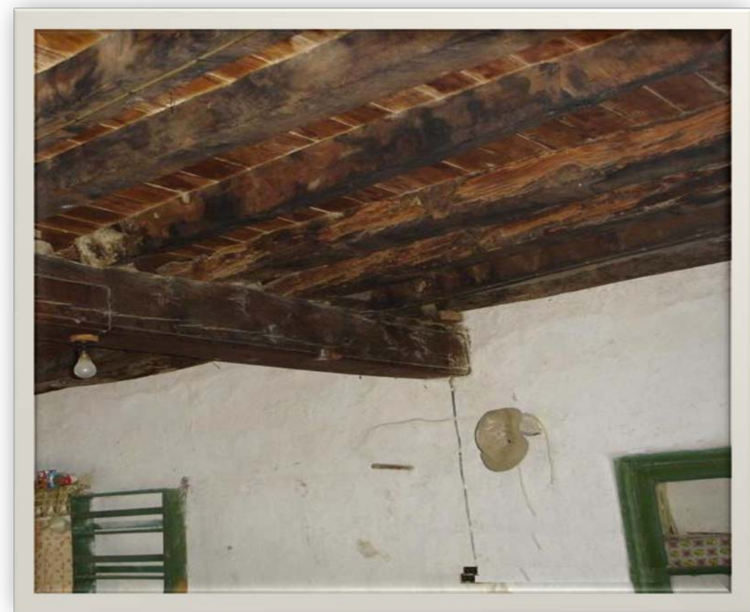
Εικόνα 75 ΠΡΟΒΟΛΗ ΡΗΓΜΑΤΩΣΗΣ ΣΤΟΝ ΤΟΙΧΟ ΑΠΟ ΤΗΝ ΦΟΡΤΙΣΗ ΤΗΣ ΔΟΚΟΥ
