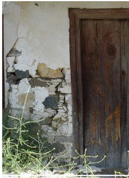
Εικόνα 8 έντονη ρηγμάτωση στην τοιχοποιία
