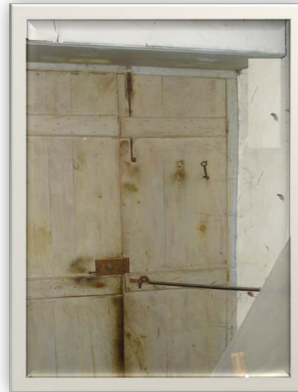
Εικόνα 14 ΘΥΡΑ ΕΙΣΟΔΟΥ ΣΑΛΟΤΡΑΠΕΖΑΡΙΑΣ ΕΣΩΤΕΡΙΚΗ ΛΗΨΗ
