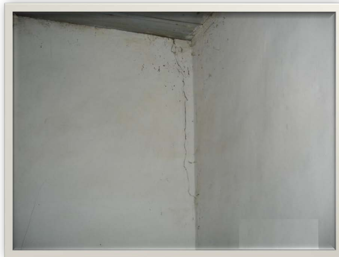
Εικόνα 58 ΕΝΤΟΝΗ ΡΗΓΜΑΤΩΣΗ ΣΤΗΝ ΤΟΙΧΟΠΟΙΙΑ ΣΤΟ ΒΟΡΕΙΟ ΔΩΜΑΤΙΟ ΣΤΗΝ ΓΩΝΙΑ ΤΩΝ ΤΟΙΧΩΝ
