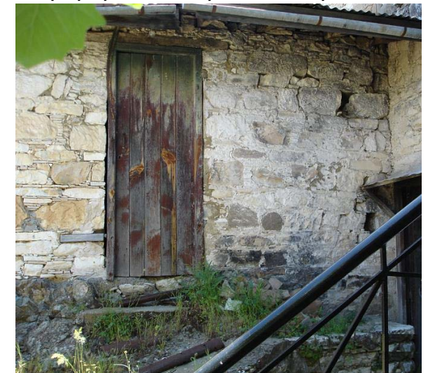
Εικόνα 33 φθορές στο αρμολόγημα της τοιχοποιίας
