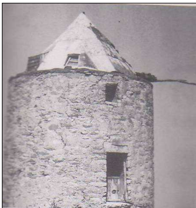
εικ.67. Τετράρριχτη πυραμιδόσχημη ξύλινη τρούλα με παραθυράκι, Αμοργός (Πηγή: Ο ανεμόμυλος στις Κυκλάδες)
