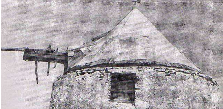
εικ.63. Ξύλινη κωνική ψηλή τρούλα ντυμένη με τσίγκο(Αμοργός-Χώρα) (Πηγή: Ο ανεμόμυλος στις Κυκλάδες)
