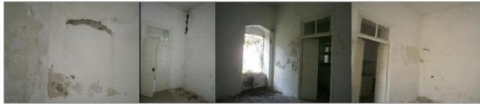
1. Χώρος 1.0 8(Εκ. 156)Αποκόλληση σοβά 2. Χώρος 1.0 8(Εκ. 305) 3. Χώρος 1.0 8(Εκ. 152) 4. Χώρος 1.0 8(Εκ. 153)
