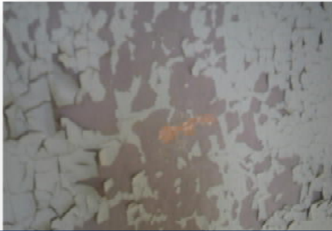
Εικ.241 Χώρος 3.02-Αποφλοίωση χρώματος
