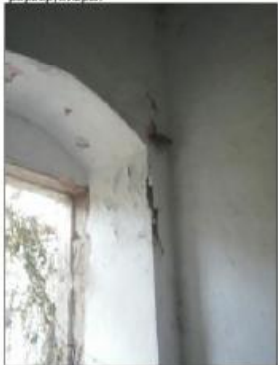
Χώρος 1.0 8(Εκ. 154)Αποκόλληση επιχρίσματος
