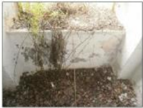
Χώρος 1.0 8(Εκ. 155)Αποκόλληση επιχρίσματος και εμφάνιση μικρορραγιών στην
