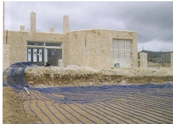
Εικόνα 100: Άποψη της κατοικίας κατά τη διάρκεια της κατασκευής. Η εγκατάσταση των σωληνώσεων του συστήματος γεωθερμίας καλύπτει επιφάνεια 700 τ.μ.
