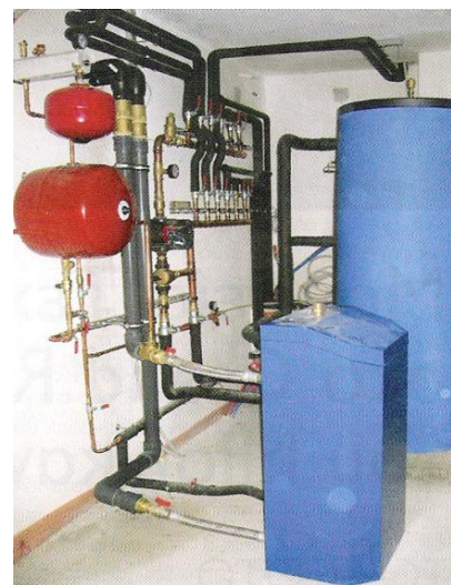
Εικόνα 101: Το μηχανοστάσιο της κατοικίας με τη γεωθερμική αντλία θερμότητας.
