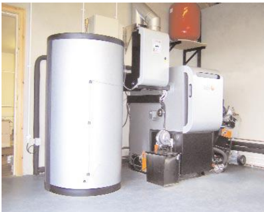
Εικόνα 92: Τα συστήματα κεντρικής θέρμανσης με βιομάζα μπορούν να χρησιμοποιηθούν ως εναλλακτική λύση των συμβατικών συστημάτων θέρμανσης.
