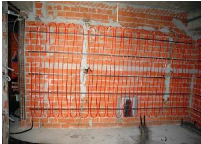
Εικ.4.11 Η επιτοιχία θέρμανση του κτιρίου
