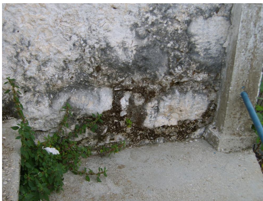
72. Απεικονίζεται η φθορά της εξωτερικής τοιχοποιίας από την υγρασία.
