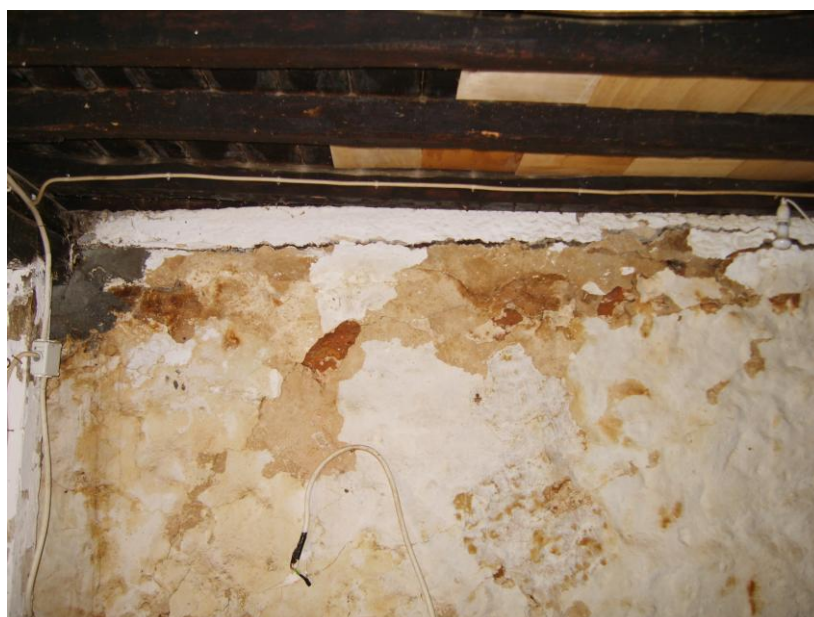
67. Απεικονίζονται οι ρωγμές και η υγρασία στο μεσότοιχο.
