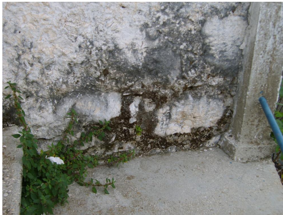
42. Στην ανατολική όψη εμφανίζεται υγρασία στους εξωτερικούς τοίχους.
