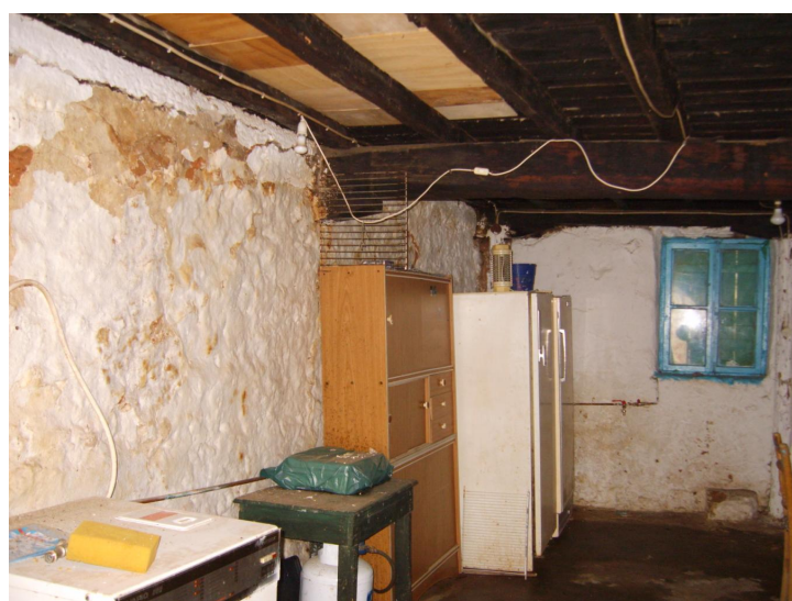
68. Απεικονίζονται οι ρωγμές και η υγρασία στο μεσότοιχο.
