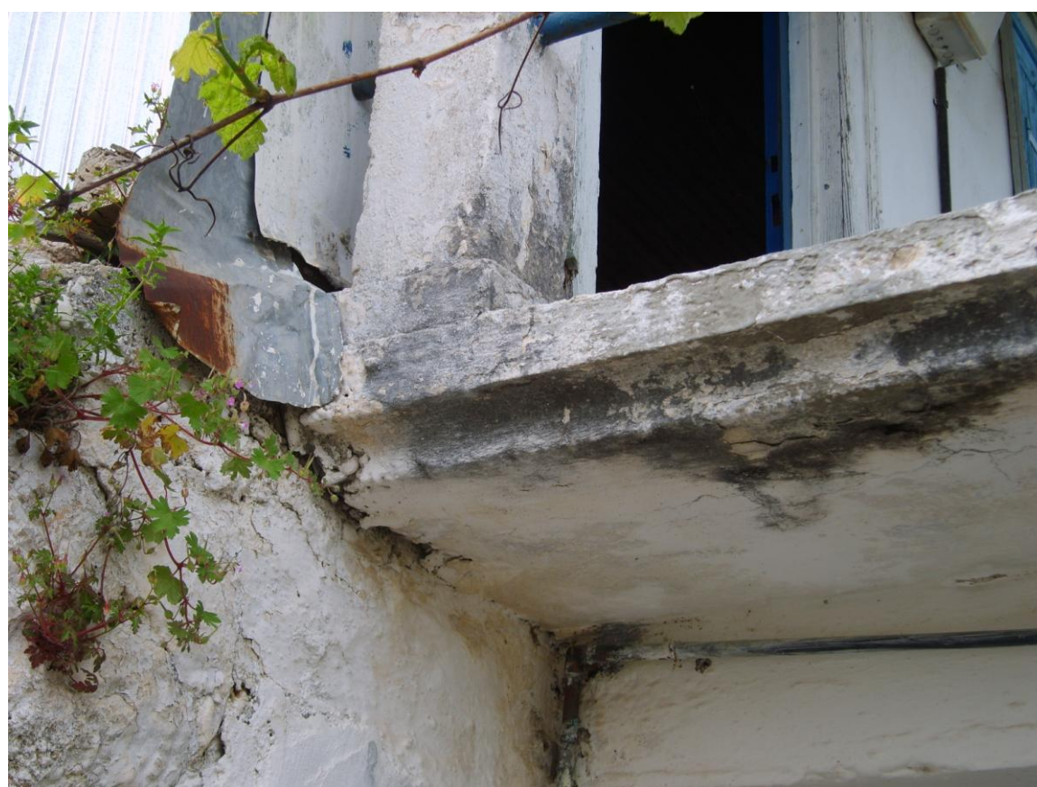
59. Η πλάκα του εξώστη που έχει υγρασία.
