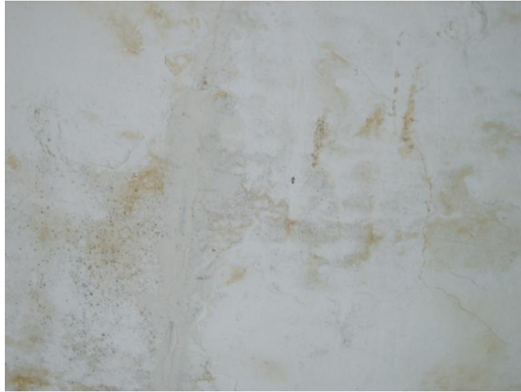
73. Απεικονίζεται η φθορά της εσωτερικής τοιχοποιίας από την υγρασία.
