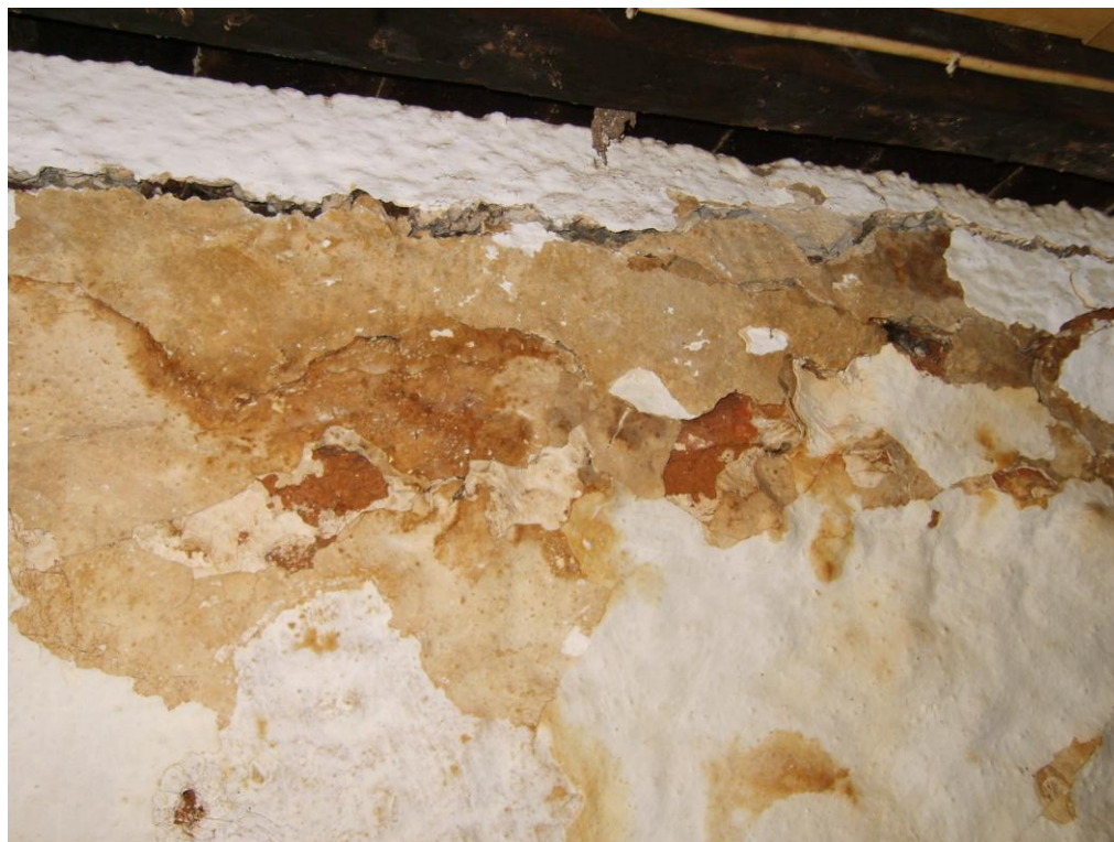
43. Μεσότοιχος με το κτιρίου 1 που λόγω της κατάρρευσης του κτιρίου 2 έχουν προκληθεί ρωγμές.
