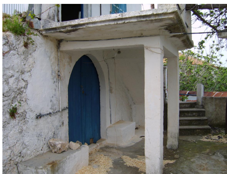
71. Απεικονίζεται η φθορά της πλάκας του εξώστη με τα υποστηλώματα
