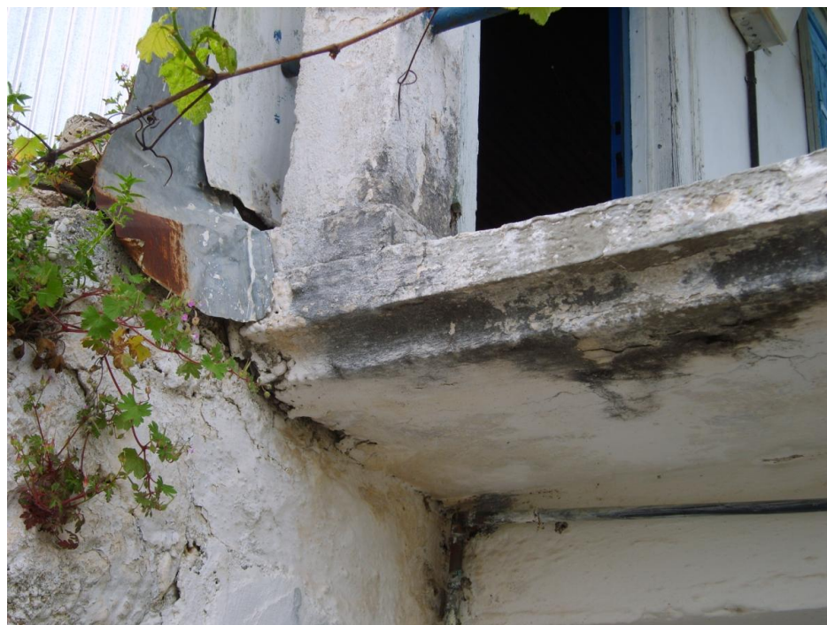
70. Απεικονίζεται η φθορά της πλάκας του εξώστη.
