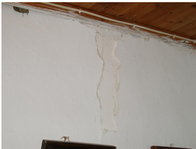
74. Απεικονίζεται η φθορά της εσωτερικής τοιχοποιίας με τις ρωγμές.
