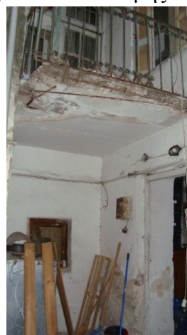
Π27. Άποψη εξώστη ισογείου, εμφανής η διάβρωση μεταλλικών οπλισμών.
