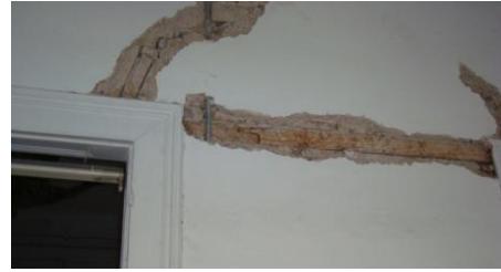
Π11. Αποκόλληση επιχρίσματος και εμφάνιση ξυλοδεσιάς. Χώρος 310.
