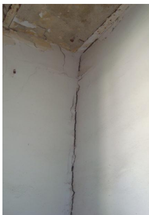
Π23. Αποκόλληση τοιχοποιών λιθοδομής και διάτρητης οπτοπλινθοδομής. Χώρος 306.
