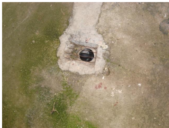
Εικόνα 44. Σιφόνι στον ακάλυπτο χώρο, πιθανόν εκεί γίνεται η εκροή των όμβριων υδάτων.
