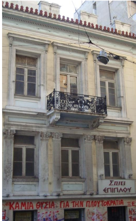
M4. Βόρεια όψη. Άποψη του προεξέχοντος κεντρικού άξονα με το χυτοσιδηρό κιγκλίδωμα.
