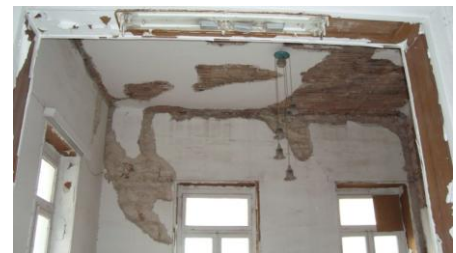
Π4. Αποκόλληση επιχρίσματος στη λιθοδομή και οροφοκονιάματος. Χώρος 304.
