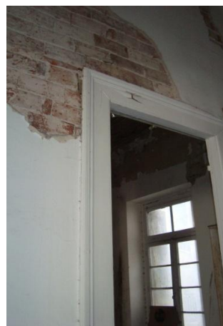
Π26. Αποκόλλησης επιχρίσματος διάτρητης οπτοπλινθοδομής. Χώρος 311.
