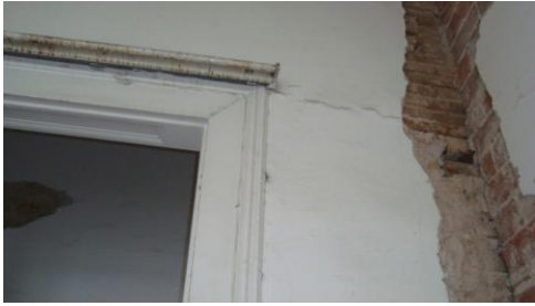
Π10. Αποκόλληση επιχρίσματος και αποκόλληση οπτοπλινθοδομών με διάτρητο και συμπαγές πλίνθο. Χώρος 305.
