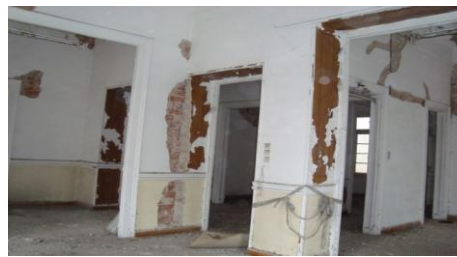
Π15. Γενική άποψη χώρων 302,303,304 με εμφανής την αποκόλληση επιχρίσματος και την αλλοίωση την ξύλινη ταπετσαρία.
