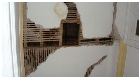
Π5. Αποκόλληση επιχρίσματος & οροφοκονιάματος. Χώρος 300.
