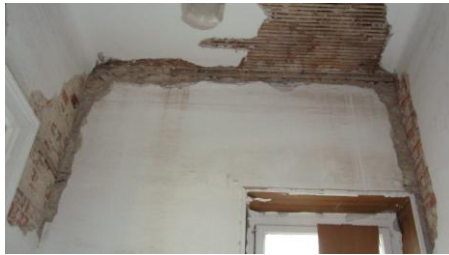
Π12. Αποκόλληση επιχρίσματος και οροφοκονιάματος. Χώρος 302.
