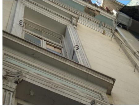
Π32. Άποψη της όψης επί της οδού Γρ. Λαμπράκη όπου παρατηρείται τμηματική αποκόλληση τραβηγτού επιχρίσματος.
