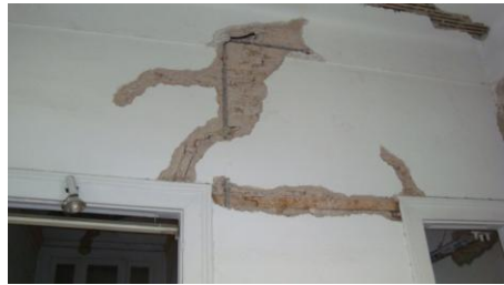
Π6. Αποκόλληση επιχρίσματος τοιχοποιίας, εμφάνιση μεταλλικών σωληνώσεων. Χώρος 304.
