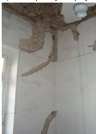
Π19. Αποκόλληση επιχρίσματος, τοιχοποιών και οροφοκονιάματος. Χώρος 312.
