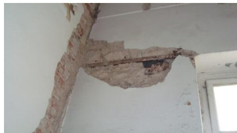
Π8. Αποκόλληση επιχρίσματος λιθοδομής, μερική αποδιοργάνωση συνδετικού υλικού και αποκόλληση με οπτοπλινθοδομή. Χώρος 305.
