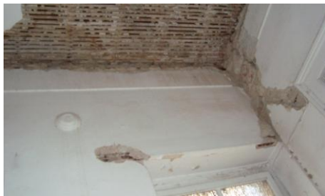
Π3. Αποκόλληση επιχρίσματος και οροφοκονιάματος. Χώρος 303.
