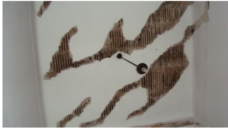
Π1. Αποκόλληση επιχρίσματος και οροφοκονιάματος. Χώρος 301.
