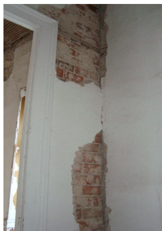
Π20. Αποκόλληση επιχρίσματος και εμφάνιση ξυλοδεσιάς. Χώρος 301.
