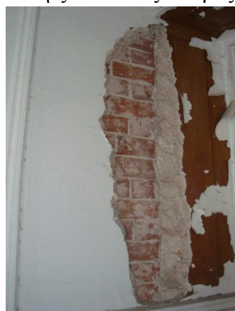
Π21. Αποκόλληση επιχρίσματος και φαίνεται η διαφορετικότητα υλικών των τοιχοποιών
