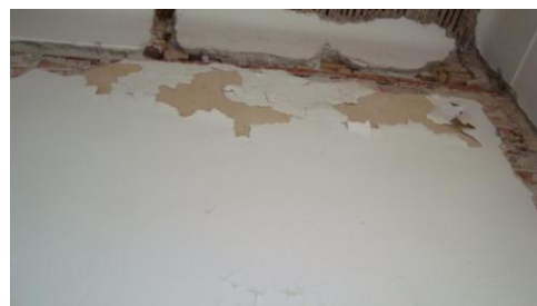
Π9. Αποδιοργάνωση στη στέγη της οπτοπλινθοδομής από τρίαπα τούβλα και εμφάνιση μεταλλικού δοκού Karpen. Χώρος 305.
