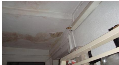
Π14. Άποψη οροφής με εμφανής το σκυρόδεμα στον χώρο λόγω αποκόλλησης επιχρίσματος. 101.
