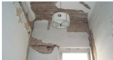
Π7. Αποκόλληση επιχρίσματος λιθοδομής, και τοιχοποιιών με διάτρητους πλίθους. Χώρος 305.
