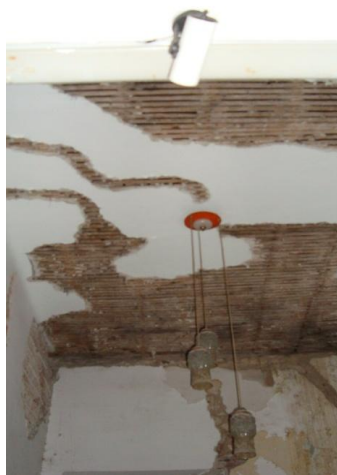
Π16. Αποκόλληση επιχρίσματος και οροφοκονιάματος. Χώρος 311.
