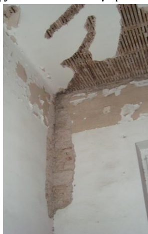
Π18. Αποκόλληση επιχρίσματος, λιθοδομής με οπτοπλινθοδομής και οροφοκονιάματος. Χώρος 312.
