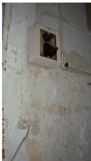
Εικόνα 46. Μεταγενέστερος πίνακας ηλεκτροδότησης.
