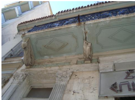
Π31. Άποψη του μαρμάρινου φουρυσσιού επι της οδού Γρ. Λαμπράκη που έχει μερικώς αποκολληθεί.
