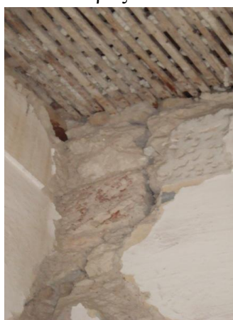
Π25. Αποκόλληση επιχρίσματος λιθοδομής και οροφокονιάματος στο σημείο έδρασης των οροφопήγεων. Χώρος 303.
