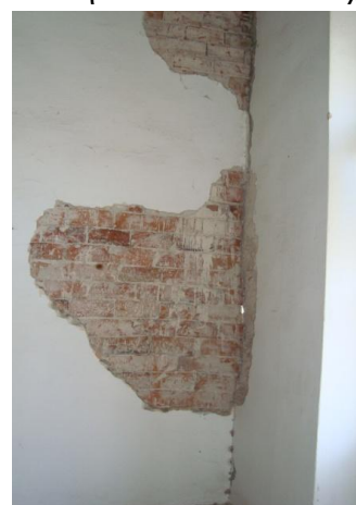
Π22. Αποκόλληση λιθοδομής με διάτρητη οπτοπλινθοδομή. Χώρος 304
