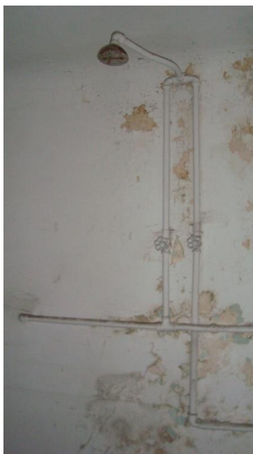
Εικόνα 45. Επιτοίχια σωλήνωση για ύδρευση στο λουτρό του ισογείου.
