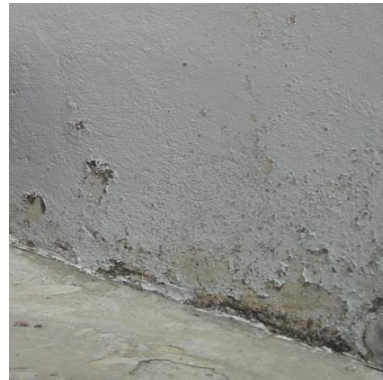
Εικόνα 92 Αποσάθρωση εξωτερικού επιχρίσματος
