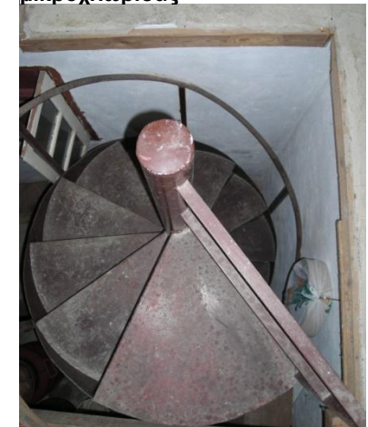
Εικόνα 96 Οξείδωση της μεταλλικής κλίμακας
