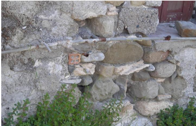
Εικόνα 88 Τοπική αποδιοργάνωση λιθοδομής, ΒΔ όψη
