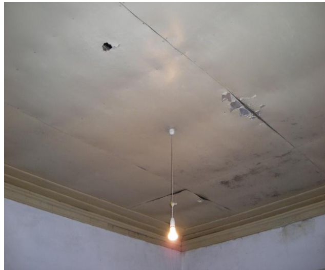
Εικόνα 97 Παραμόρφωση οροφής στον όροφο
