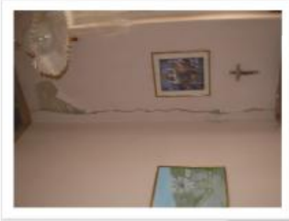
ΦΩΤΟΓΡΑΦΙΕΣ 41, 42 Αποφλοίωση και ρηγματώσεις στους τοίχους
