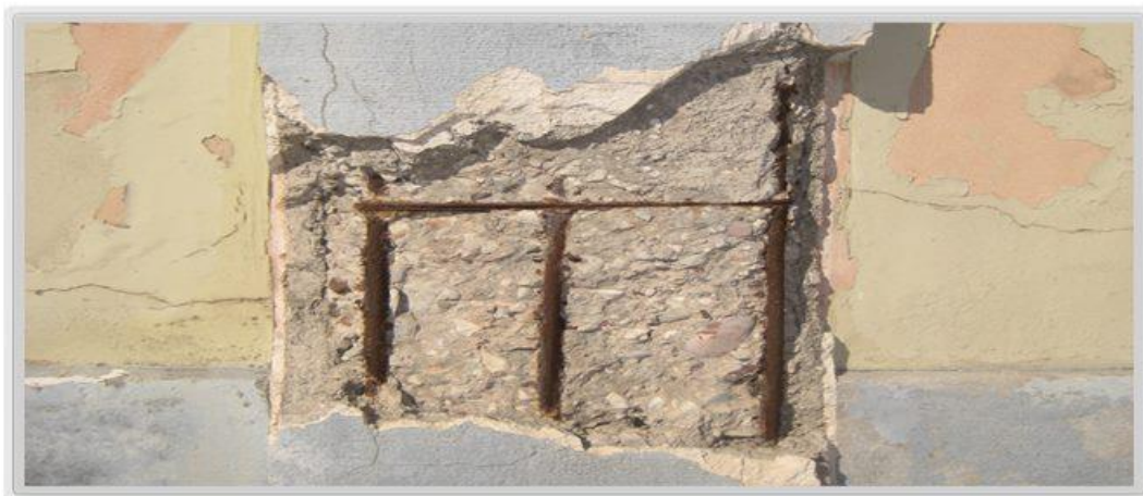
Εικόνα 29 αποσάθρωση σκυροδέματος και εμφάνιση οπλισμού
