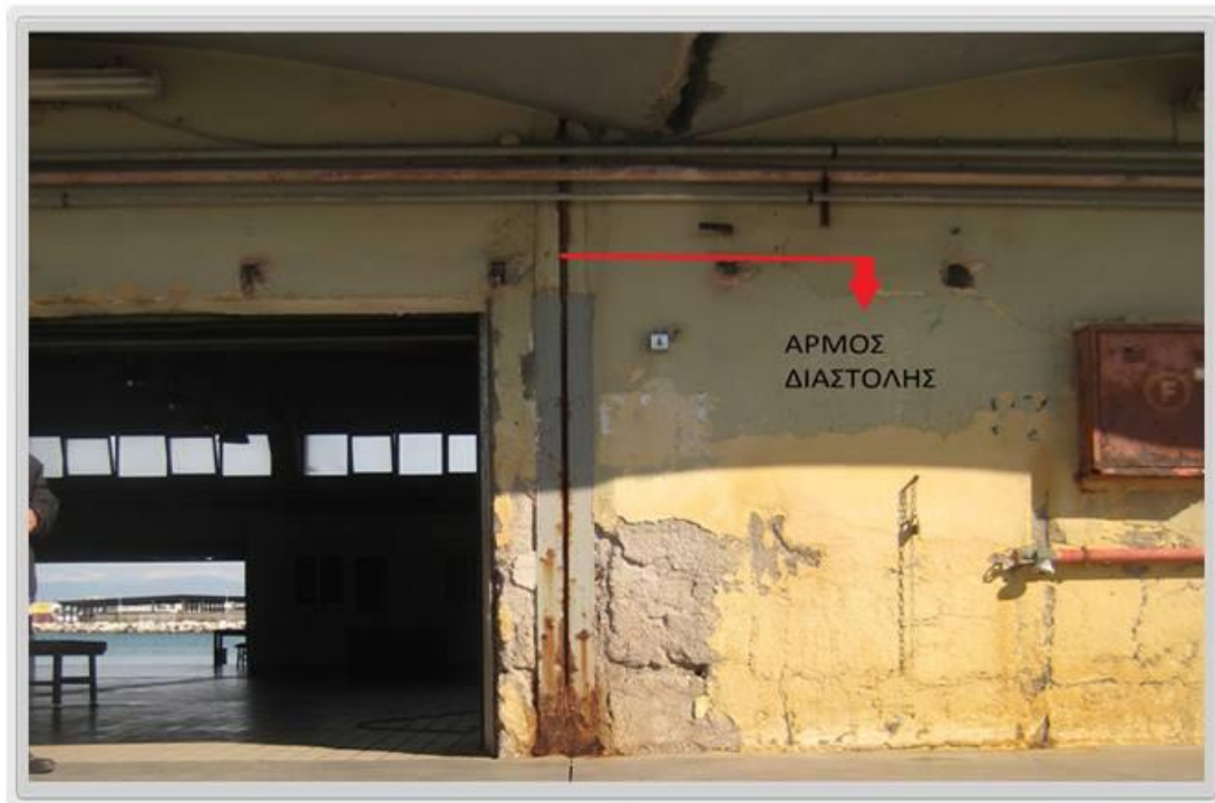
Εικόνα 17 Ένα μέρος από αρμό διαστολής του κτιριακού συγκροτήματος
