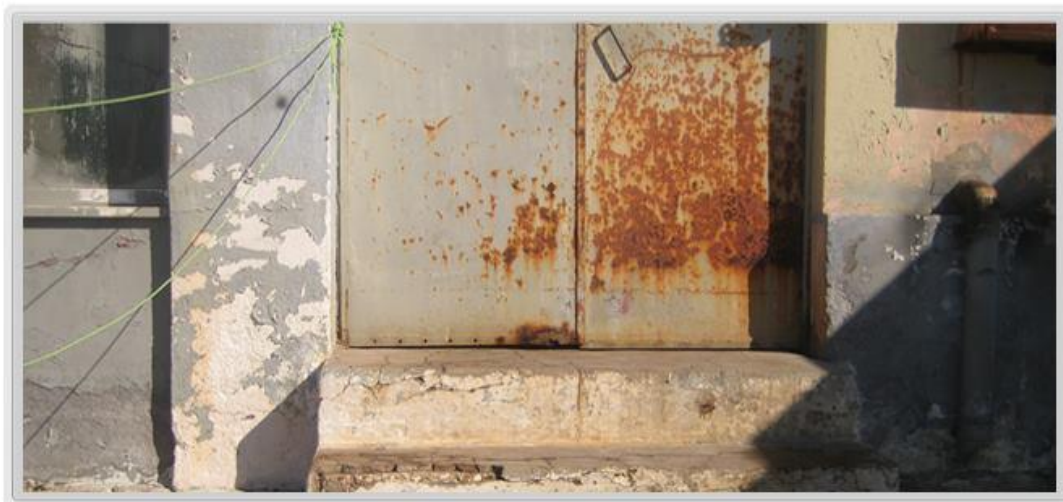
Εικόνα 32 Οξείδωση σιδερένιου κουφώματος
