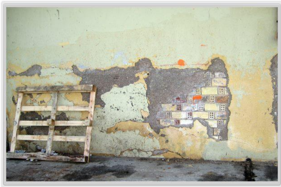
Εικόνα 21 Αποκόλληση κονιάματος και εμφάνιση εξωτερικής τοιχοποιίας
