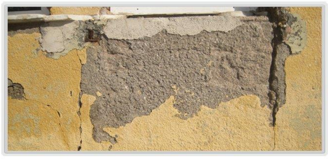
Εικόνα 23 Αποκόλληση αβεστοκονιάματος και εμφάνιση τσιμεντοκονιάματος
