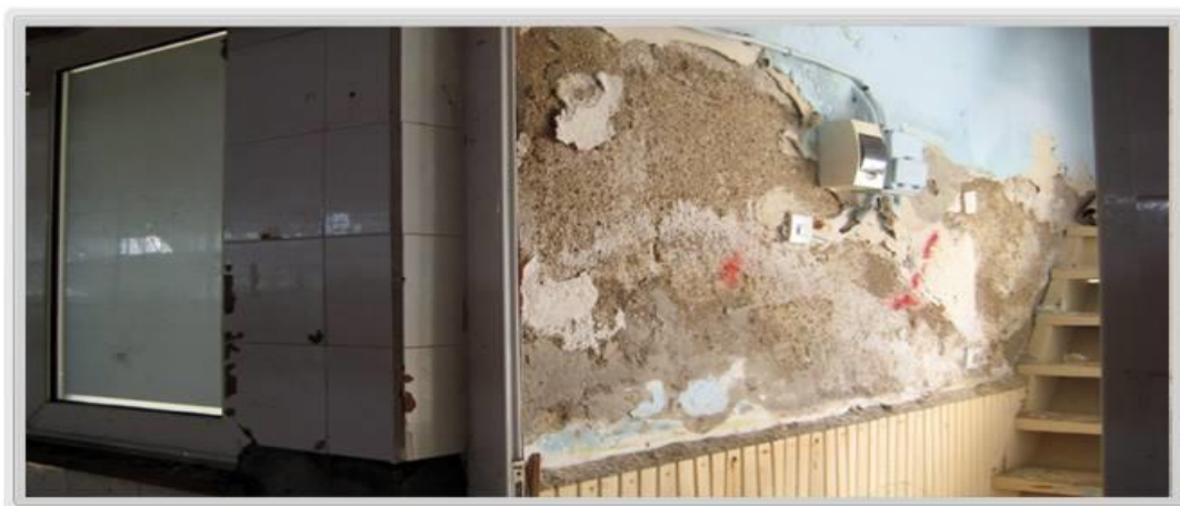
Εικόνα 30 Αποσάθρωση και αποκόλληση κονιάματος εσωτερικής τοιχοποιίας
