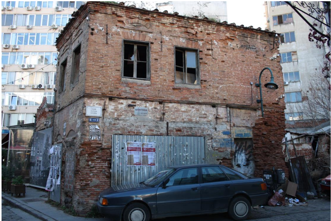
Εικόνα 4.3.1: Εγκαταλελειμμένο κτίσμα επί της οδού Αιγύπτου.
