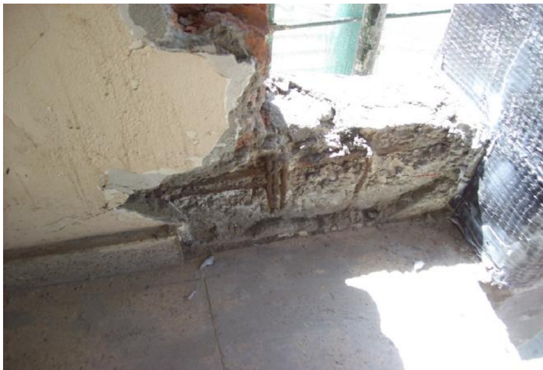
Εικόνα 7.2.8 Αποδιοργάνωση σκυροδέματος σε τείχος με εμφάνιση οπλισμών
