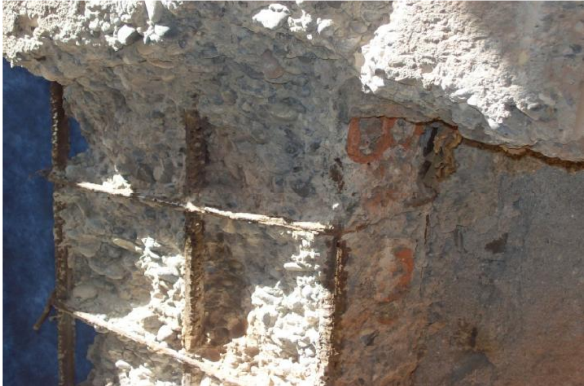
Εικόνα 7.2.7 Αποδιοργάνωση σκυροδέματος με εμφάνιση οπλισμών
