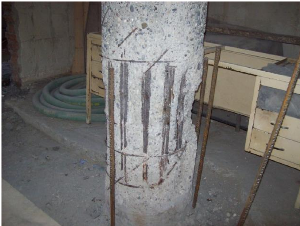
Εικόνα 7.2.4 Αποδιοργάνωση σκυροδέματος με εμφάνιση οπλισμού
