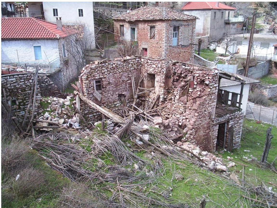
Φωτ.10: Κατάρρευση στέγης, πατώματος και τοιχοποιίας στο εσωτερικό της οικίας.
