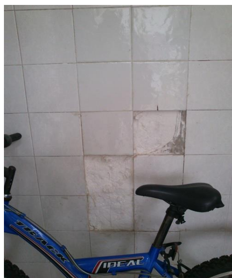
109. Αποκόλληση κεραμικών πλακών κτήριο 2
