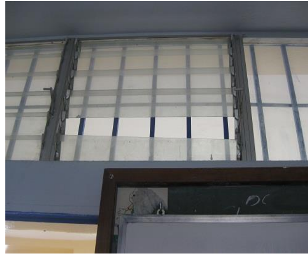
129. Κατεστραμμένα υαλοστάσια α' ορόφου κτήριο 1
