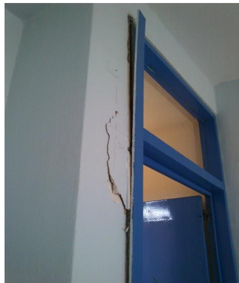
76. Ρωγμή σε σοβά υποστυλώματος
