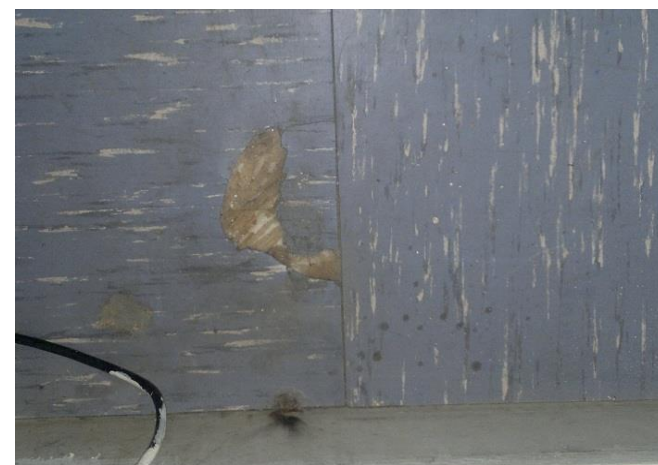
86. Αποκόλληση επένδυσης δαπέδου
