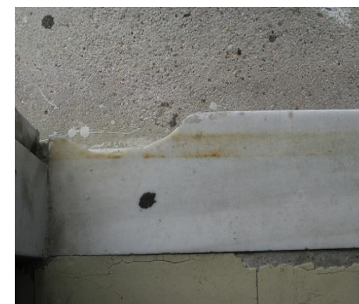
91. Αποκόλληση μαρμάρινου τμήματος κτήριο 3
