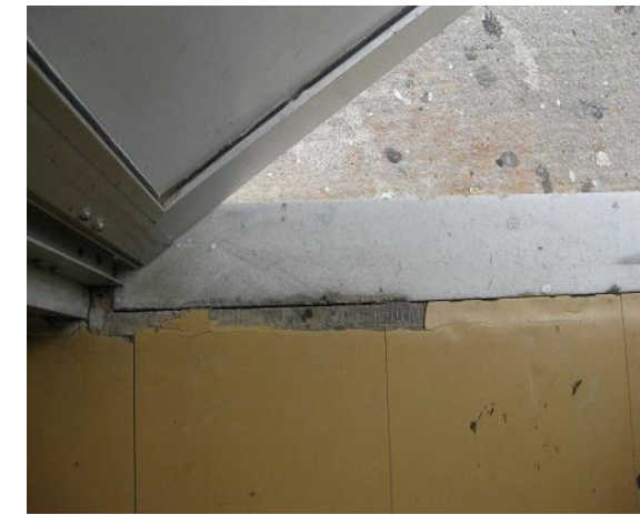
90. Αποκόλληση επένδυσης δαπέδου κτήριο 3
