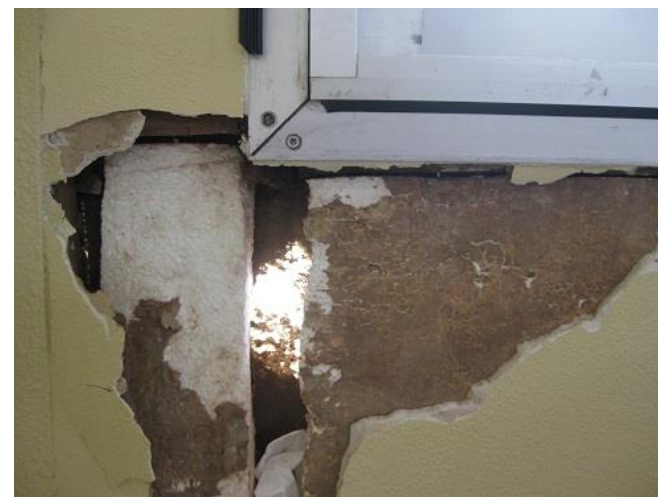
113. Αποκόλληση επιχρίσματος και τμηματική κατάρρευση τοιχοποιίας κτήριο 4
