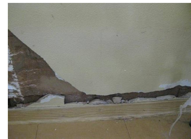
116. Αποκόλληση επιχρίσματος κτήριο 4
