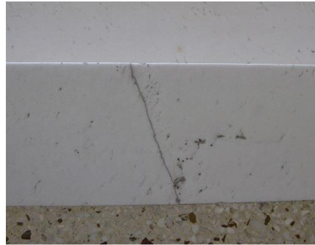
143. Ρωγμές στα μαρμάρινα πλακάκια
