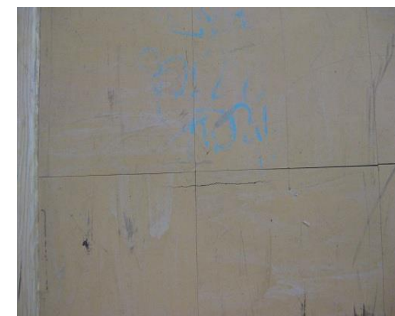
92. Ρωγμές στο δάπεδο κτήριο 3
