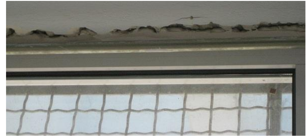
77. Ρωγμή σε οριζόντιο φορέα
