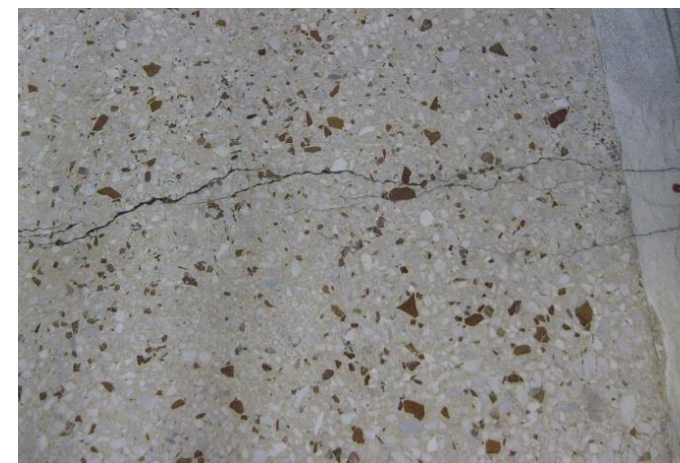
79. Ρωγμή στο δάπεδο
