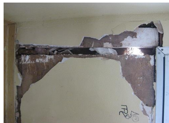
115. Τμηματική κατάρρευση τοιχοποιίας κτήριο 4
