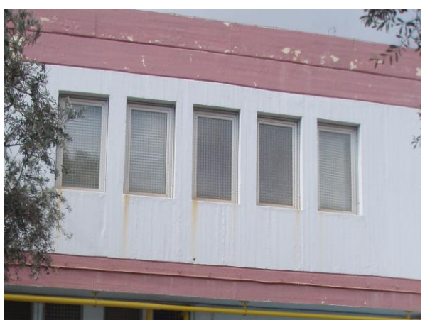
121. Αποχρωματισμός τοιχοποιίας κτήριο 1
