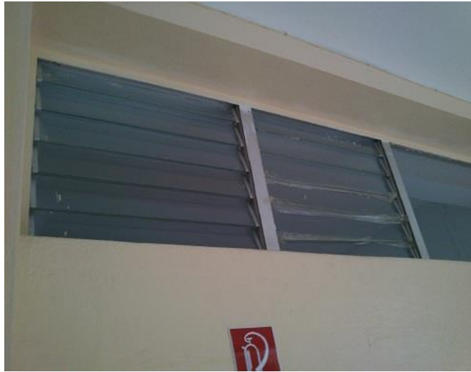
128. Κατεστραμμένα υαλοστάσια διάδρομος α' ορόφου κτήριο 1
