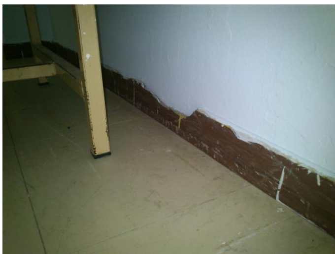
111. Κατεστραμμένα σοβατεπί κτήριο 3
