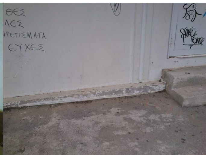
112. Αποφλοίωση χρώματος κτήριο 3
