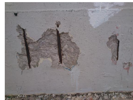
117. Απογύμνωση οπλισμού κτήριο 4
