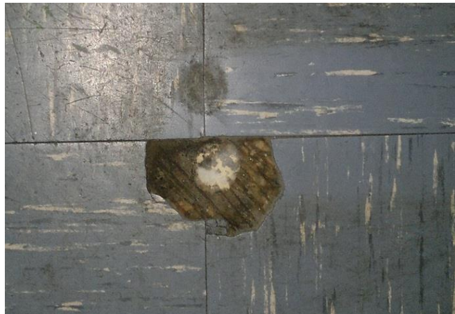
83. Αποκόλληση επένδυσης δαπέδου
