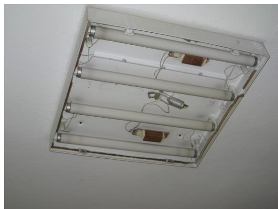
53. Φωτιστικά διαδρόμου κτηρίου
