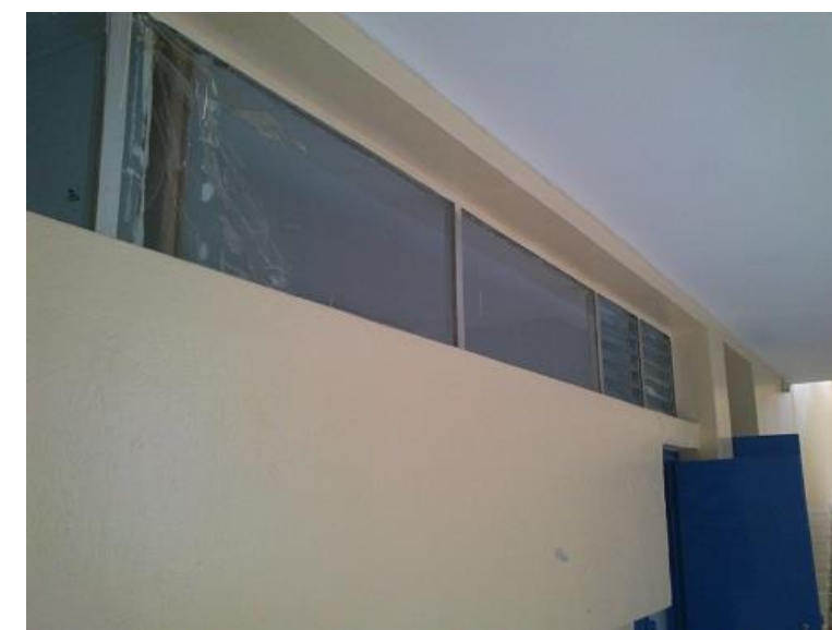
127. Κατεστραμμένα υαλοστάσια α' ορόφου κτήριο 1
