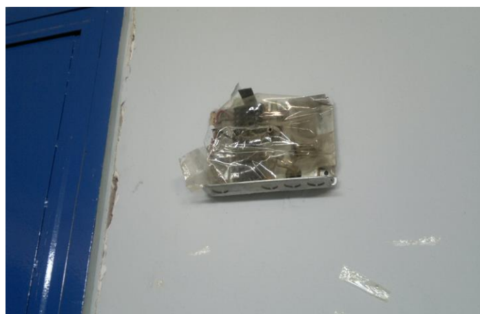
155. Εγκατάσταση συναγερμού εκτός λειτουργίας
