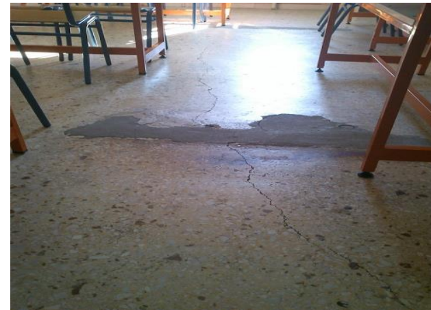
84. Ρωγμή στο δάπεδο, και ανθρώπινη παρέμβαση
