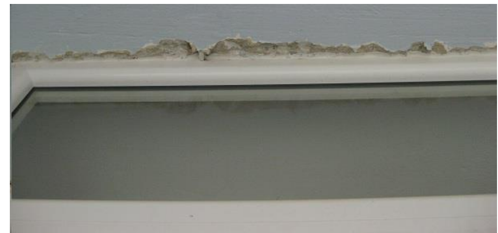
78. Ρωγμή σε οριζόντιο φορέα
