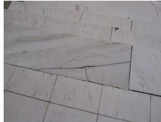
144. Ρωγμές στα μαρμάρινα πλακάκια
