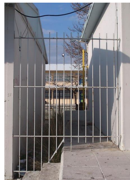
63. Λευκό μεταλλικό κιγκλίδωμα κτήριο 4, 5
