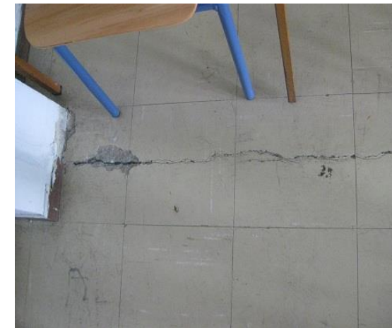
89. Ρωγμή στο δάπεδο κτήριο 3
