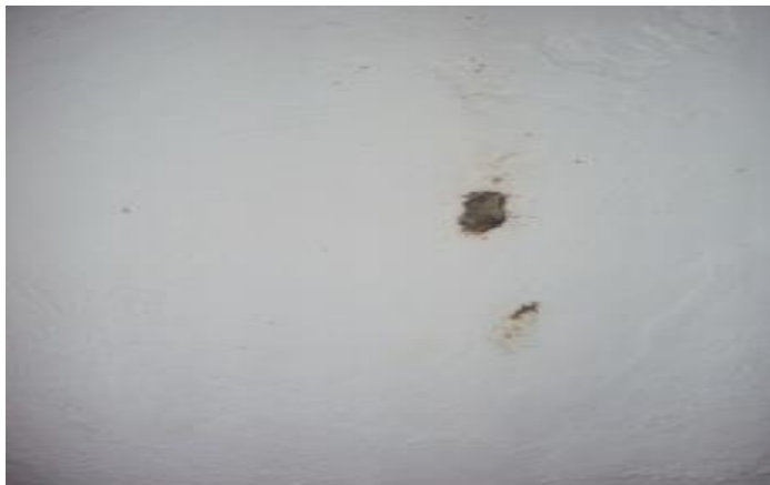
| 17.Φουσκώματα στο επίχρισμα Ανάπτυξη βρύων και σκασίματα στο χρωματισμό
