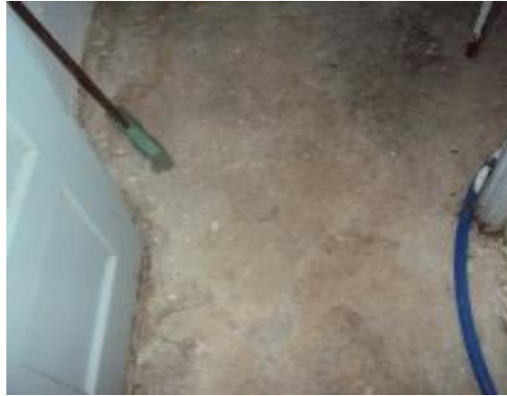
| 22. Δάπεδο υπογείου χωρίς πλακόστρωση
