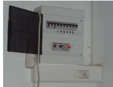
| 51. Νέος ηλεκτρικός πίνακας
