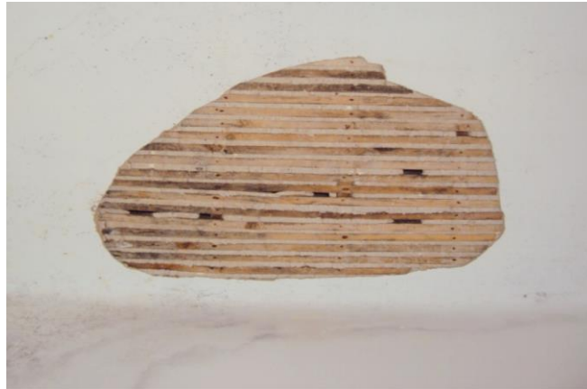
| 20. Τμηματική πτώση του επιχρίσματος της οροφής και αποκάλυψη του μπαγδατιού
