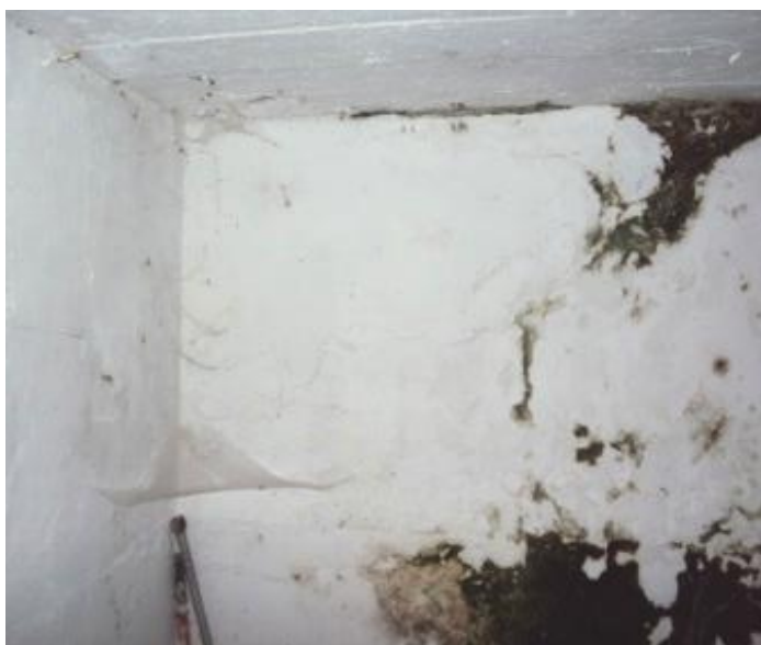
| 18.Φουσκώματα στο επίχρισμα Ανάπτυξη βρύων και σκασίματα στο χρωματισμό
