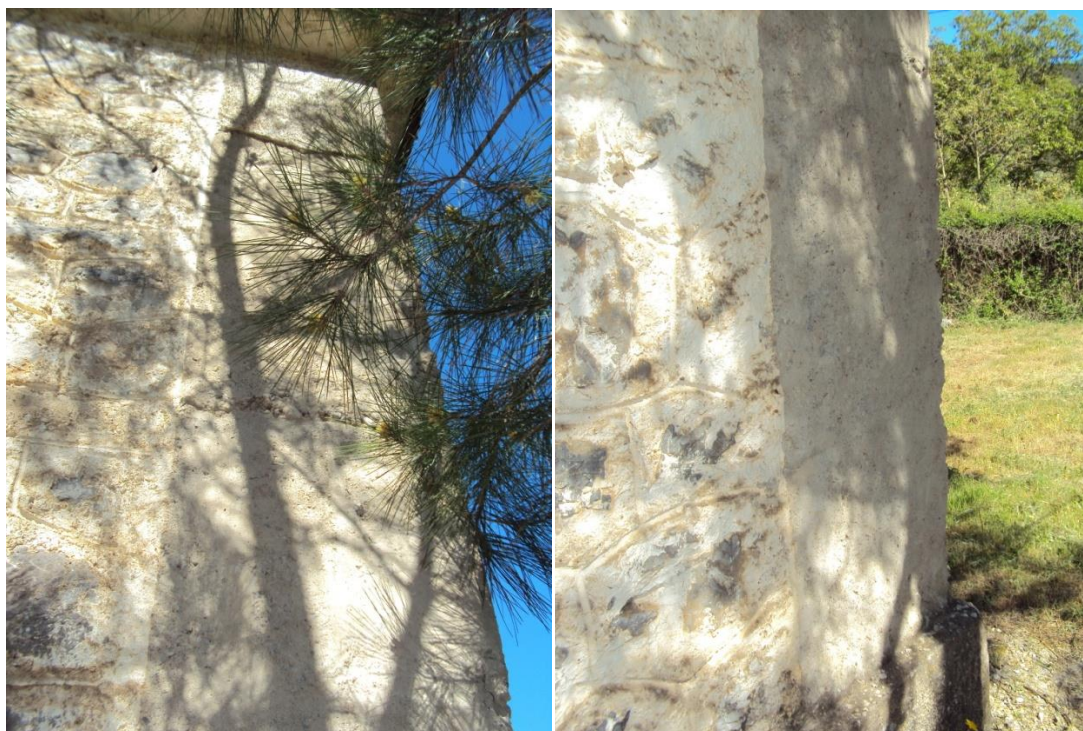
| εικ.64,65. Αποκάλυψη του σπλισμένου σκυροδέματος σε πεσσό της Βορειοανατολικής Όψης
