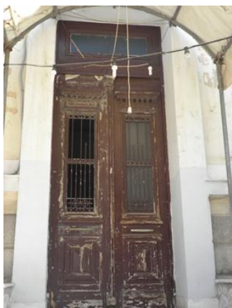
Εικόνα 76 αποφλοίωση χρώματος στο κούφωμα της κεντρικής εισόδου
