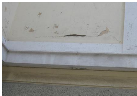
Εικόνα 77 απλή ρηγμάτωση σε εξωτερική τοιχοποιία
