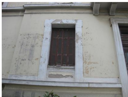
Εικόνα 78 αποφλοίωση και κατάρρευση επιχρίσματος όψης
