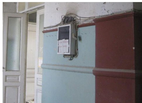
Εικόνα 68 πίνακας στον διάδρομο του α' ορόφου
