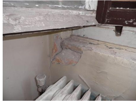
Εικόνα 73 έντονη ρηγματώση-κατάρρευση επιχρίσματος
