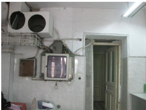
Εικόνα 67 πίνακας ηλεκτροδότησης, χώρος 010
