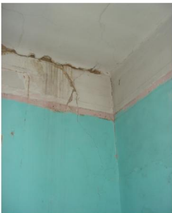
φωτ.124. Διαμπερή ρωγή
