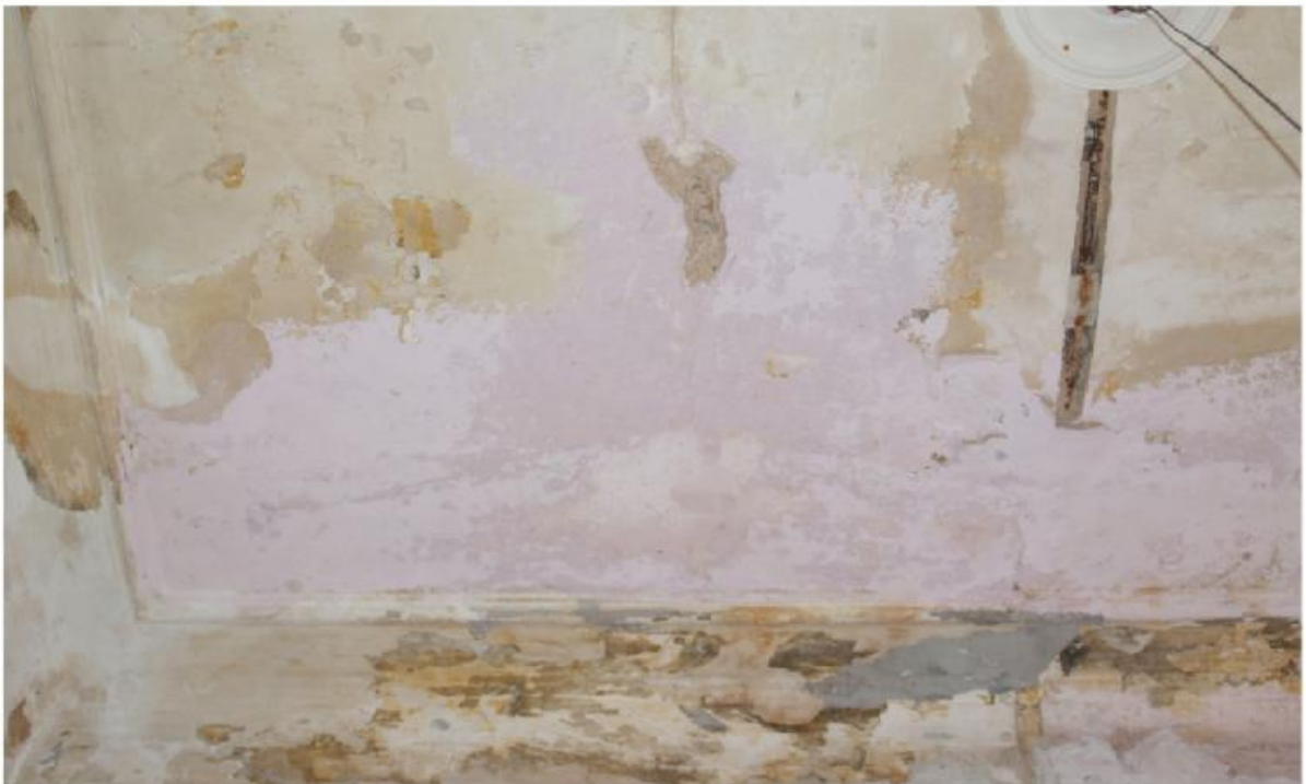
φωτ.192. Υγρασία και φθρές στην τοιχοποιία
