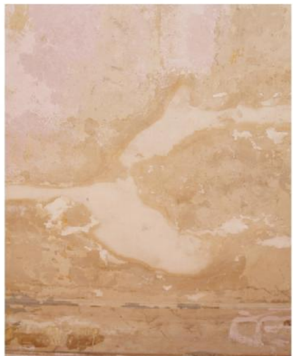
φωτ.190. Υγρασία σε οροφή
