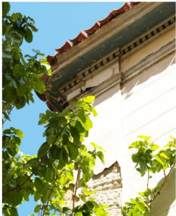
φωτ.105. Αποκόλληση κονιάματος
