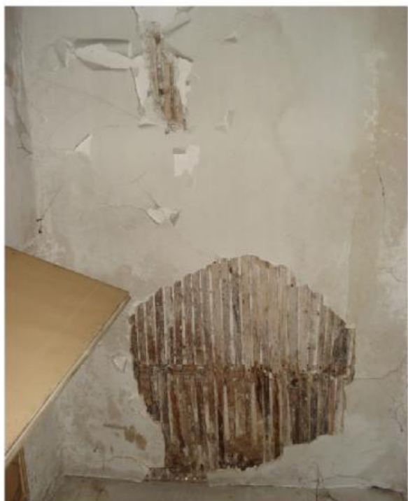
φωτ.170. Αποκόλληση επιχρίσματος οροφής
