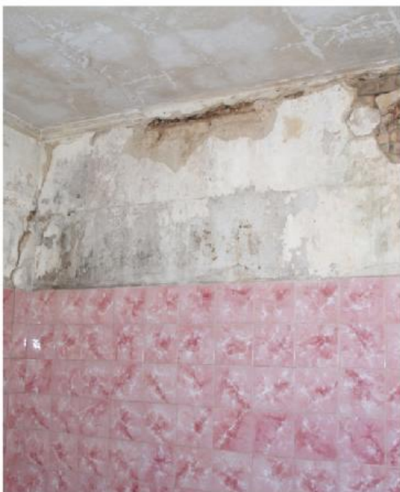
φωτ.173. Ρωγμές στην ένωση τοιχοποιίας οροφής
