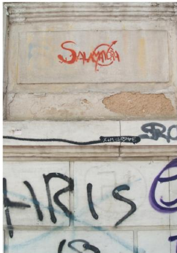
φωτ.9. Αποσάθρωση κονιάματος και ανθρωπογενείς ρύποι (γκραφίτι)
