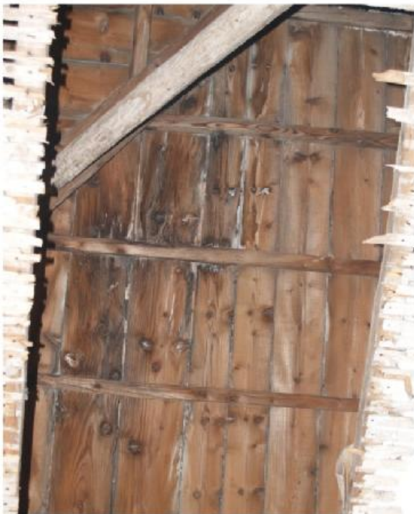
φωτ.154. Κιάρρευση οροφής
