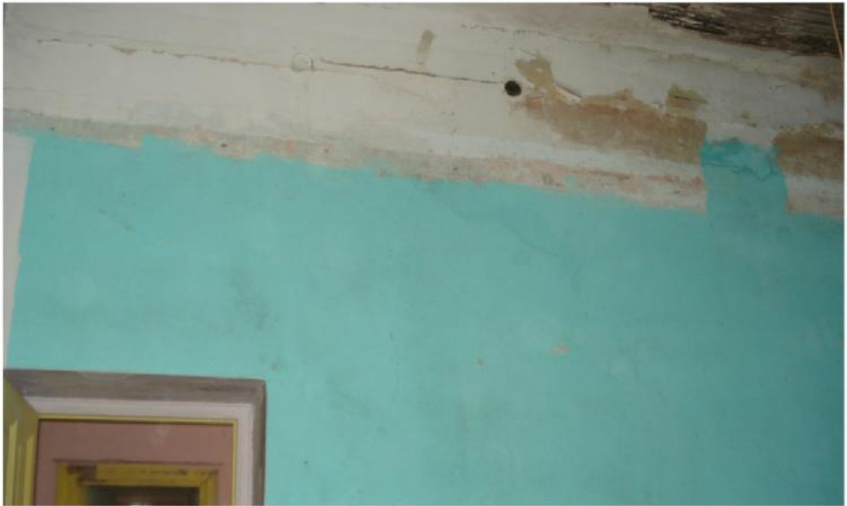
φωτ.121. Αποφλοίωση χρώματος
