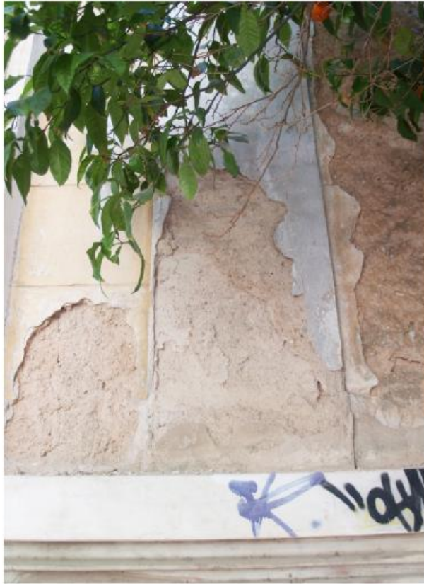
φωτ.15. Αποσάθρωση κονιάματος
