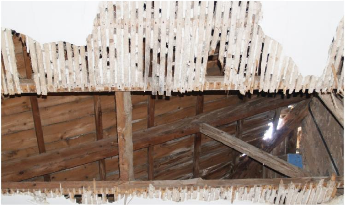
φωτ.156. Τρύπα στα ξύλα της στέγης
