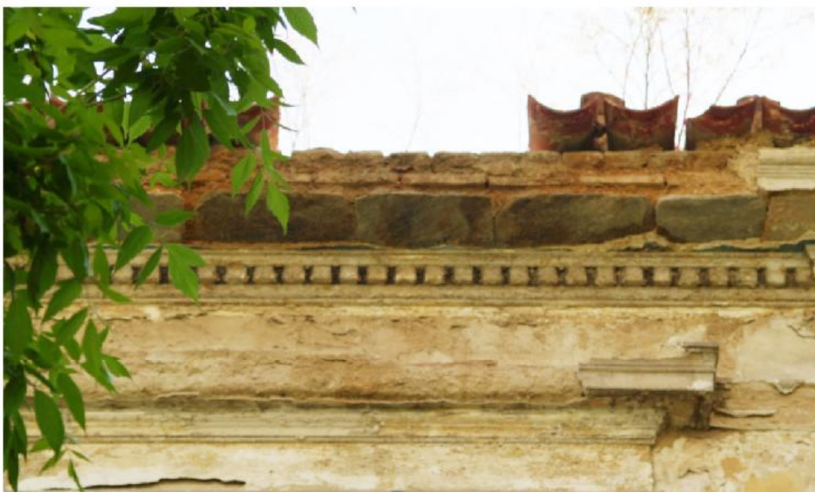
φωτ.97. Φθορές στο διάκοσμο της πρόσοψης
