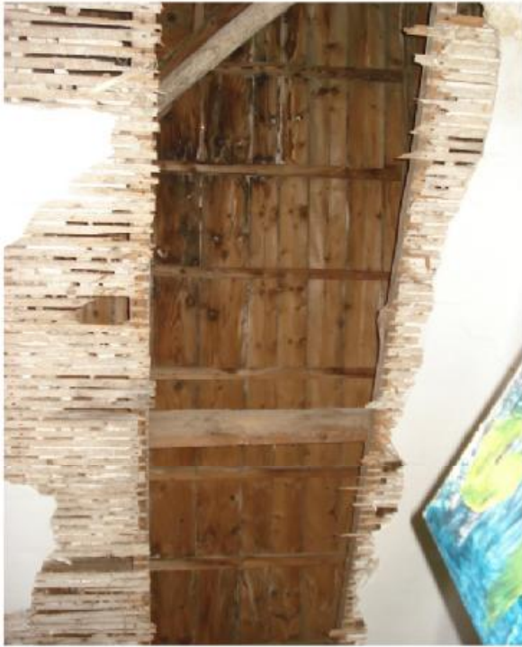
φωτ.152. Τρύπα στην οροφή του χώρου 2.5.
