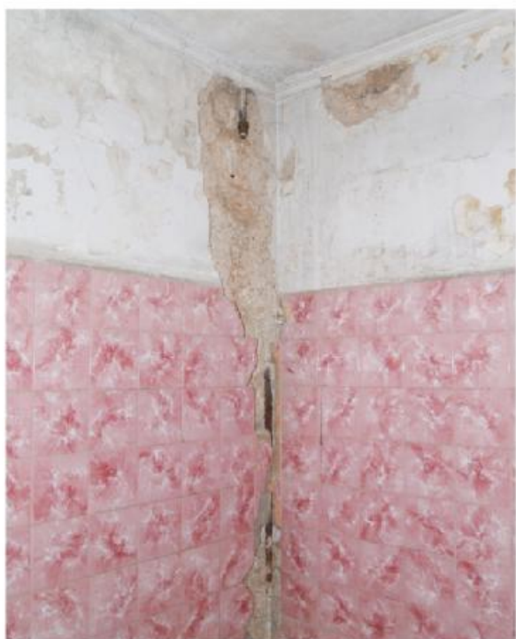
φωτ.172. Φθορά στην τοιχοποιία
