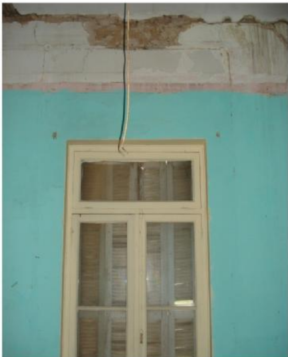
φωτ.122. Ρωγμή στην ένωση τοιχοποιίας οροφής
