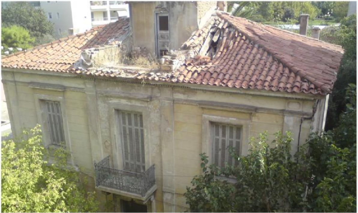
φωτ.94. Εμφανής τρύπα στη στέγη
