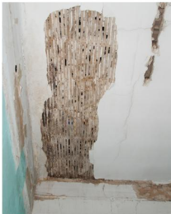
φωτ.127. Αποκόλληση επιχρίσματος
