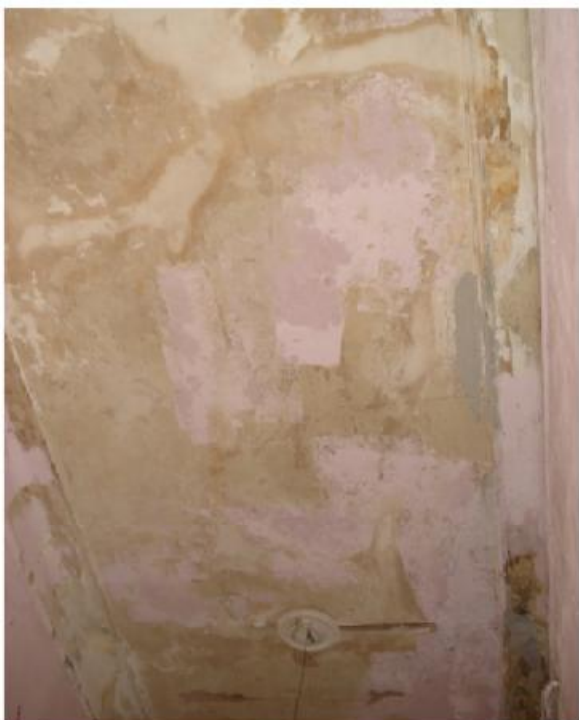
φωτ.193. Υγρασία στην οροφή του χώρου 2.6.
