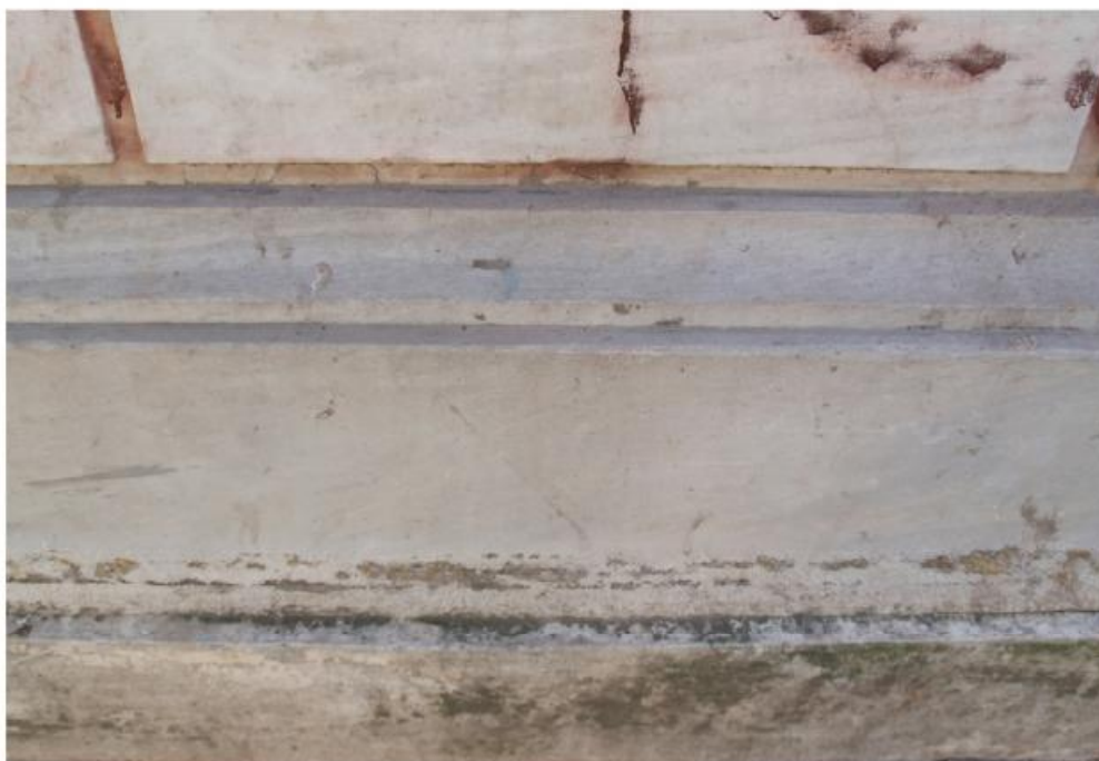
φωτ.32. Αναδυόμενη υγρασία από τα νερά της βροχής
