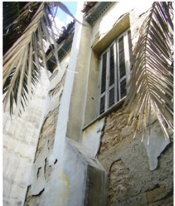
φωτ. 112. Αποσάθρωση και αποκόλληση κονιάματος
