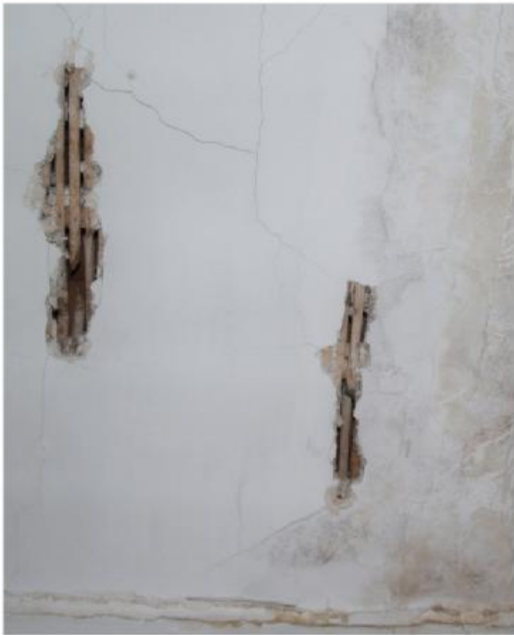
φωτ.141. Αποκόλληση επιχρίσματος οροφής
