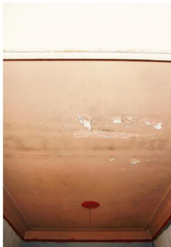
φωτ.72. Αποφλοιώση χρώματος οροφής της μεγάλης αίθουσας του ισογείου
