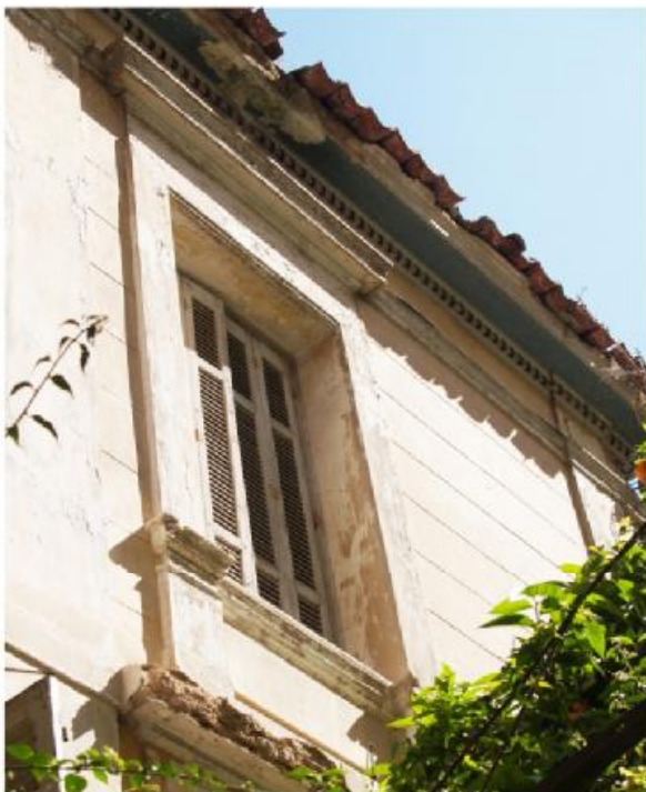
φωτ.104. Φθορά στο διάκοσμο της όψης
