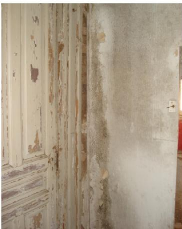
φωτ.167. Εμφανής υγρασία σε τοιχοπαία
