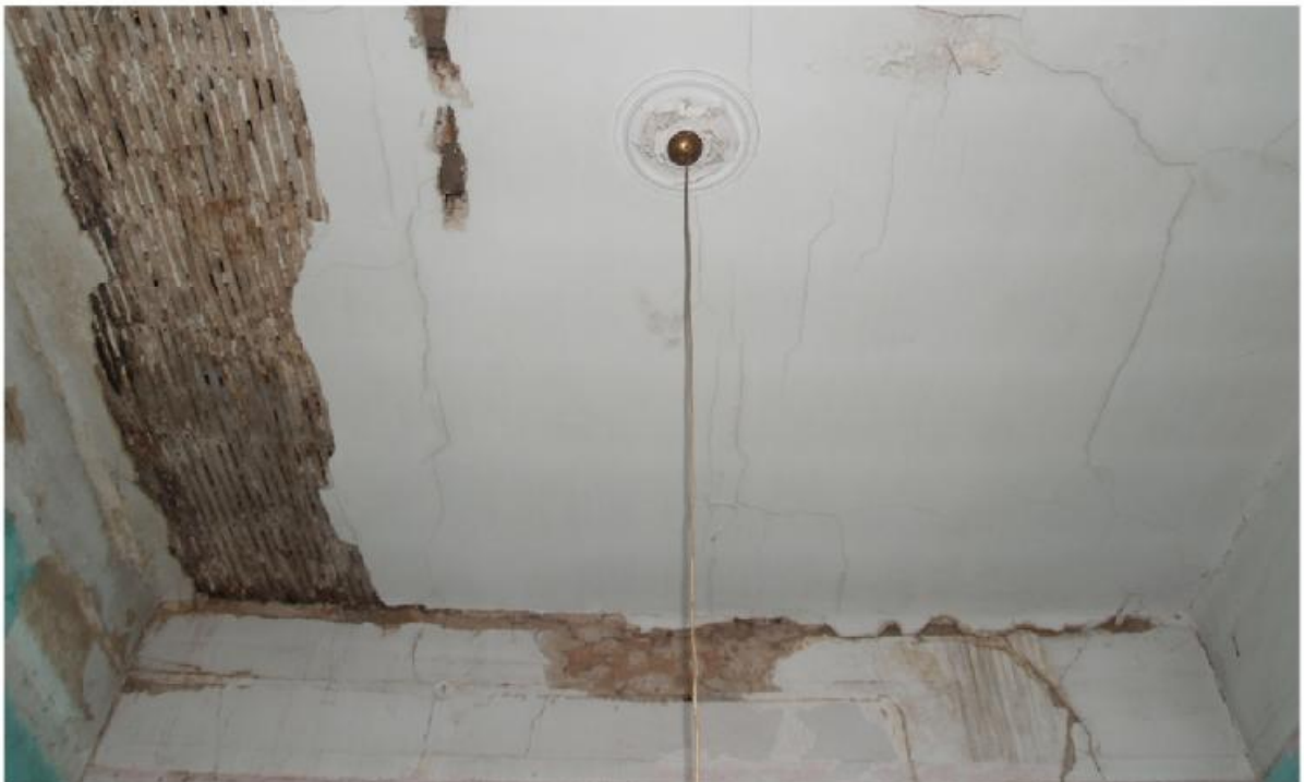
φωτ.129. Τριχαιδής ρωγμές στην οροφή
