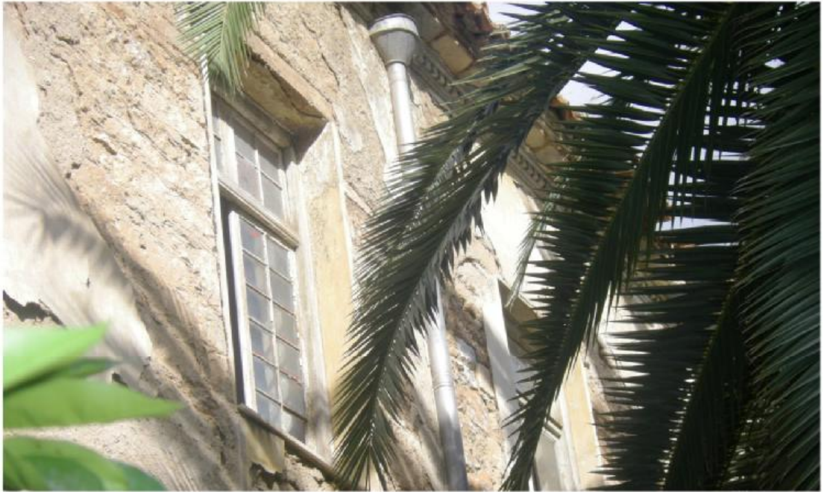
φωτ. 110. Αποσάθρωση κονιάματος
