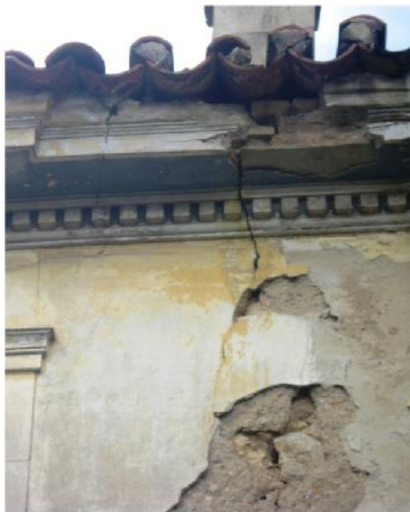
φωτ.114. Διαμπερή ρωγμή
