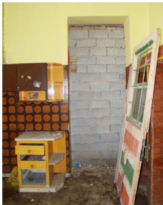
φωτ.57. Σφραγισμένο άνοιγμα
