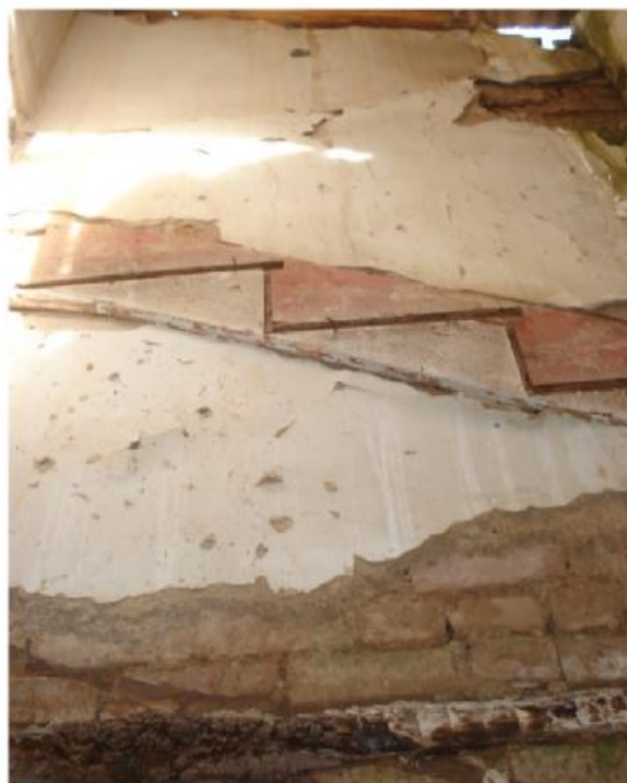
φωτ.183. Εμφανείς πλίνθοι και χλωρίδα σε τοιχοποιία
