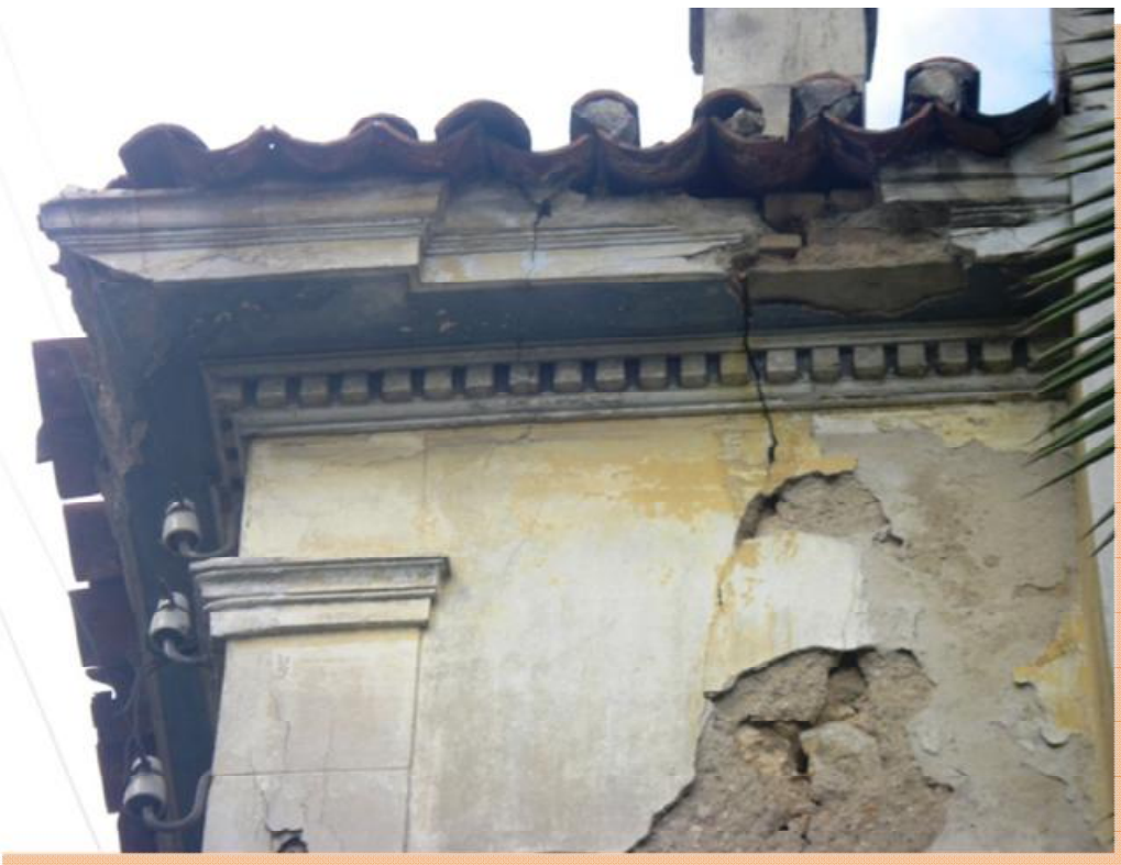
εικόνα 5: Διαμπερή ρωγμή στην ανατολική όψη
