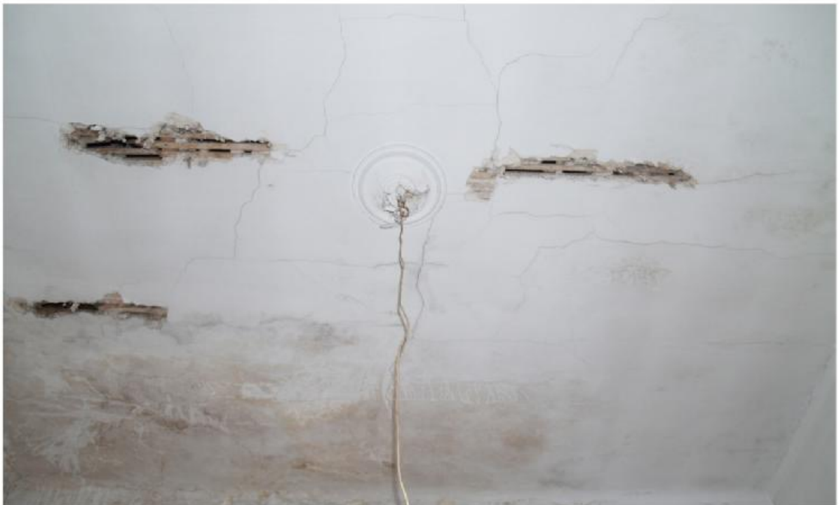
φωτ.140. Κύρτωση της οροφής στο χώρο 2.9.
