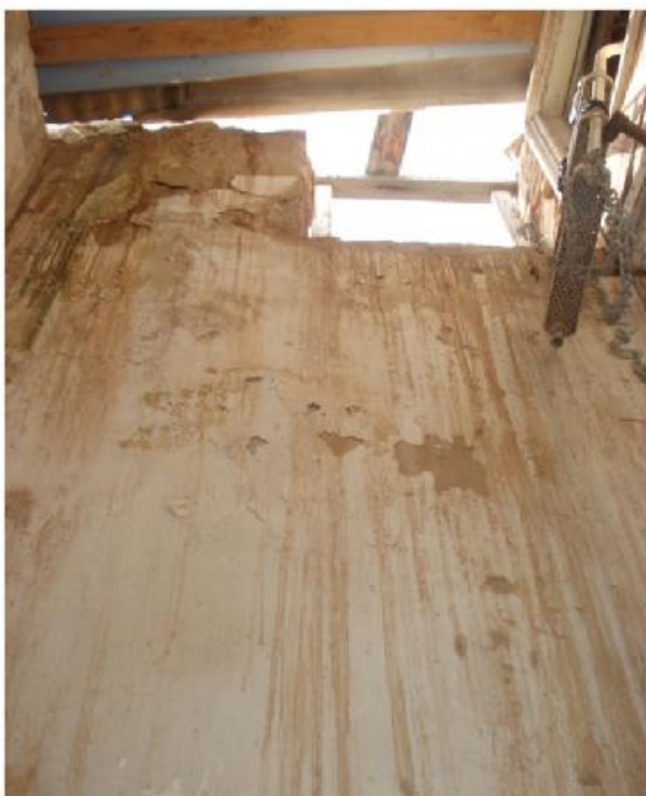
φωτ.182. Υγρασία στην τοιχοποιία
