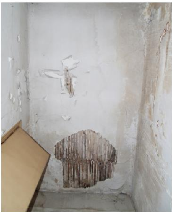
φωτ.169. Φθορά και υγρασία σε οροφή και τοιχοποιία
