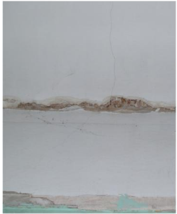
φωτ.142. Ρωγμές στην ένωση τοιχοποιίας οροφής
