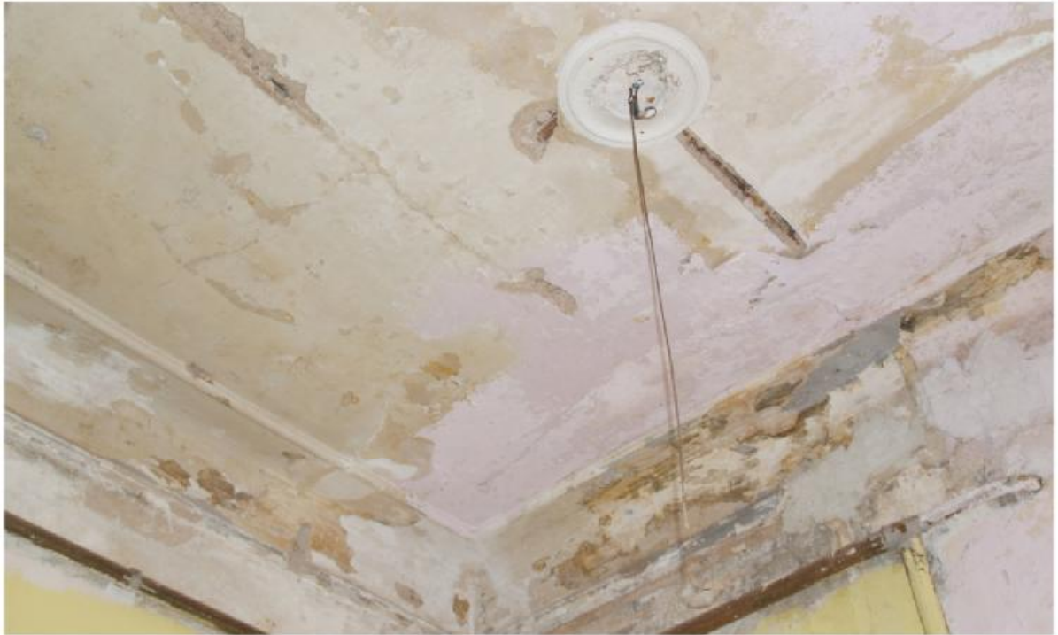
φωτ.191. Υγρασία και φθρές στην τοιχοποιία
