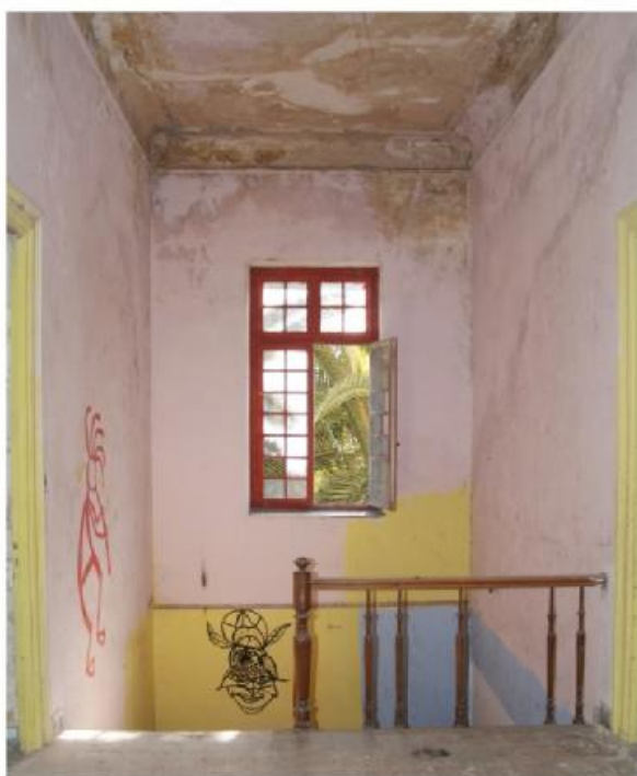
φωτ.186. Εμφανής υγρασία σε οροφή και τοιχοποιία
