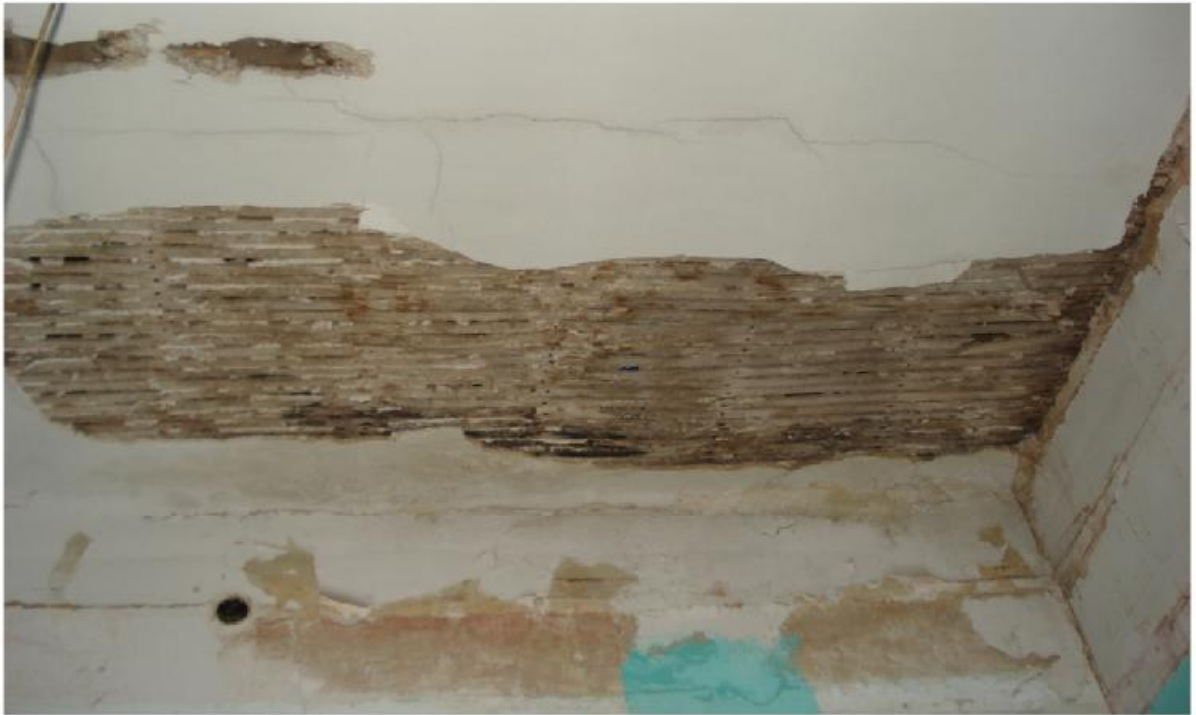
φωτ.128. Φθορές στις ενώσεις τοιχοποιίας οροφής
