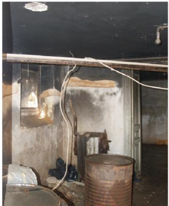
φωτ.202. Παραθύρου Α.0.2.-αιθάλη σε τοιχοποιία οροφή
