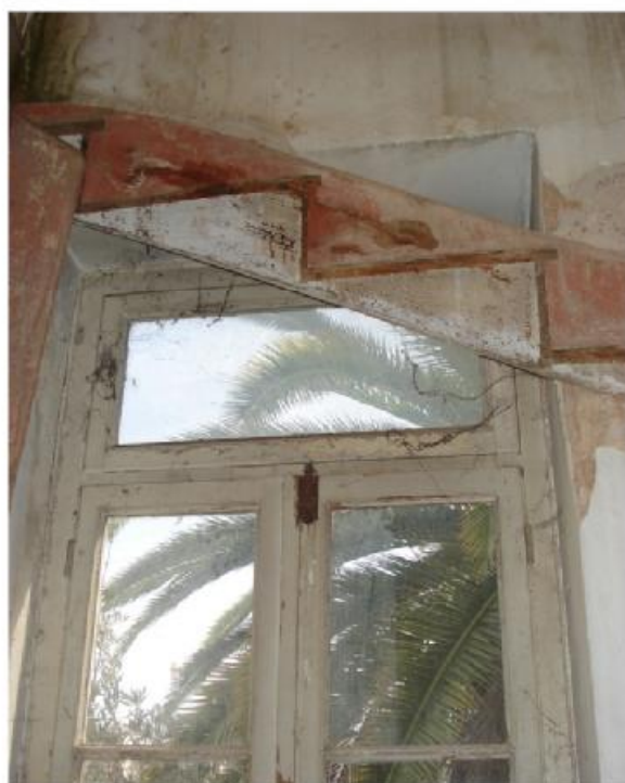
φωτ.176. Ίχνη στο βαθυδοφόρο
