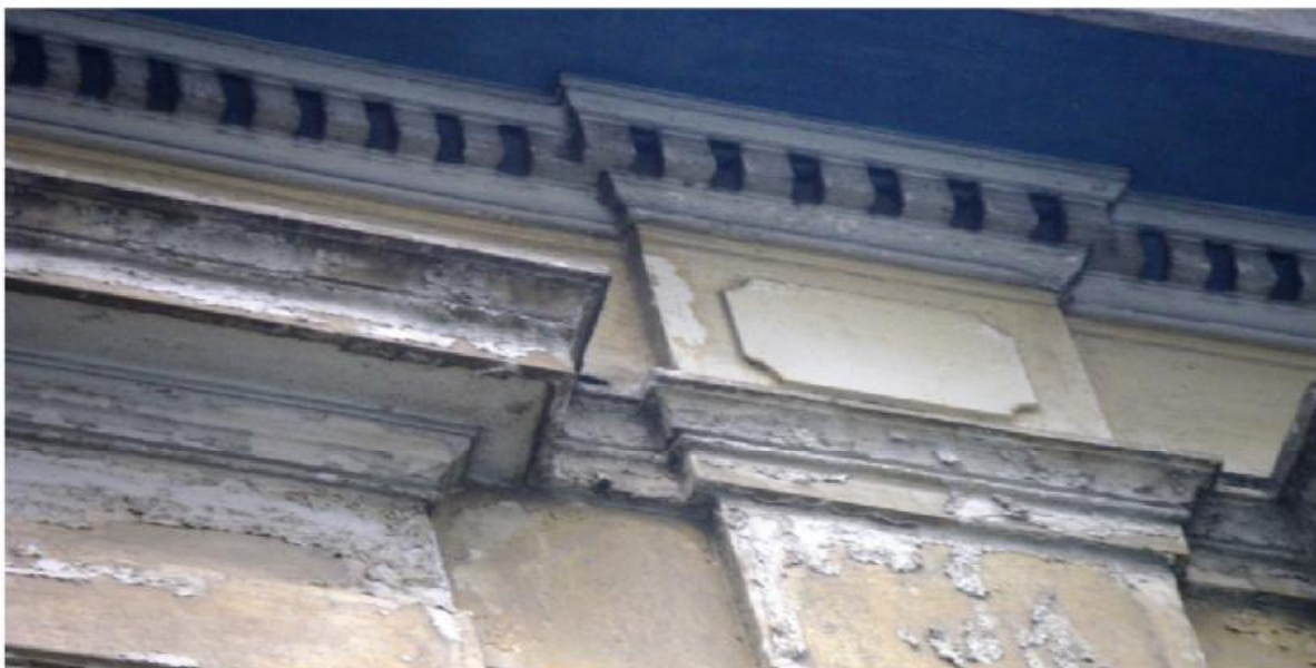
φωτ.107. Σταγόνες κάτω από τη στέγη
