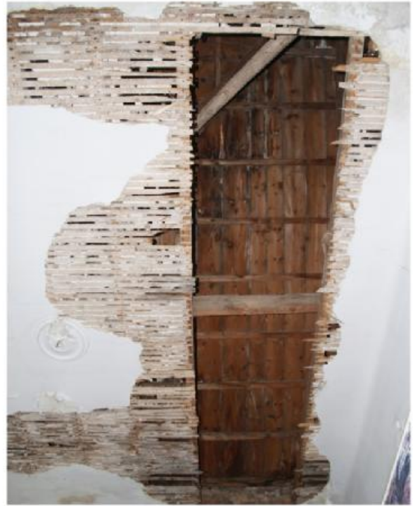
φωτ.153. Κατάρρευση οροφής
