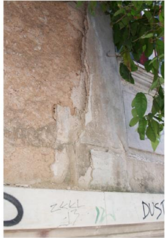
φωτ.16. Αποσάθρωση κονιάματος
