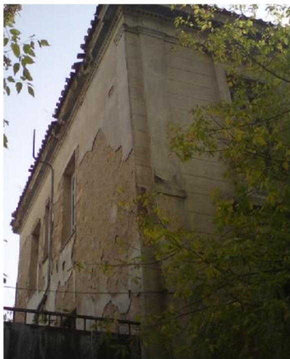
φωτ.118. Φθορές στη βόρεια όψη
