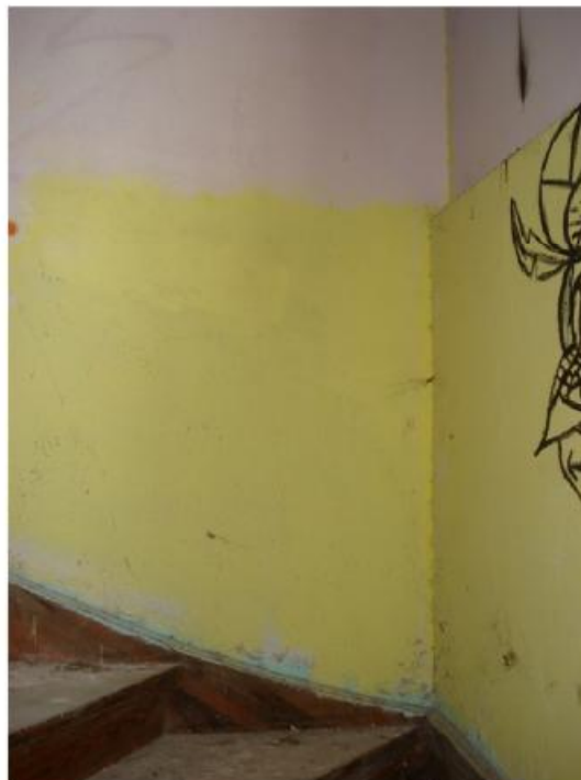
φωτ.93. Διαφορά στο πάχος τοίχου ισόγειου - ορόφου
