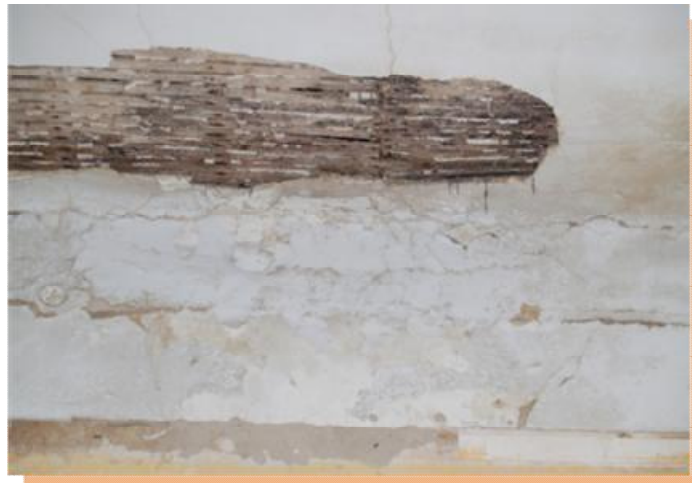
εικόνα 7: Υγρασία και ρωγμές στην ένωση της τοιχοποιίας με την οροφή
