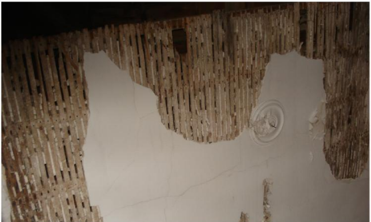
φωτ.157. Αποκόλληση επιχρίσματος οροφής
