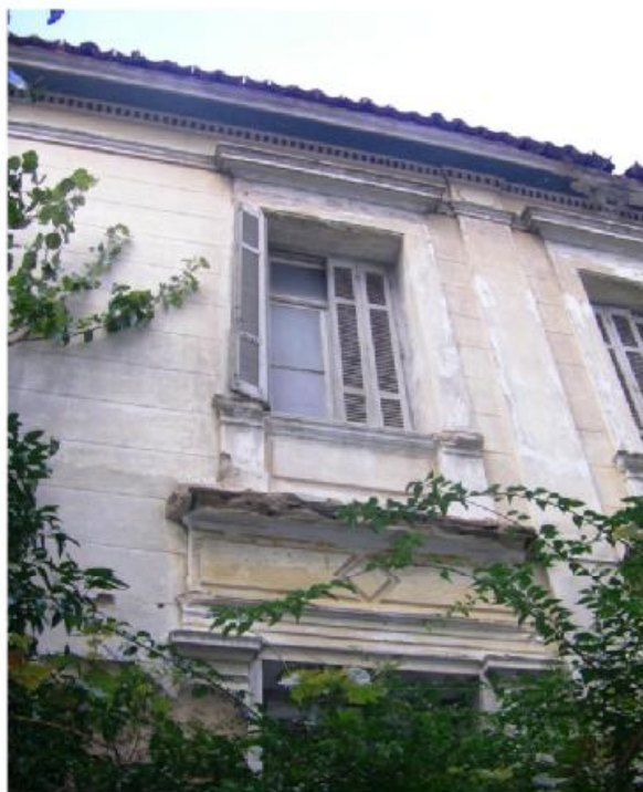
φωτ.101. Φθορά στο διάκοσμο της όψης
