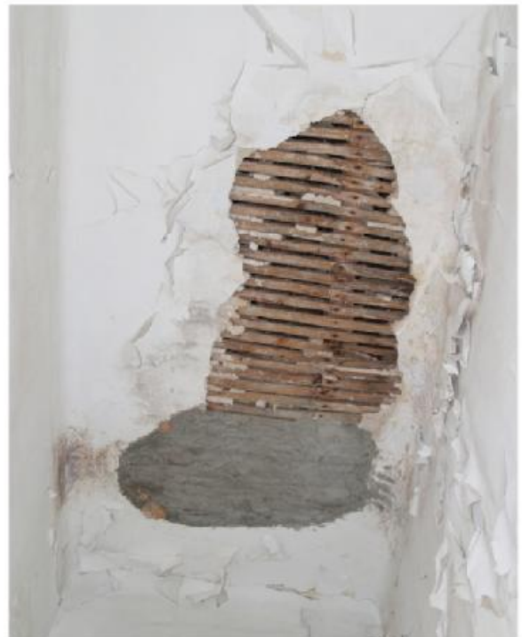
φωτ.164. Οροφή w.c.
