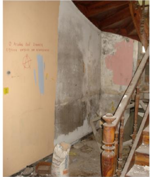
φωτ.92. Υγρασία στον τοίχο κάτω από τη σκάλα
