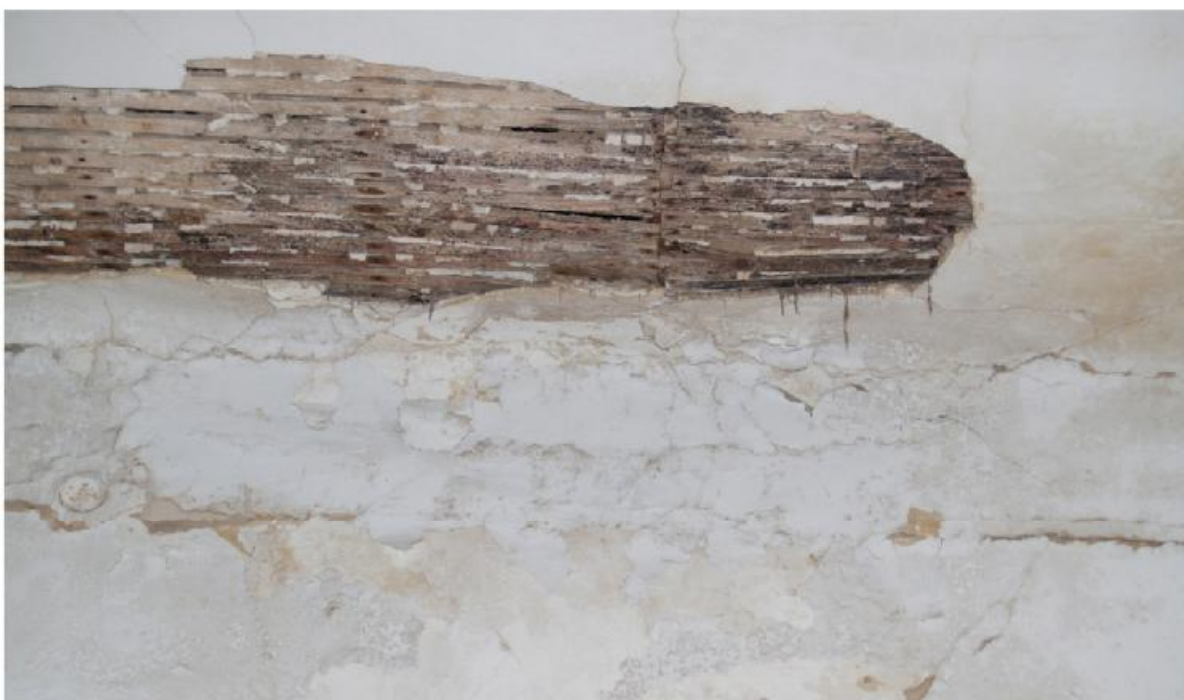
φωτ.159. Φθορές σε οροφή από μπαγδατί
