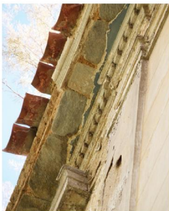
φωτ.98. Φθορά στο γείσο της στέγης
