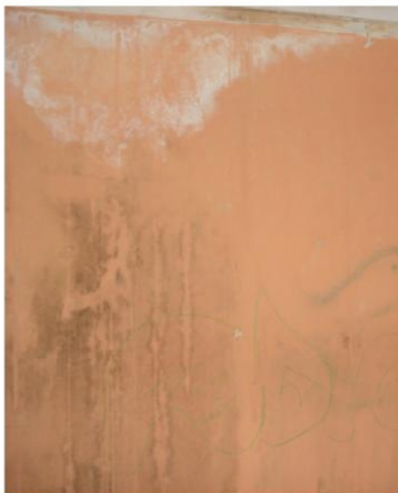
φωτ. 133. Εμφάνιση υγρασίας
