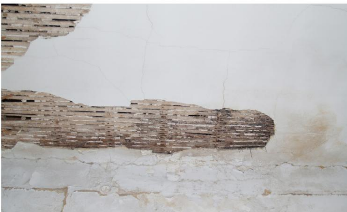
φωτ.160. Αποκόλληση επιχρίσματος σε οροφή από μπαγδατί
