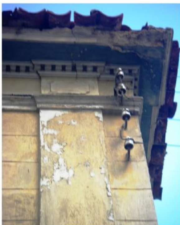
φωτ.108. Αποσάθρωση κονιάματος
