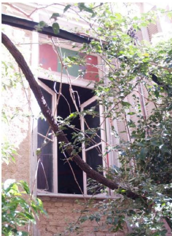
φωτ.21. Παράθυρο νότιας όψης και απόπλυση κονιάματος δομής
