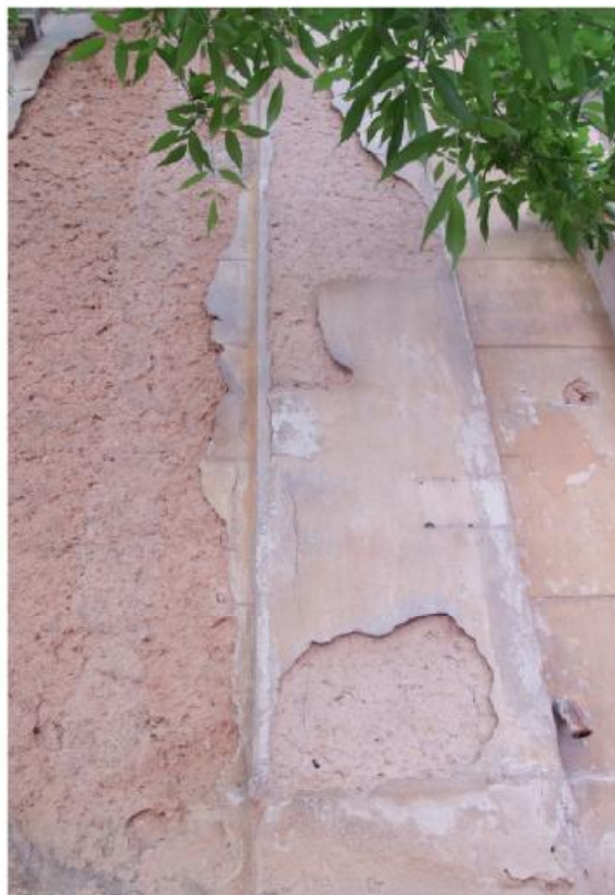
φωτ.12. Αποσάθρωση κονιάματος
