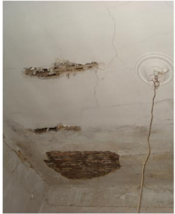
φωτ.139. Κύρτωση της οροφής στο χώρο 2.9.
