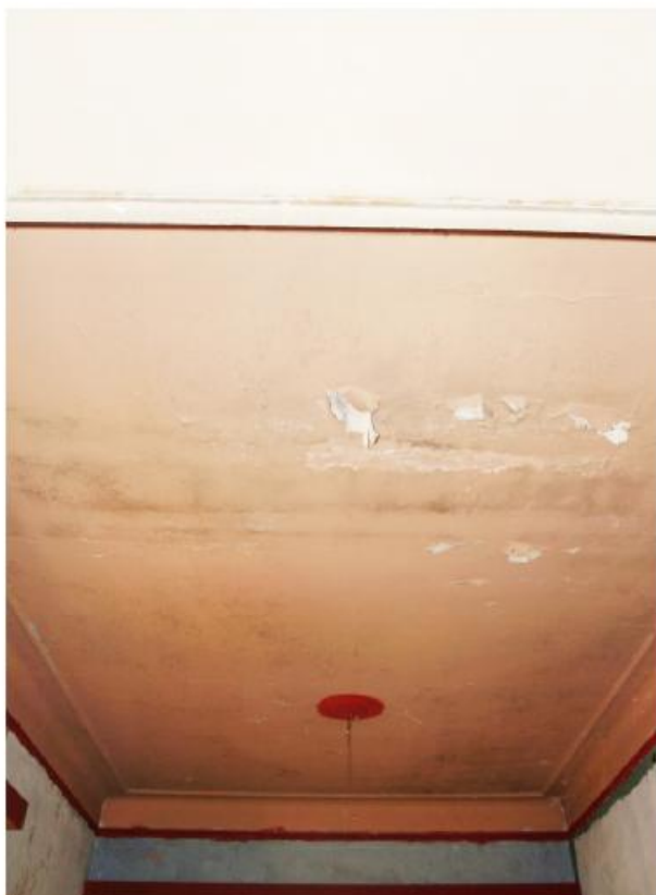
φωτ.71. Αποφλοιώση χρώματος οροφής της μεγάλης αίθουσας του ισογείου
