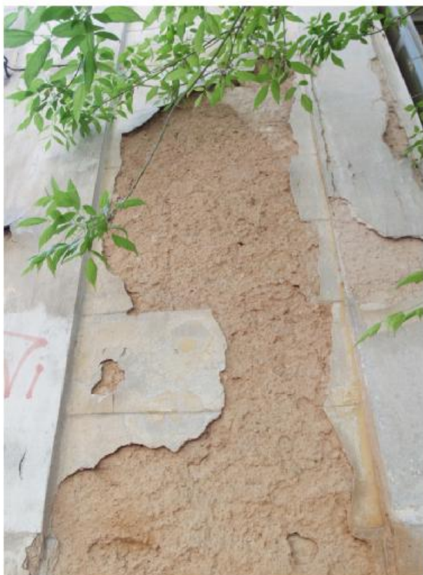
φωτ.11. Αποσάθρωση κονιάματος
