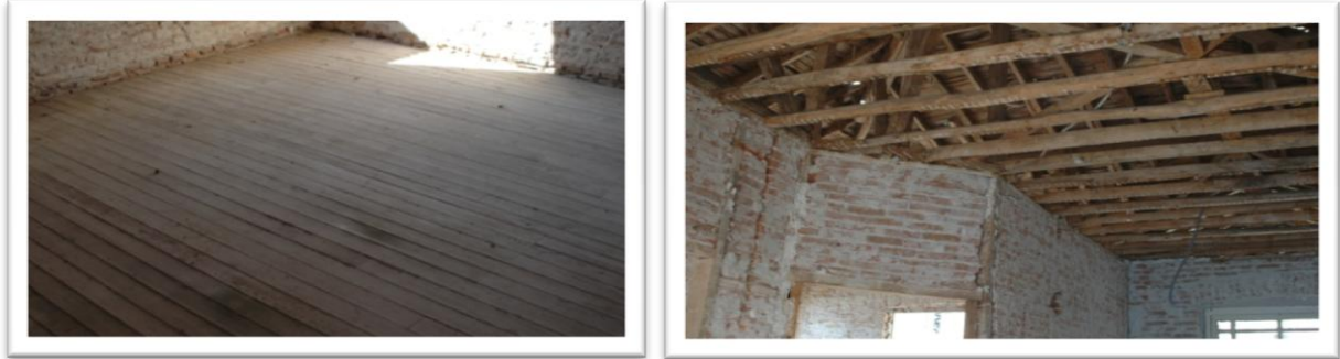
Εικ.3,4 Υφιστάμενη κατάσταση στέγης τοιχοποιίας και δαπέδου
