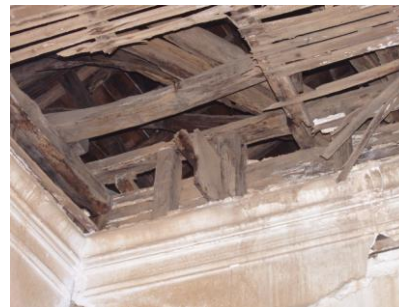
Εικόνα 20: Κατάρρευση στέγης λόγω όμβριων υδάτων
