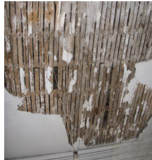
Εικόνα 33: Αποδιοργάνωση και διάβρωση οροφής
