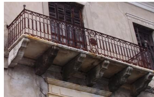
Εικόνα 61: Οξείδωση κιγκλιδωμάτων προβόλου και διάβρωση μαρμάρινων φορούσιων
