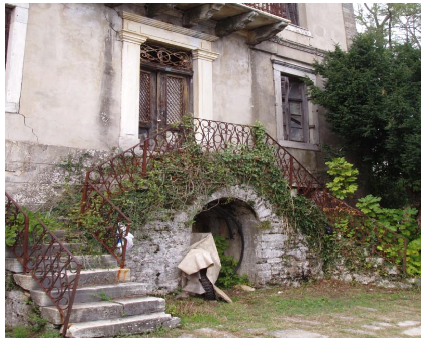
Εικόνα 57: Αποσάθρωση εξωτερικού κλιμακοστασίου
