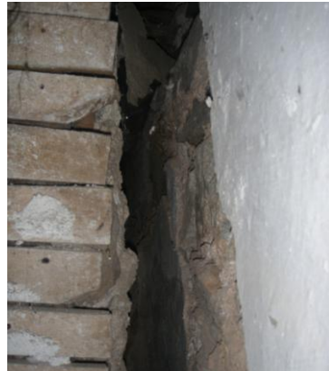
Εικόνα 5: Πλήρη αποκόλληση τοίχων
