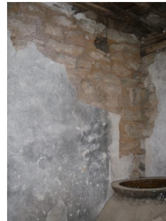
Εικόνα 1: Κατάρρευση επιχρίσματος λόγω υγρασίας
