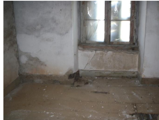
Εικόνα 39: Κατάρρευση τοιχοποιίας στις ποδιές
