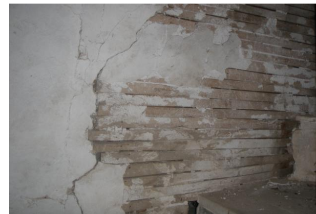
Εικόνα 6: Αποσάθρωση- αποδιοργάνωση ξυλόπηκτης τοιχοποιίας
