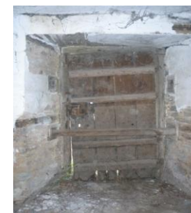
Εικόνα 35: Αποδιοργάνωση λόγω υγρασίας
