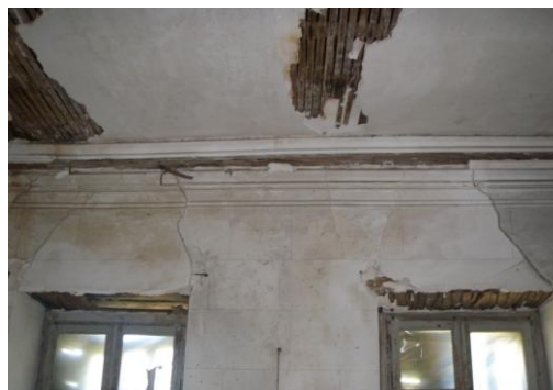
Εικόνα 14: Ρωγμές κοντά στα ανοίγματα
