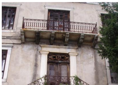
Εικόνα 43: Διάβρωση κεντρικής εισόδου
