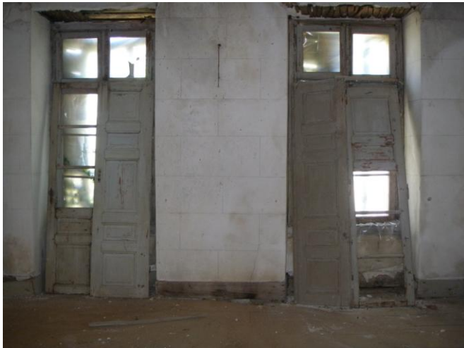
Εικόνα 38: Αποδιοργάνωση κονιάματος υπερθύρων
