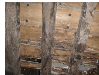
Εικόνα 23: Διάβρωση ξύλινης οροφής
