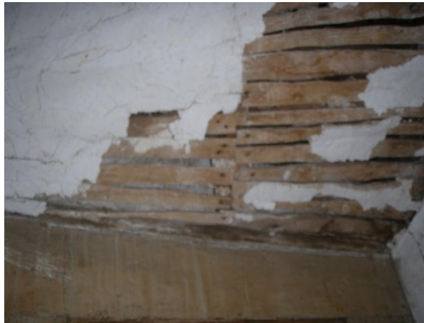
Εικόνα 55: Επικείμενη κατάρρευση σκάλας
