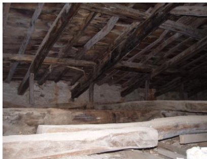
Εικόνα 19: Διάβρωση πήχων πετσώματος
