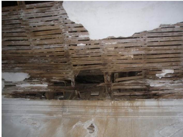
Εικόνα 32: Πλήρης κατάρρευση οροφής
