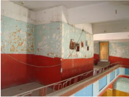
Εικ.23 Αποσάθρωση επιχρίσματος στον εξώστη.
