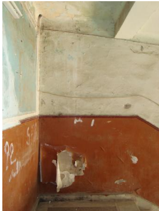
Εικ.26 Αποσάθρωση επιχρίσματος στο κλιμακοστάσιο.
