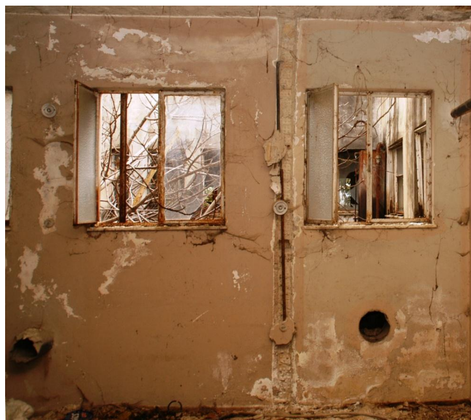
Εικόνα 134. Αποφλοίωση χρώματος σε τοιχοποιία του κτιρίου 3.
