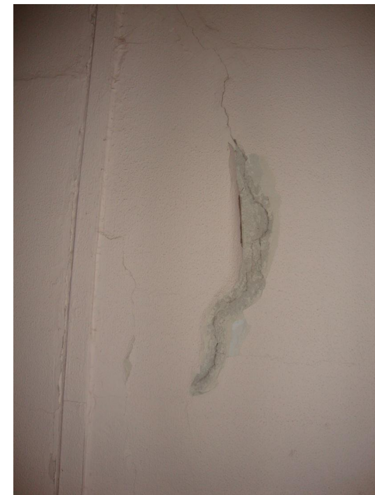
Εικόνα 130. Απλή ρηγματώση έως 0,3 cm στον χώρο του διαδρόμου του κτιρίου 1.
