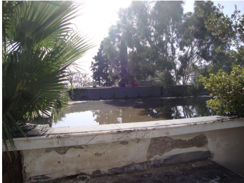
Εικόνα 131. Όμβρια ύδατα που λιμνάζουν στο επίπεδο του δώματος.
