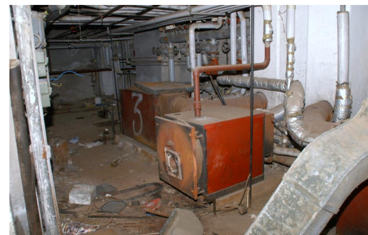
Εικόνα 136. Λέβητες εκτός λειτουργίας.
