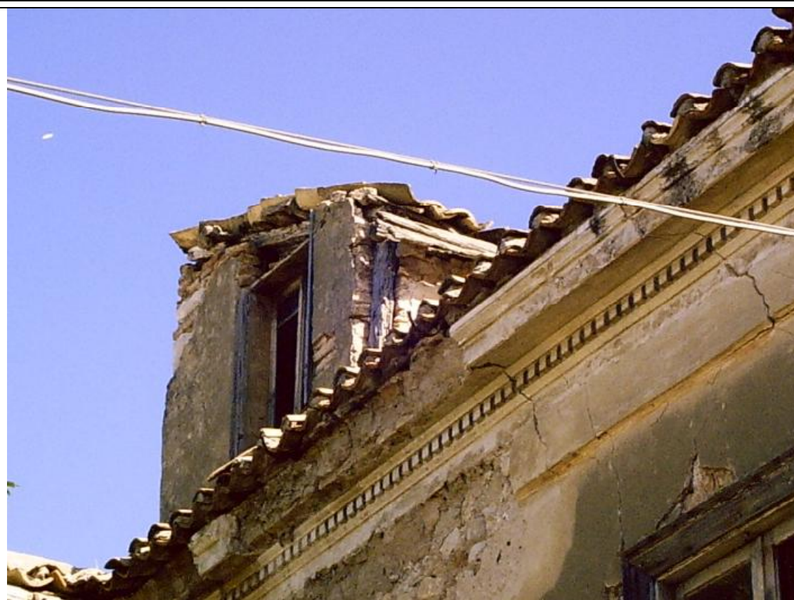
(εικ.6) Άνοιγμα στην σοφίτα, απώλεια κλιμακοστασίου
