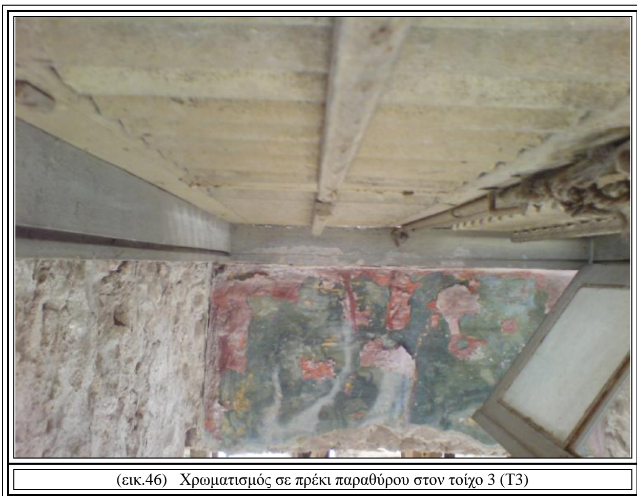
(εικ. 45) Χρωματισμοί σε πρέκια παραθύρων στο ισόγειο στον τοίχο 2 και στον τοίχο 3
