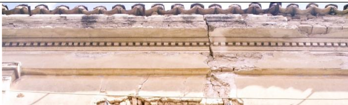
(εικ.56) Βλάβες στη βάση της στέγης
