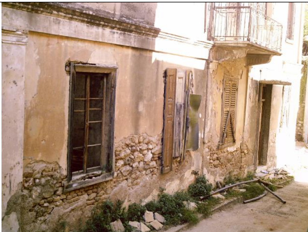
(εικ.54) Αποσάθρωση συνδετικού κονιάματος
