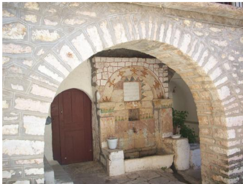
Εικόνα 28 η εσωτερική βρύση
