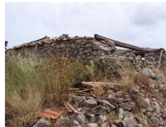
Εικόνα 57: Κτίσμα μετά από σεισμό
