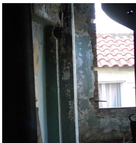
Εικόνα 72:Κατάρρευση εσωτερικών κουφωμάτων
