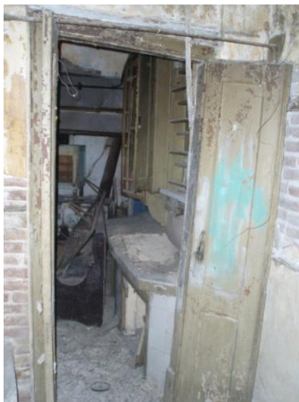
Εικόνα 67: Διάβρωση εσωτερικού κουφώματος
