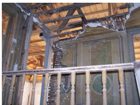
Εικόνα 17: Αποκόλληση επιχρίσματος Ευλόπηκτης τοιχοποιίας
