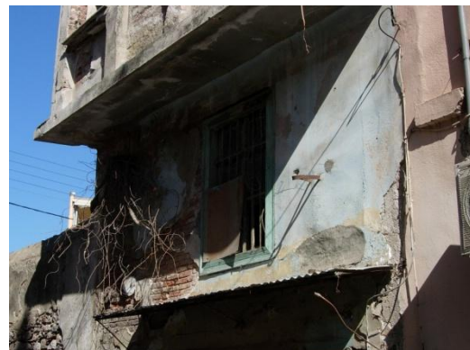
Εικόνα 70: Οξείδωση προστατευτικής σιδεριάς
