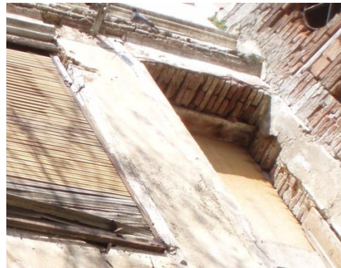
Εικόνα 54: Διάβρωση ξύλινου πρεκιού
