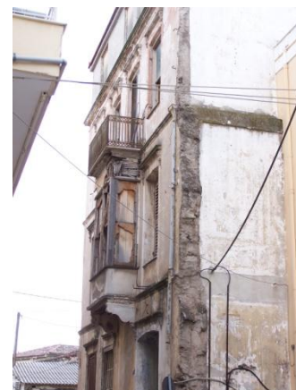
Εικόνα 75: Αλλοίωση επιχρίσματος λόγω ατμοσφαιρικής ρύπανσης
