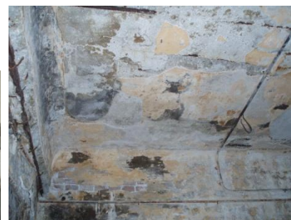
Εικόνα 27: Μερική κατάρρευση τοιχοποιίας
