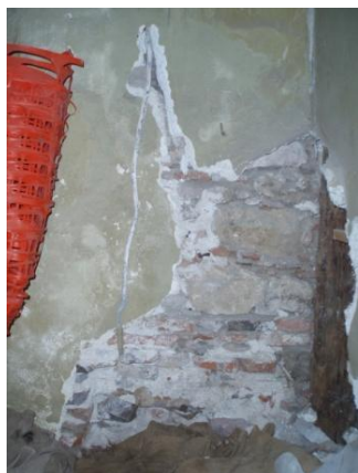
Εικόνα 7: Κατάρρευση επιχρίσματος κάτω από τη σκάλα
