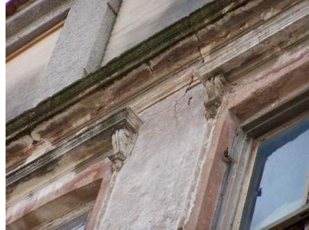
Εικόνα 90: Διάβρωση γύψινων κορνιζών
