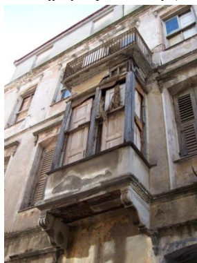
Εικόνα 60: Αποσάθρωση ξύλινων στοιχείων
