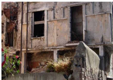
Εικόνα 23: Οξείδωση μεταλλικών στοιχείων
