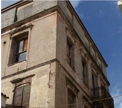
Εικόνα 62: Διάβρωση κουφωμάτων μπαλκονόπορτας
