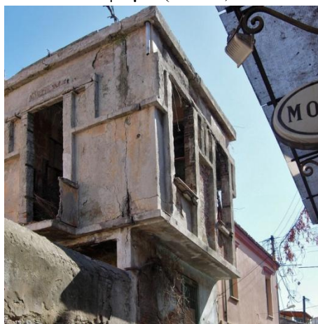
Εικόνα 71:Κατάρρευση εξωτερικών κουφωμάτων
