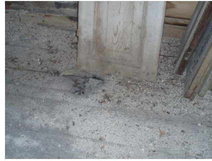
Εικόνα 41: Αποσάθρωση ξύλινου σαπέδου
