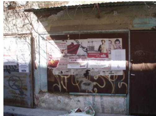
Εικόνα 66: Οξείδωση μεταλλικών κουφωμάτων
