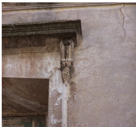
Εικόνα 74:Αλλοίωση επιχρίσματος λόγω υγρασίας
