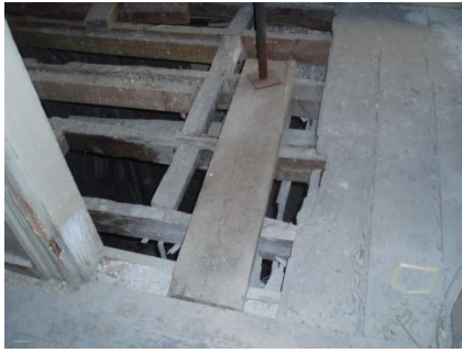
Εικόνα 40: Κατάρρευση ξύλινου δαπέδου
