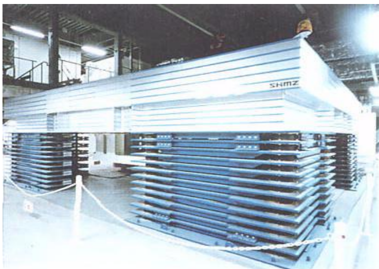
Σχήμα 5.50 Ο υβριδικός αποσβεστήρας που εγκαταστάθηκε στο κτήριο.
