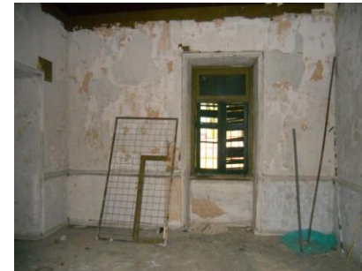
Εικ.68 Αποσάθρωση επιχρίσματος.
