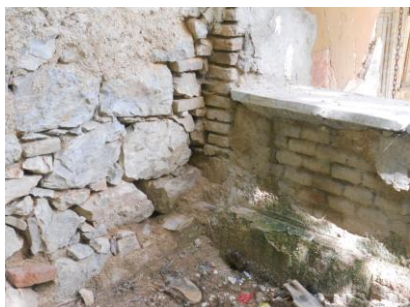
Εικ.65 Τοπική αποδιοργάνωση λιθοδομής.
