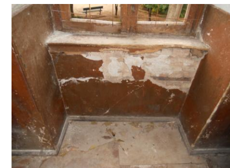
Εικ.78 Αποσάθρωση και κατάρρευση επιχρίσματος.
