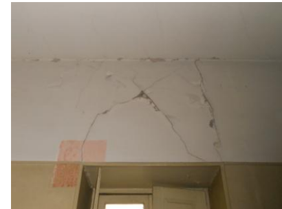
Εικ.71 Χιαστί ρωγμές - Διατμητική αστοχία.
