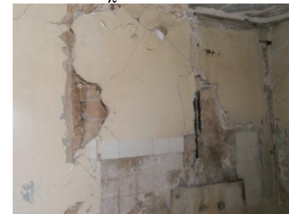
Εικ.74 Αποκόλληση και κατάρρευση επιχρίσματος.
