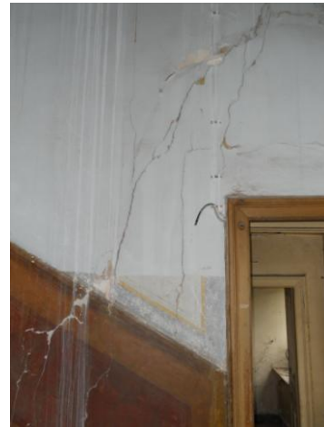
Εικ.80 Τριχοειδείς ρωγμές.
