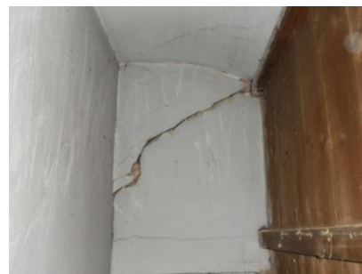
Εικ.82 Έντονη ρωγμή.
