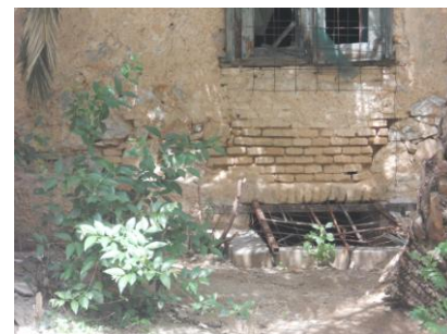
Εικ.67 Αποσάθρωση κονιάματος δομής και αρμολογήματος.
