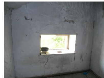
Εικ.83 Αποσάθρωση και αποκόλληση επιχρίσματος.
