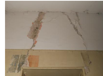
Εικ.72 Έντονες ρωγμές.
