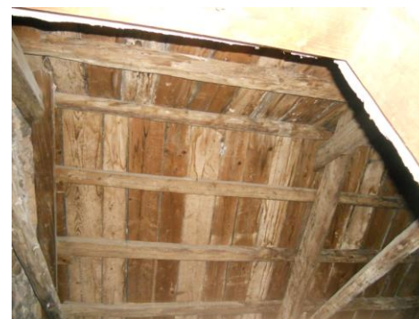
Εικ.85 Φθορές στα ξύλινα στοιχεία της στέγης.
