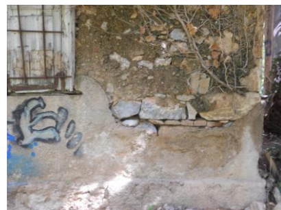
Εικ.66 Κατάρρευση επιχρίσματος.
