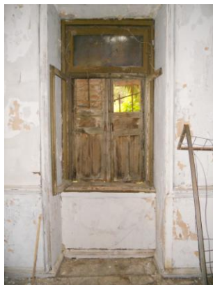
Εικ.92 Σήψη κουφωμάτων.
