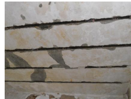
Εικ.86 Αποσάθρωση και κατάρρευση επιχρίσματος.
