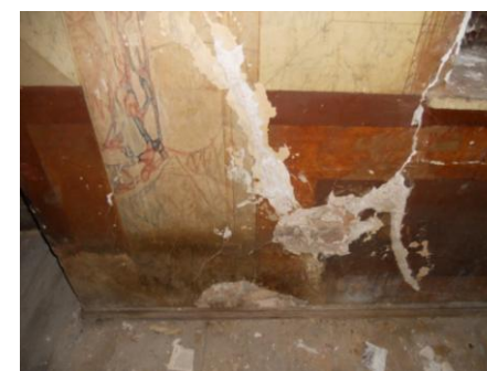
Εικ.77 Έντονη ρηγματώση και αποσάθρωση.
