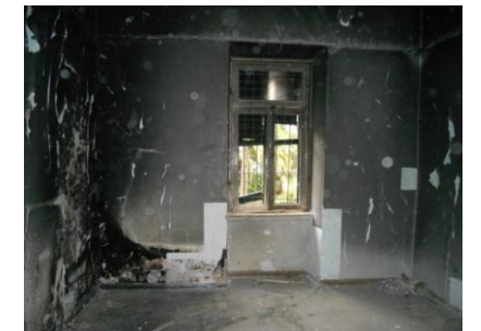
Εικ.76 Αποσάθρωση και αποκόλληση επιχρίσματος από φωτιά.
