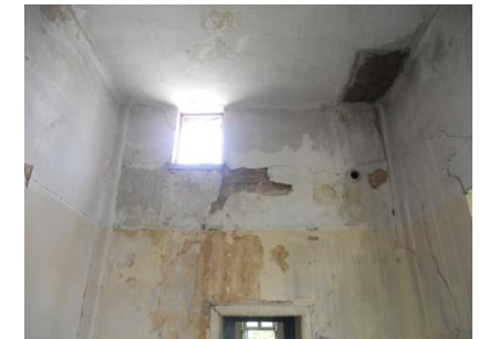
Εικ.70 Αποσάθρωση και κατάρρευση επιχρίσματος.
