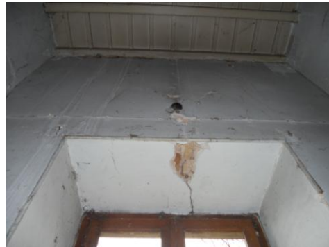
Εικ.79 Έντονη ρηγματώση.
