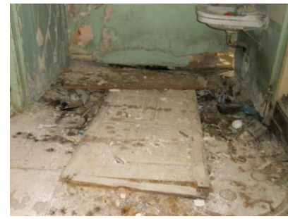
Εικ.91 Αποκόλληση και κατάρρευση δαπέδου.
