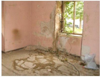
Εικ.89 Φθορά ξύλινου πατώματος.
