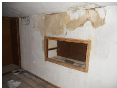
Εικ.81 Αποσάθρωση επιχρίσματος.
