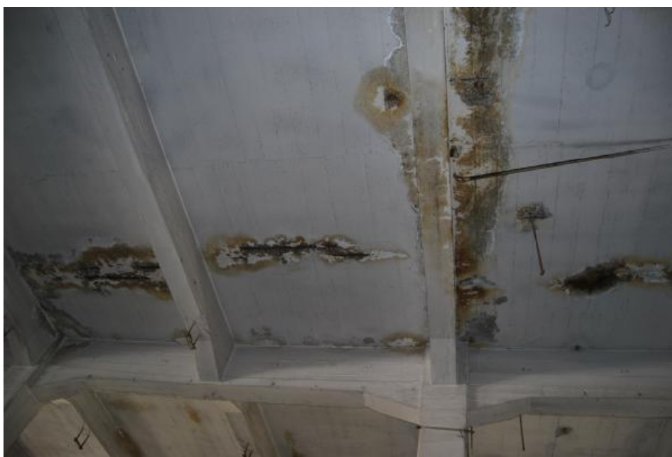
Εικ. 16: Κηλίδες από υγρασία στην οροφή του ισογείου.
