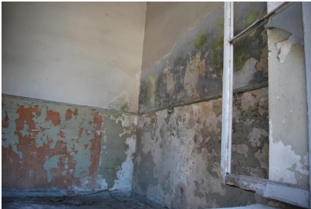
Εικ. 22: Αποφλοίωση χρώματος
