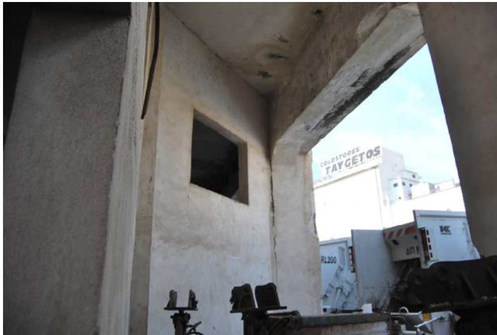
Εικ. 15: Χώρος 009. Κατακόρυφη ρωγμή λόγω κακής σύνδεσης της τοιχοποιίας με τους γωνιόλιθους.
