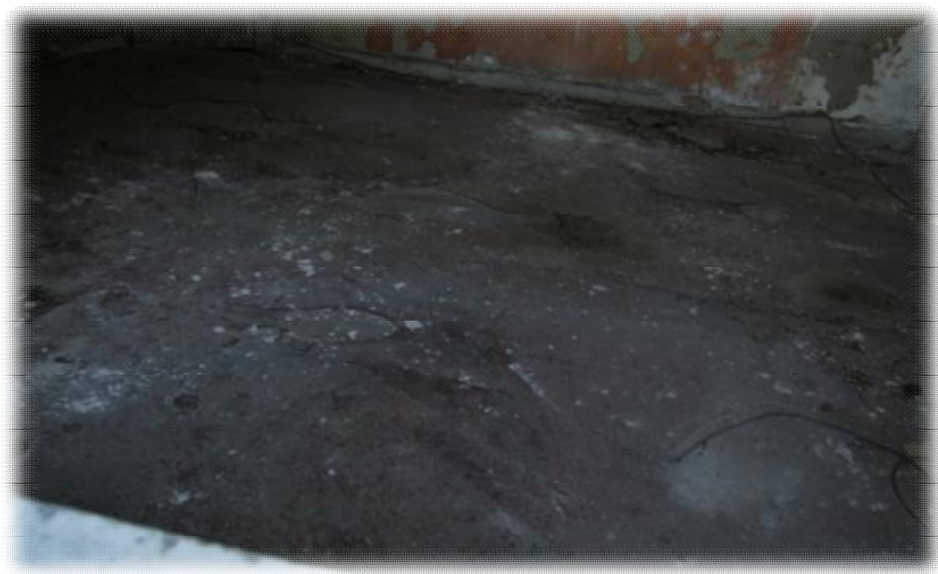
Εικ. 23: Βλάβες στο μωσαϊκό δάπεδο.
