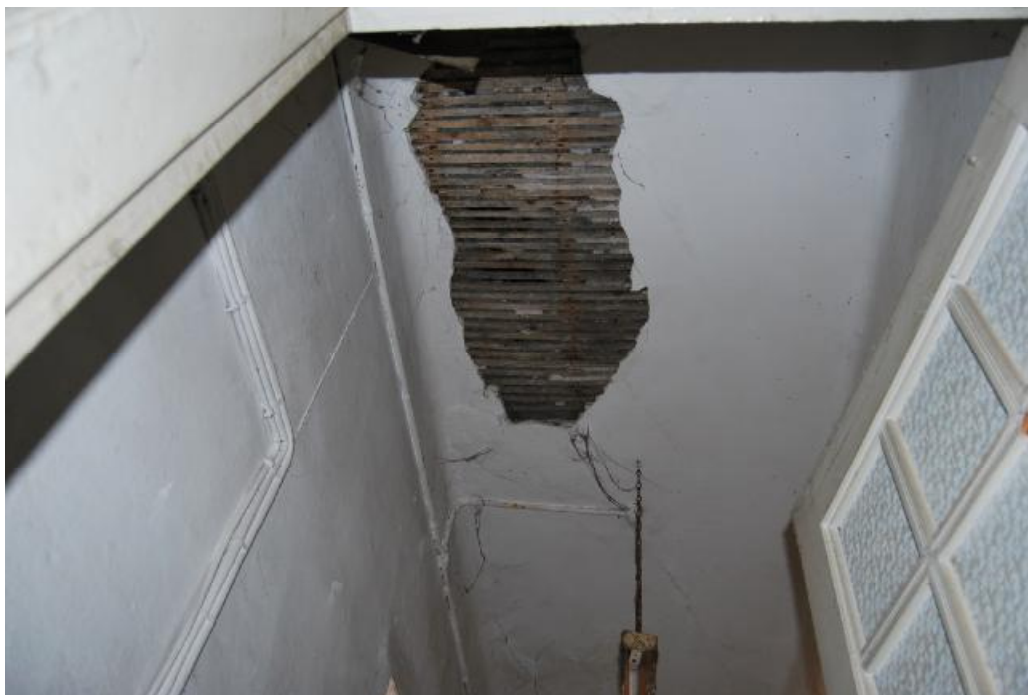
Εικ. 20: Τμηματική κατάρρευση οροφής
