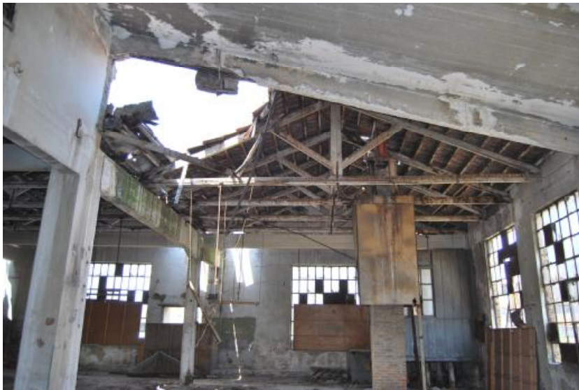
Εικ. 18: Κατάρρευση ξύλινης στέγης.
