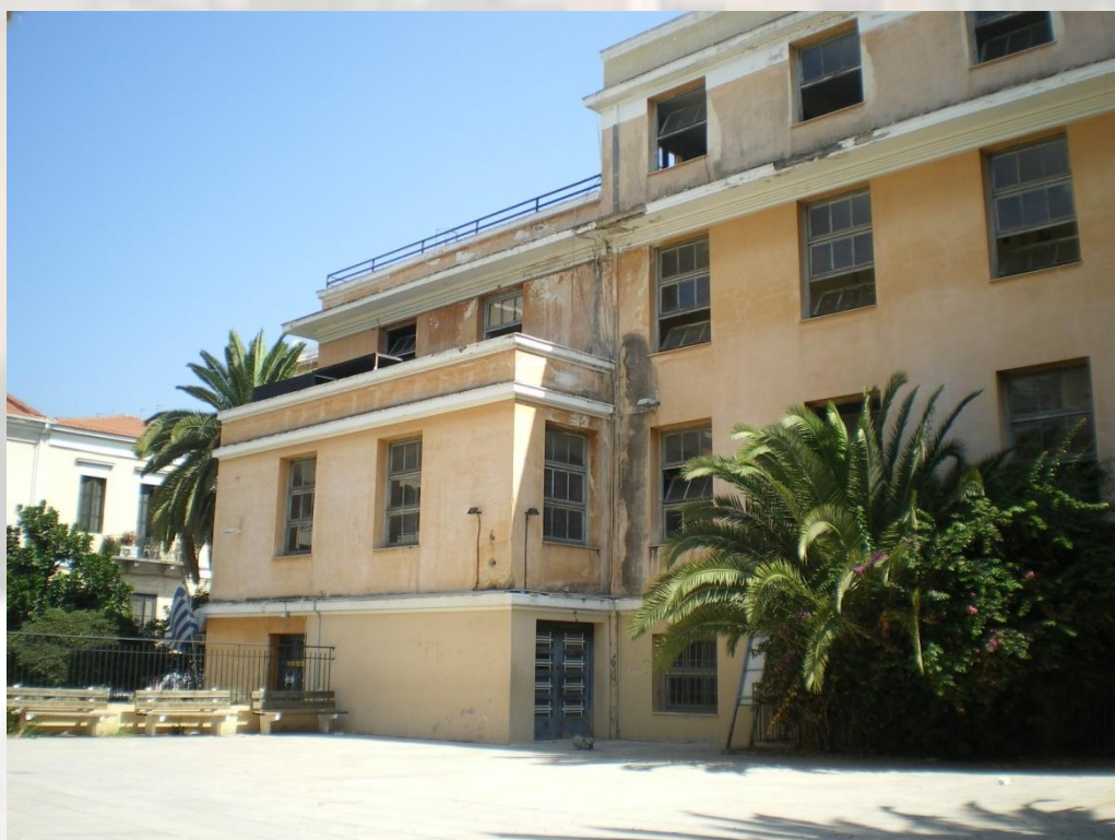
Εικόνα 68 Αποχρωματισμός και εμφάνιση υγρασίας .
