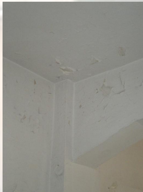
Εικόνα 61 (Δεξιά φωτ.)Αποφλοίωση χρώματος.
