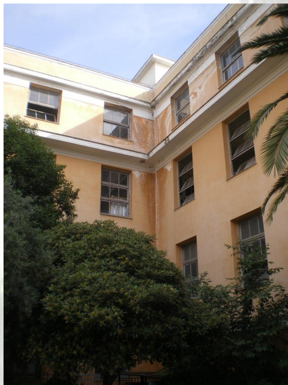
Εικόνα 73 Αποχρωματισμός- μερική κατάρρευση επιχρίσματος στα τραβηχτά.
