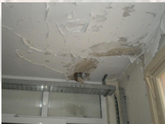
Εικόνα 50 Αποφλοίωση χρώματος εξαιτίας της υγρασίας.
