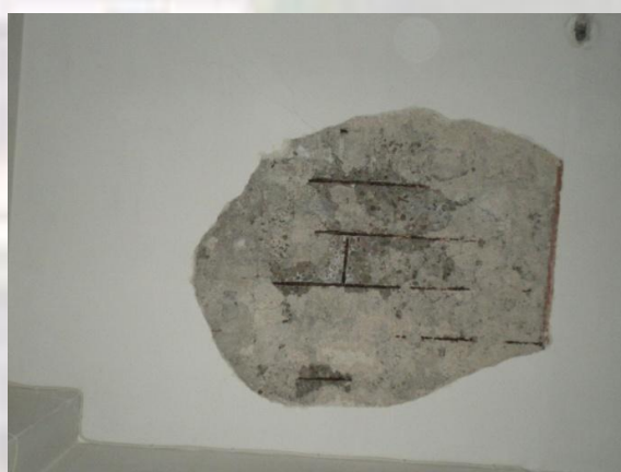
Εικόνα 49 (Δεξιά φωτ.)κατάρρευση επιχρίσματος εμφανές οπλισμός .
