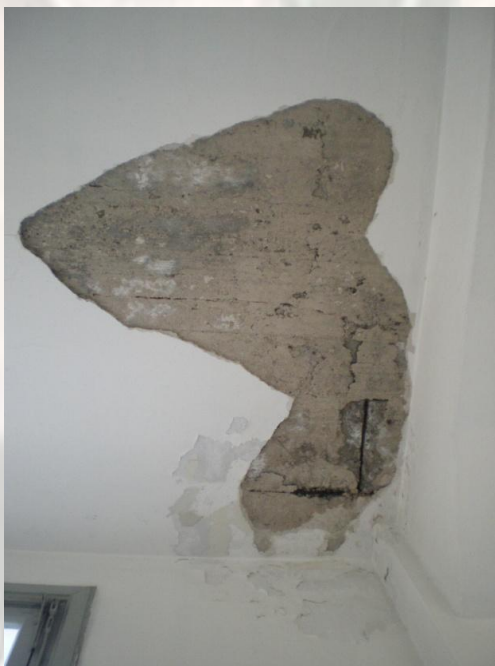
Εικόνα 60 Κατάρρευση επιχρίσματος εμφανές οπλισμός .
