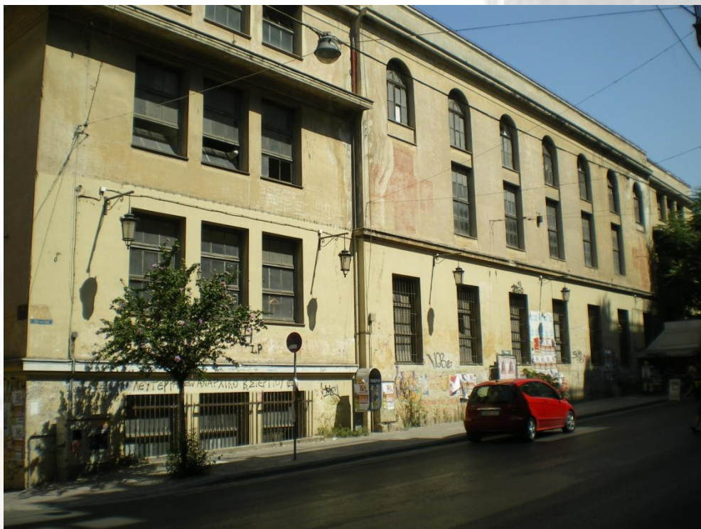
Εικόνα 69 Αποχρωματισμός όψη επί της Κορίνθου.
