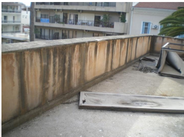
Εικόνα 66 Υγρασία και αποχρωματισμός.
