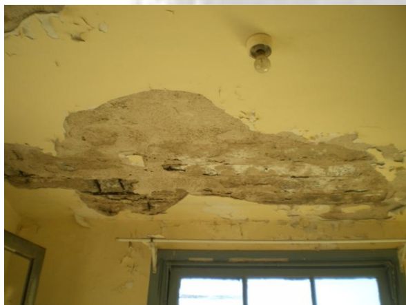
Εικόνα 53 (Δεξιά φωτ.)κατάρρευση στο επιχρίσματος εμφανές σπλισμός .
