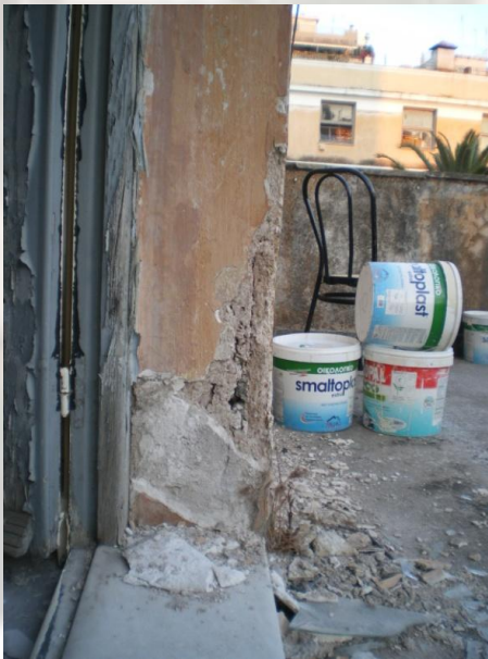
Εικόνα 64 Υγρασία και αποσάθρωση .
