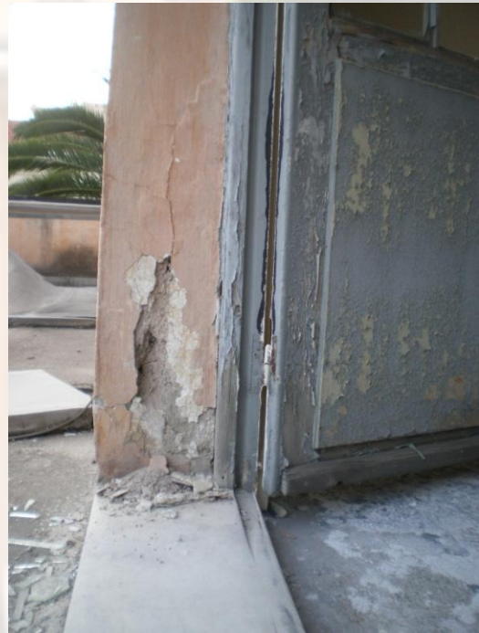
Εικόνα 65 Υγρασία και αποσάθρωση .
