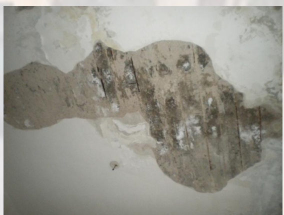
Εικόνα 51 (Δεξιά φωτ.)κατάρρευση επιχρίσματος εμφανές οπλισμός
