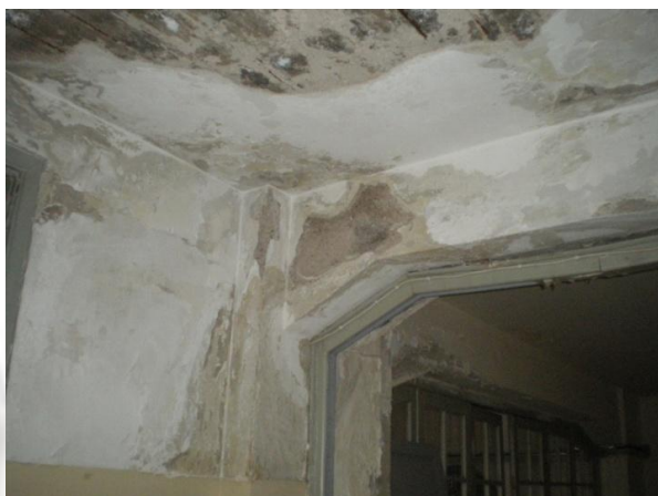
Εικόνα 52 Υγρασία στην οροφής και υποστύλωμα.
