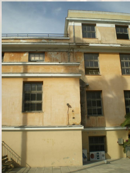
Εικόνα 74 Αποχρωματισμός- υγρασία-μερική κατάρρευση επιχρίσματος στα τραβηχτά.
