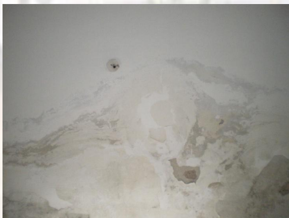
Εικόνα 48 Υγρασία σε οροφή.
