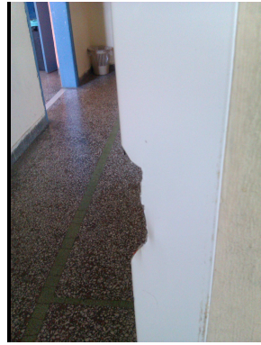
εικ.39. Αποκόλληση γωνιακού τμήματος τοίχου.
