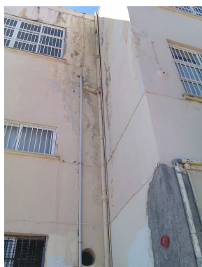
εικ.33. Σωλήνες ύδρευσης στις εξ. όψεις.
