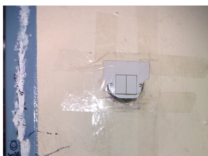
εικ.30. Ζημιές στο κάσσωμα και σπασμένος διακόπτης.
