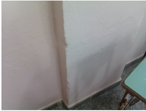
ικ.38. Σπάσιμο των επιχρισμάτων στις χαμηλές γωνίες των τοίχων.
