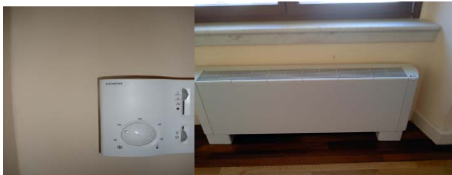
Εικόνα 2.3: (α),(β) Σύστημα κλιματισμού
