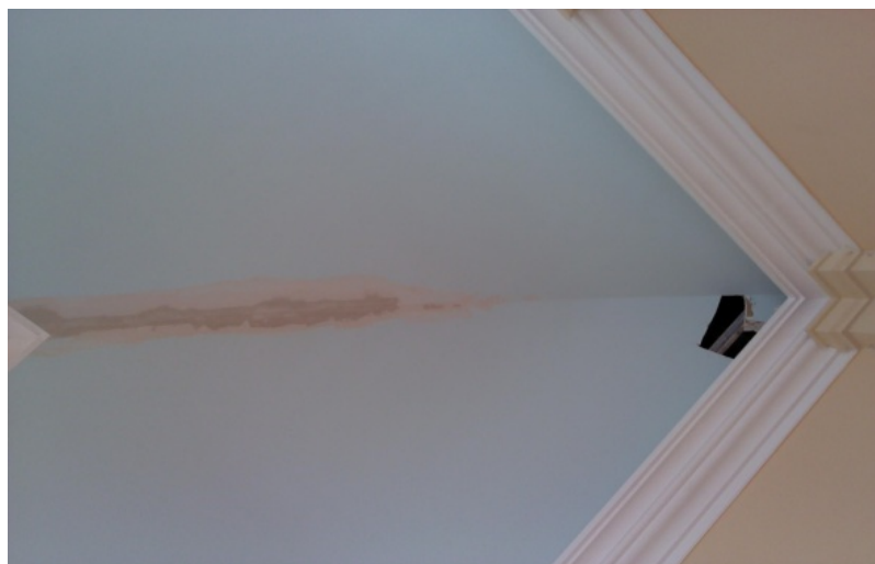
Εικόνα 2.1: Οροφή διαδρόμου ισογείου (λεπτομέρεια κατασκευαστικής αμέλειας και μεμονωμένη παθολογία από υγρασία)
