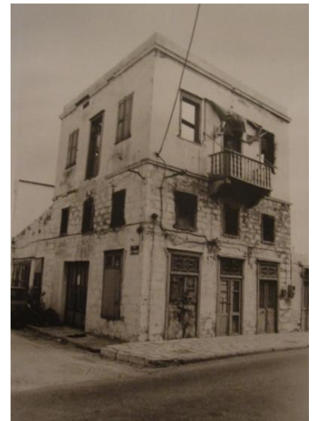
Εικόνα 168: Κτίριο με επιχρισμένη λιθοδομή στον όροφο και ανεπίχριστη στο ισόγειο από βιβλίο "Βιομηχανικά κτίρια στην Ερμούπολη"
