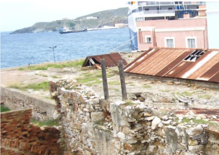
Εικόνα 139: Τοπικές καταστροφές σε τμήματα της μόνωσης του δώματος
