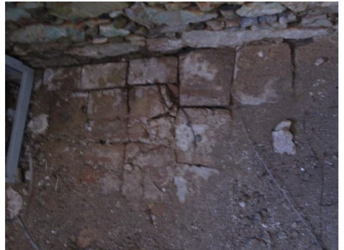
Εικόνα 136: Αποκολλημένοι και ραγισμένοι κυβόλιθοι στον χώρο 06
