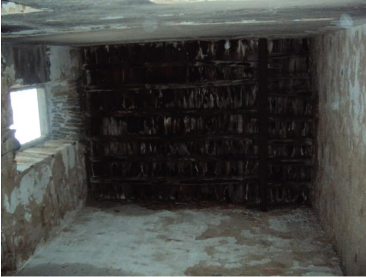
Εικόνα 141: Σάπισμα ξύλων και οξείδωση του διπλού "Τ" της οροφής του χώρου 06
