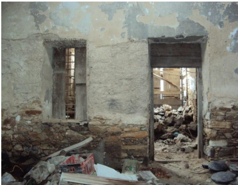
Εικόνα 115: Απώλεια ξύλινης θύρας, σάπισμα ξύλων και οξειδώσεις μεταλλικών στοιχείων(χώρος 01)
