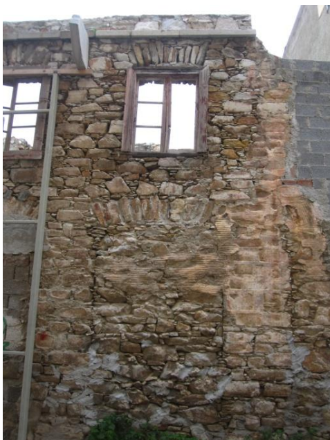
Εικόνα 127: Αντικατάσταση του αρχικού επιχρίσματος με μεταγενέστερα
