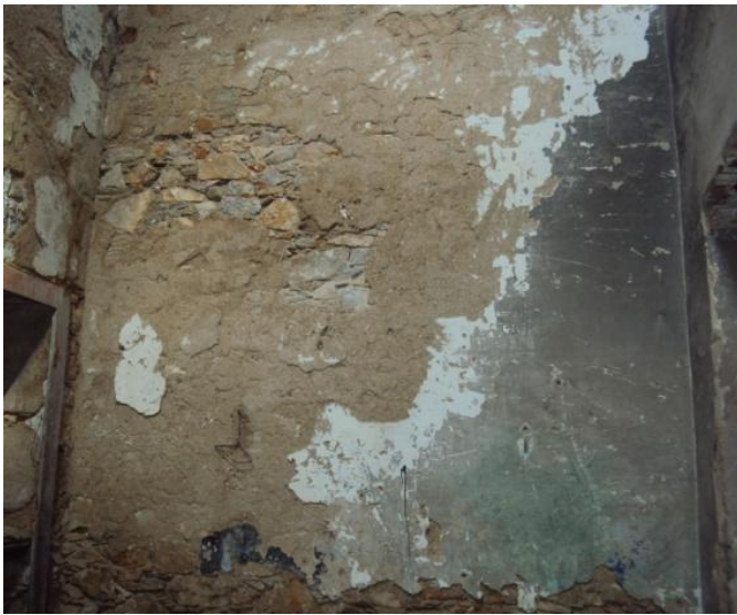
Εικόνα 125: Αποσαθρώσεις και αποκολλήσεις επιχρίσματος στους τοίχους του χώρου 06
