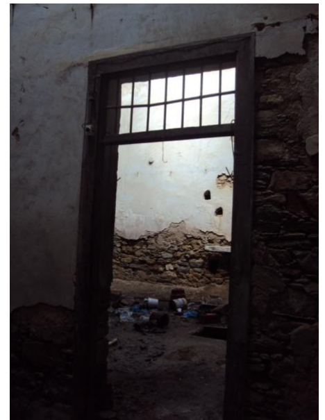
Εικόνα 116: Απώλεια ξύλινης θύρας του χώρου 03, σάπισμα ξύλων και οξειδώσεις μεταλλικών στοιχείων της κάσας
