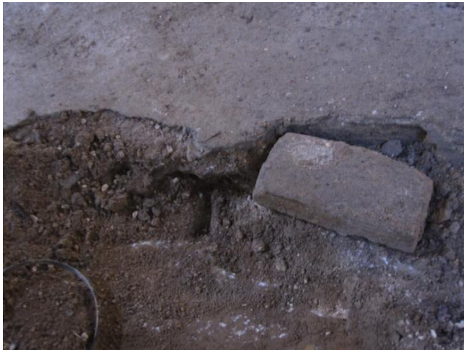
Εικόνα 135: Ολική καταστροφή τμήματος δαπέδου στον χώρο 01
