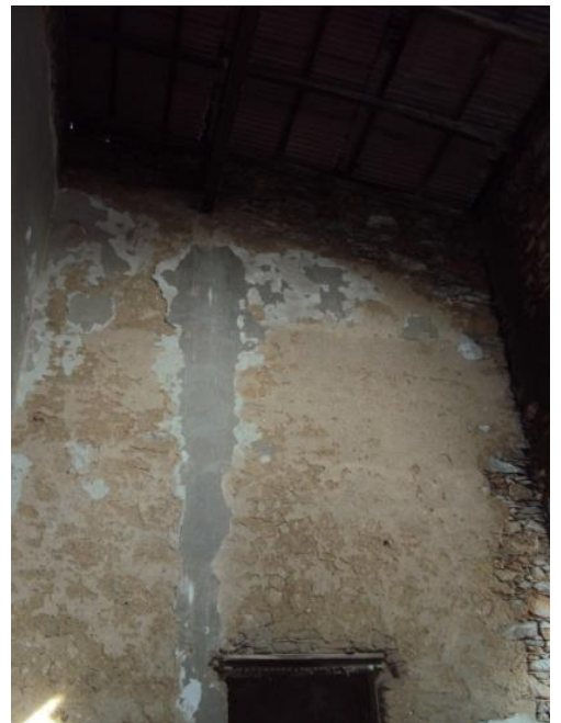
Εικόνα 132: Αποκόλληση της πρώτης στρώσης του επιχρίσματος στους τοίχους του χώρου 12
