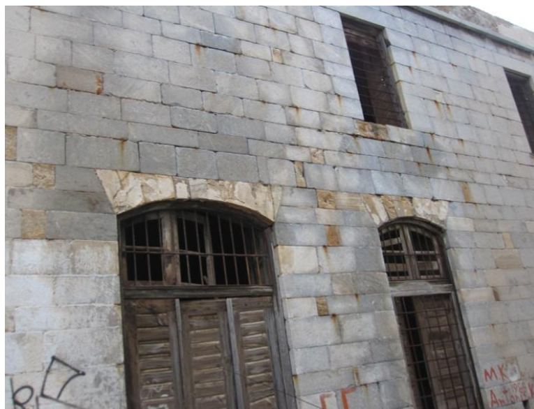
Εικόνα 120: Σάπισμα ξύλων, οξειδώσεις μεταλλικών στοιχείων, συνδέσμων και απώλειες υαλοστασίων στα κουφώματα της νότιας όψης
