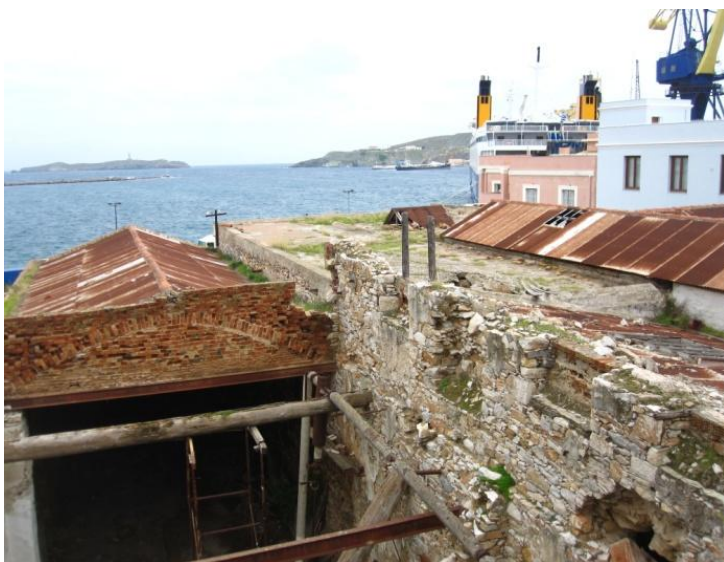
Εικόνα 83: Κατάρρευση ορόφου του όγκου της βορειοδυτικής πλευράς(02B)
