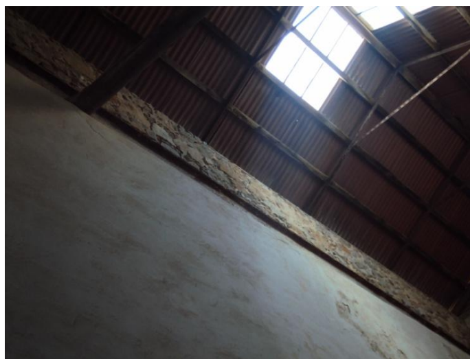
Εικόνα 94: Οξείδωση μεταλλικών στοιχείων, σάπισμα ξύλων και κατάρρευση υαλοστασίων των φεγγιτών στην στέγη του χώρου 04
