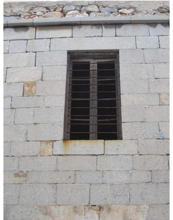
Εικόνα 122: Σάπισμα ξύλων, οξειδώσεις μεταλλικών στοιχείων, συνδέσμων και απώλεια υαλοστασίων στα παράθυρα της νότιας όψης
