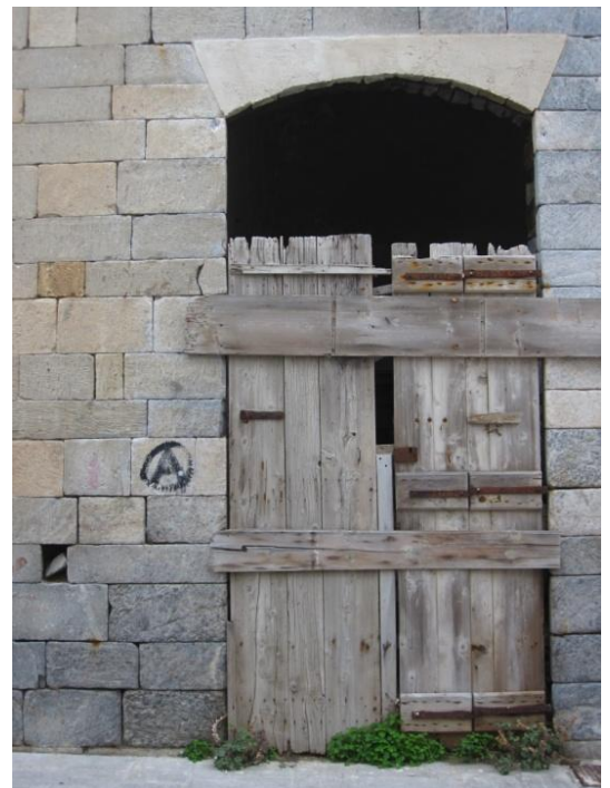
Εικόνα 112: Φράξιμο θύρας της νότιας όψης από ξύλινες σανίδες
