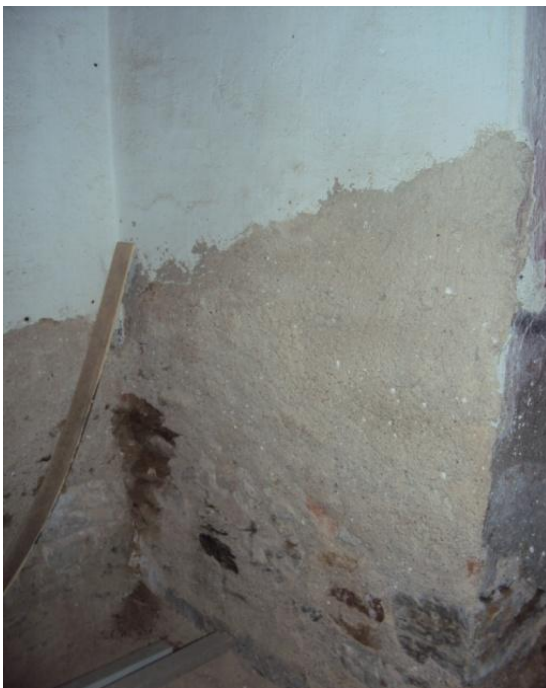
Εικόνα 147: Ξέπλυμα χρώματος στους τοίχους του χώρου 07
