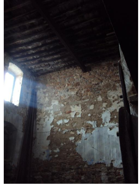
Εικόνα 142: Σάπισμα ξύλων και οξείδωση διπλού "Τ" στην οροφή του χώρου 05
