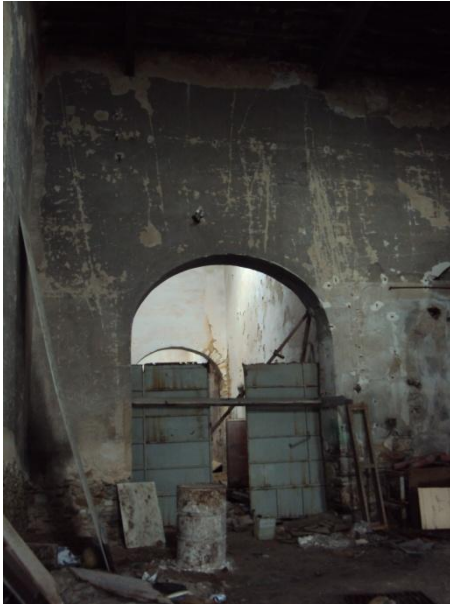
Εικόνα 145: Αποφλοίωση και ξέπλυμα χρώματος στους τοίχους του χώρου 01
