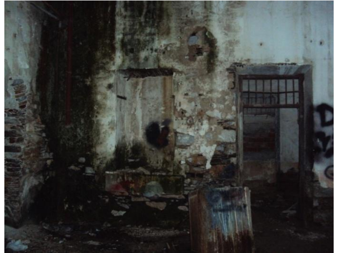
Εικόνα 90: Εκτεταμένη εμφάνιση μικροχλωρίδας σε τοίχους του χώρου 03, λόγω κατάρρευσης της στέγης
