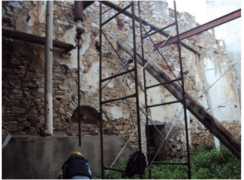
Εικόνα 130: Καταρρεύσεις και αποκολλήσεις επιχρίσματος στους τοίχους του χώρου 02B
