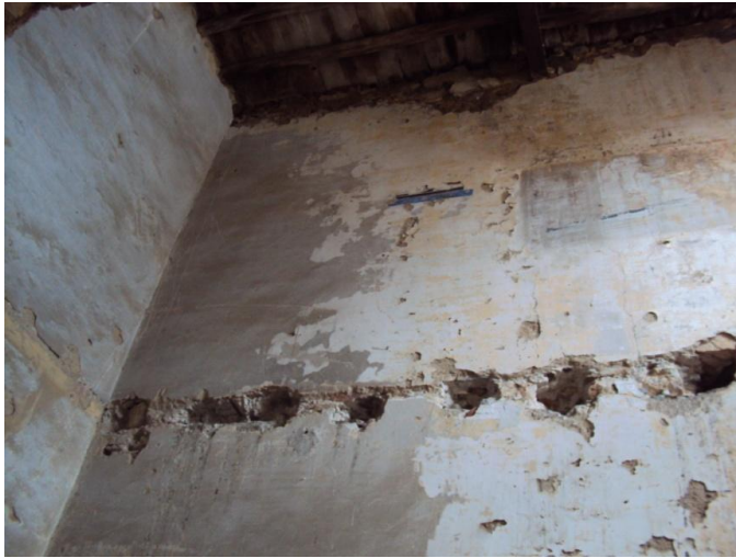
Εικόνα 133: Οπές σε τοιχοποιίες των χώρων 06&09 λόγω κατάρρευσης του μεσοπατώματος.
