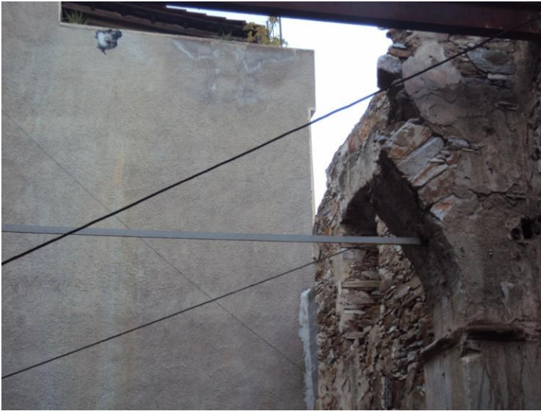
Εικόνα 85: Κατάρρευση καμάρας στον χώρο 02B
