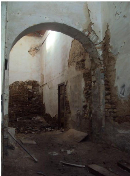
Εικόνα 123: Καταρρεύσεις και αποκολλήσεις επιχρισμάτων στον χώρο 04
