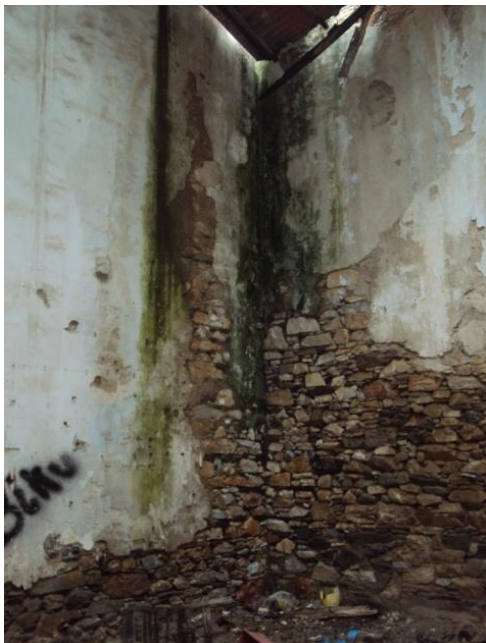
Εικόνα 131: Καταρρεύσεις επιχρίσματος και εμφάνιση μαυρίσματος λόγω της καθοδικής υγρασίας
