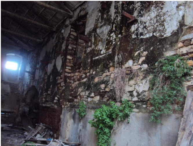
Εικόνα 87: Προσθήκη τοιχίου σε τοίχο του χώρου 02A & εκτεταμένη εμφάνιση μικλοχλωρίδας λόγω της υγρασίας
