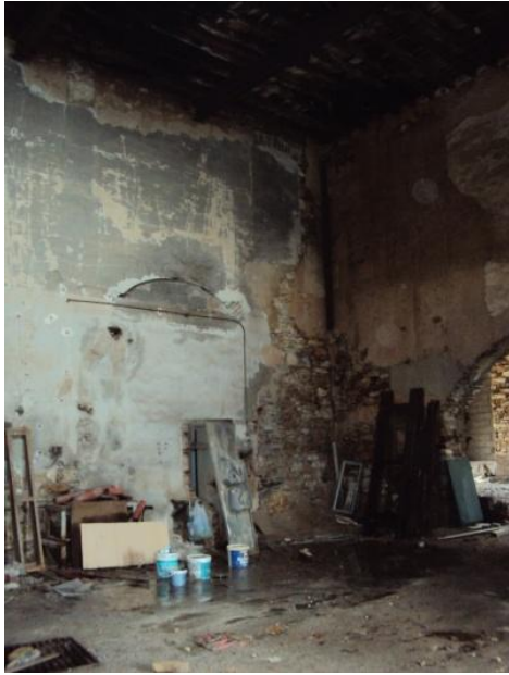
Εικόνα 129: Καταρρεύσεις και αποκολλήσεις του επιχρίσματος στους τοίχους του χώρου 01
