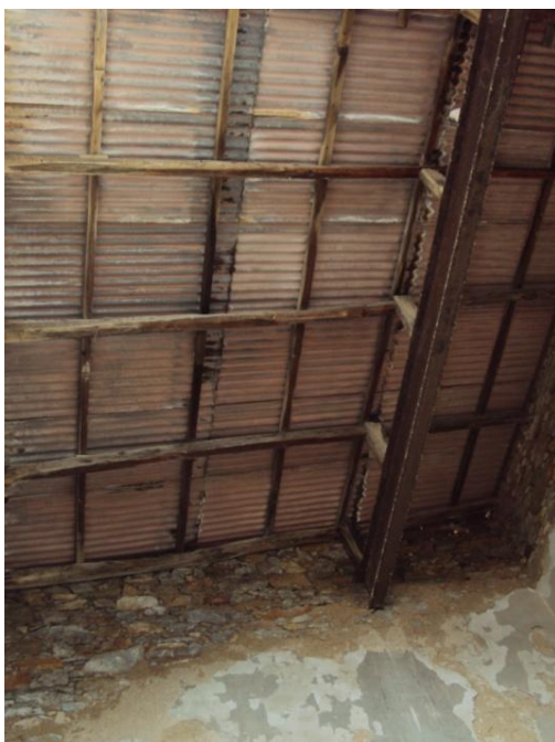
Εικόνα 95: Σάπισμα ξύλων και οξείδωση μεταλλικών στοιχείων της στέγης του χώρου 12
