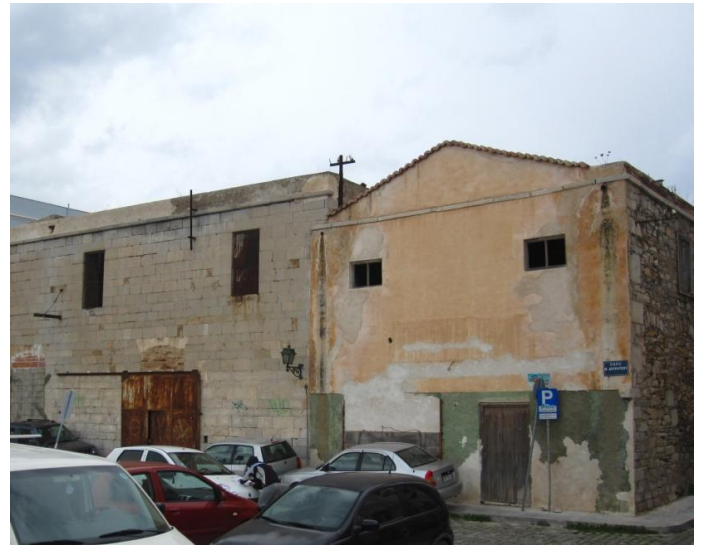
Εικόνα 126: Αποσάθρωση και αποκόλληση της πρώτης στρώσης του επιχρίσματος της ανατολικής όψης
