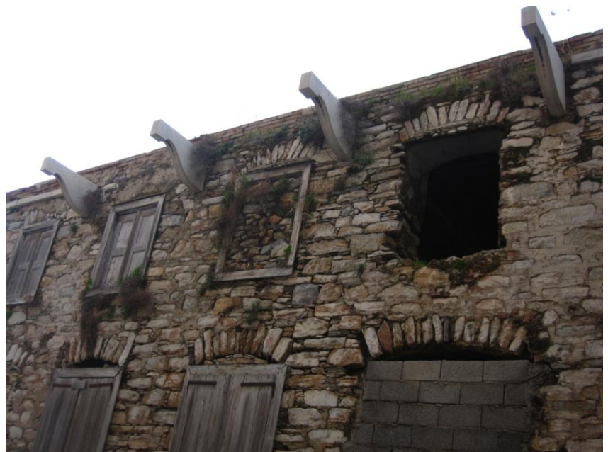
Εικόνα 92: Ρίζες φυτών στον τοίχο της βόρειας όψης
