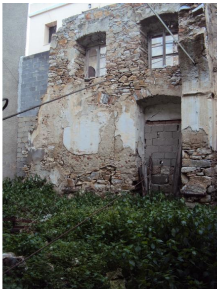
Εικόνα 81: Κατάρρευση τμήματος τοίχου βόρειας όψης(02B)
