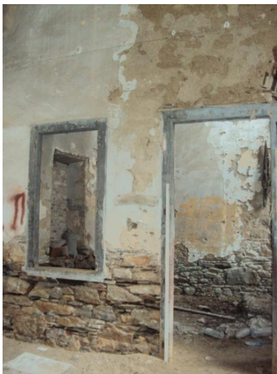
Εικόνα 117: Απώλεια κουφωμάτων και σάπισμα των εναπομενόντων ξύλων της κάσας , χώρος 08
