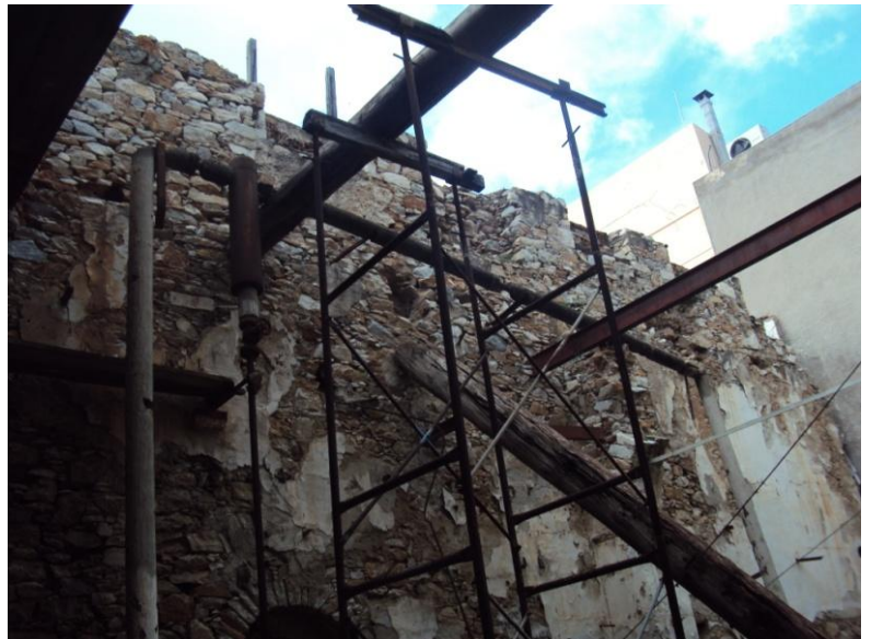
Εικόνα 72: Εναπομείναντες κατεστραμμένες σωληνώσεις στον χώρο 02B
