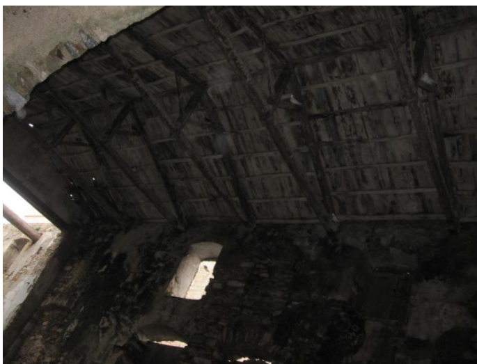
Εικόνα 93: Σάπισμα ξύλινων στοιχείων στέγης στον χώρο 02A
