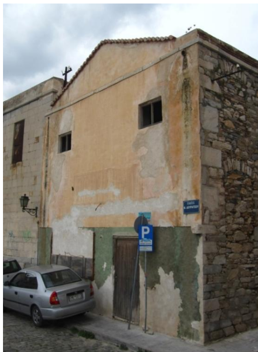
Εικόνα 119: Σάπισμα ξύλων και απώλειες υαλοστασίων στα κουφώματα της ανατολικής όψης
