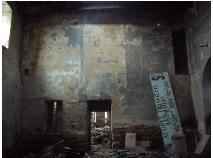
Εικόνα 124: Καταρρεύσεις, αποκολλήσεις και αποσαθρώσεις επιχρισματος στον χώρο 01
