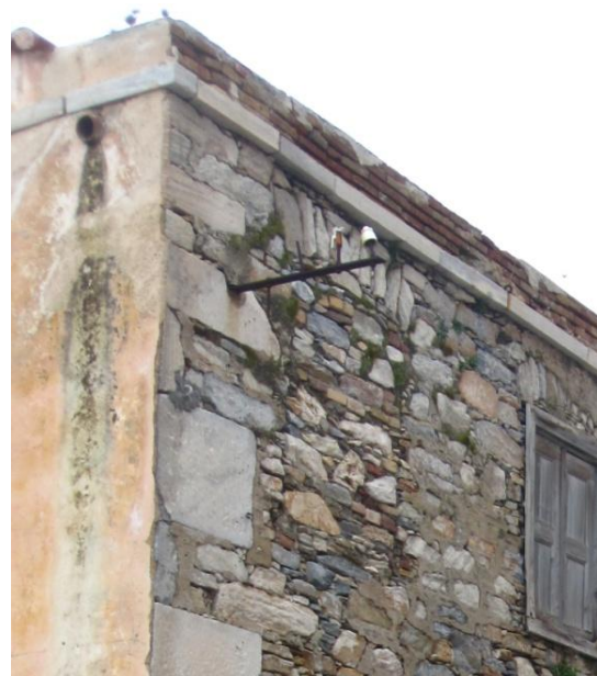
Εικόνα 98: Εμφάνιση πακτωμένων στοιχείων λόγω της τελευταίας χρήσης στις τοιχοποιίες εσωτερικά και εξωτερικά του κτιρίου
