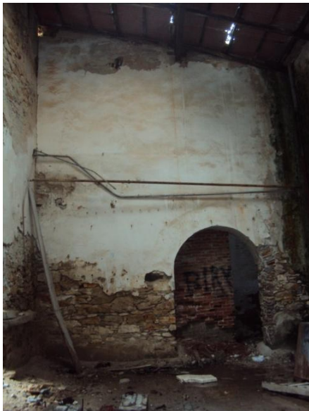
Εικόνα 71: Εναπομείναντες κατεστραμμένες σωληνώσεις στον χώρο 3
