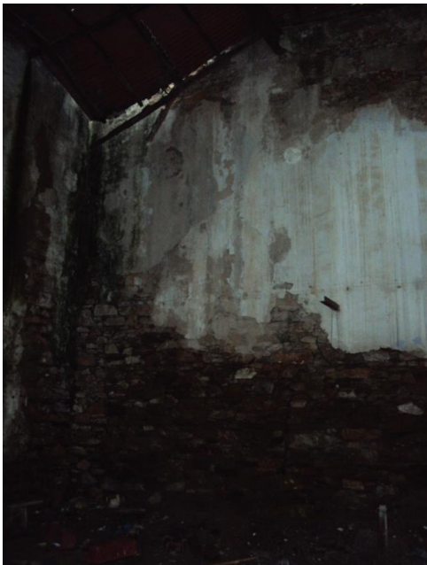
Εικόνα 91: Εκτεταμένη εμφάνιση μικροχλωρίδας στους τοίχους του χώρου 03, λόγω κατάρρευσης της στέγης
