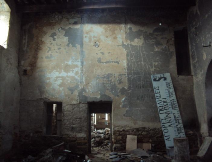
Εικόνα 89: Κακή ένωση μεταγενεστέρου τοίχου, άποψη από τον χώρο 01
