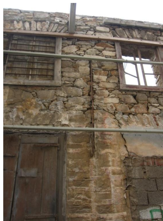
Εικόνα 118: Σάπισμα ξύλων, οξειδώσεις μεταλλικών στοιχείων, συνδέσμων και απώλειες υαλοστασίων στα κουφώματα της βόρειας όψης
