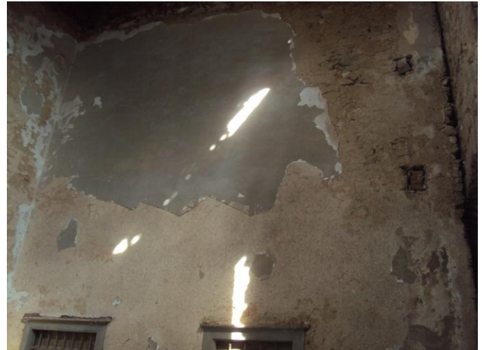
Εικόνα 88: Κακή ένωση μεταγενέστερου τοίχου στον χώρο 12
