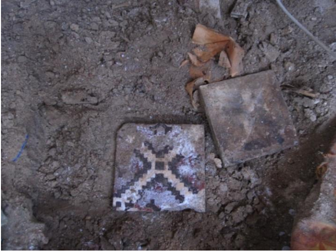
Εικόνα 137: Κατεστραμμένα κεραμικά πλακίδια δαπέδου στον χώρο 12
