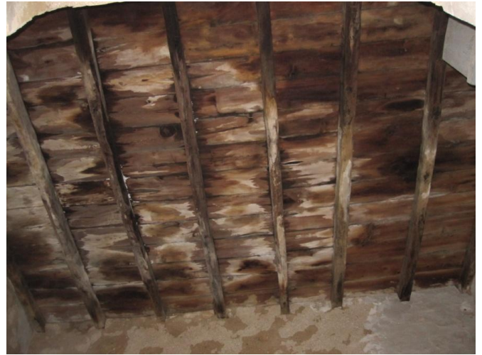
Εικόνα 134: Σάπισμα ξύλων των μεσοπατωμάτων των χώρων 07&11
