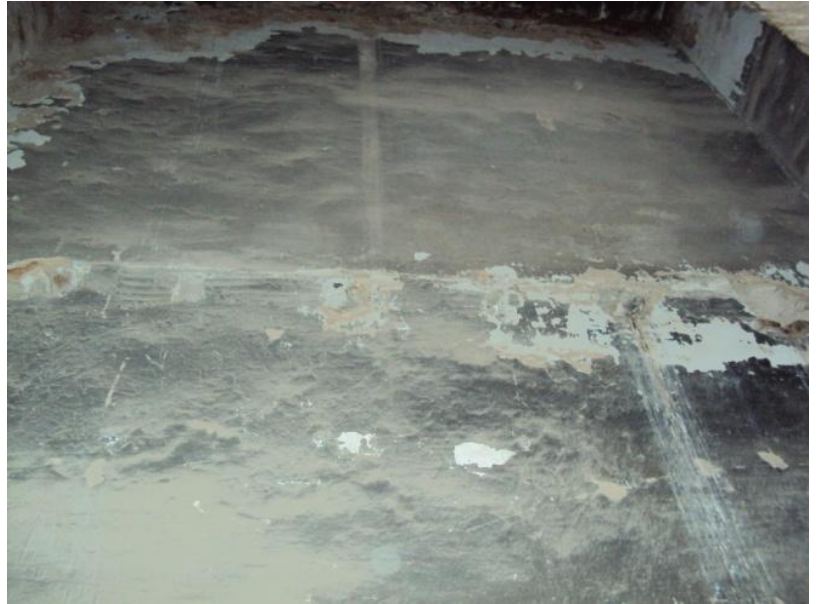
Εικόνα 146: Αποφλοίωση και ξέπλυμα χρώματος στους τοίχους του χώρου 06
