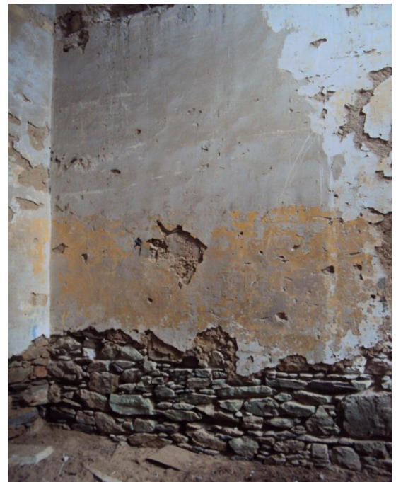
Εικόνα 148: Αποφλοίωση και ξέπλυμα χρώματος στους τοίχους του χώρου 09
