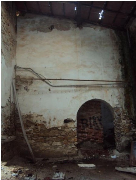
Εικόνα 143: Εναπομείναντες σωληνώσεις της τελευταίας χρήσης του κτιρίου, χώρος 03
