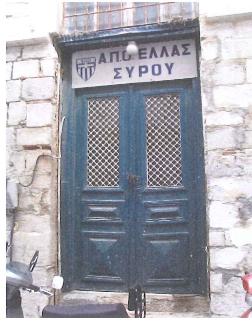
Εικ.91 Κρέμαση, φουσκώματα λόγω υγρασίας και σπασίματα υαλοπινάκων. Πόρτα νότιας όψης
