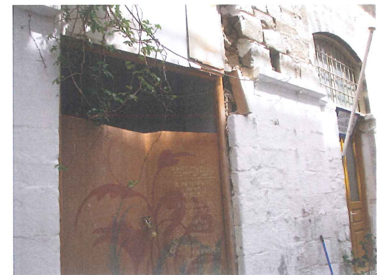
Εικ.86 Φούσκωμα του τμήματος, λόγω υγρασίας, στην νότια όψη
