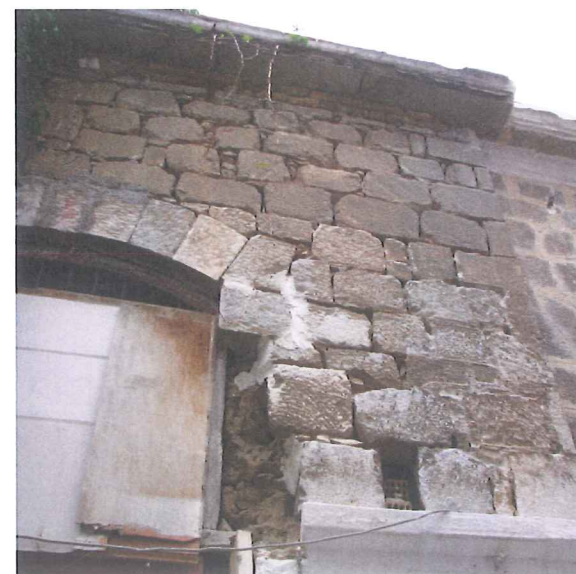
Εικ. 85 Κατάρρευση πλινθοδομής στην νότια όψη
