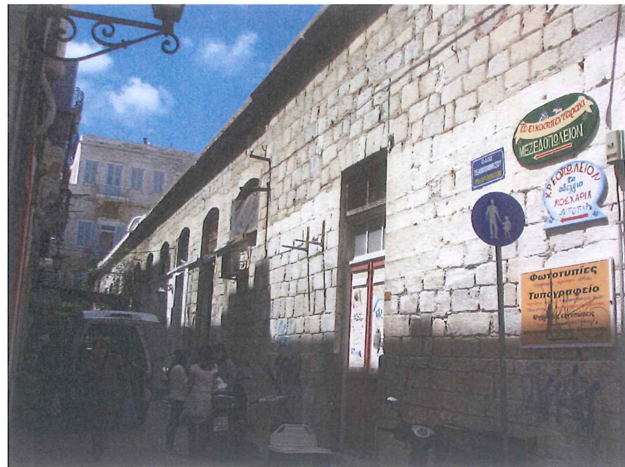
Εικ.90 Αποκόλληση συνδετικού κονιάματος, ρύττοι από γκράφιτι νότιας όψη
