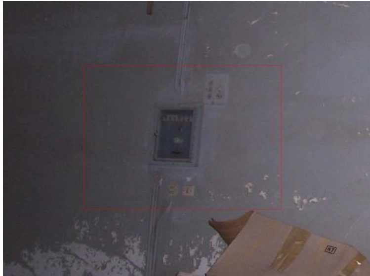
εικ.111: Γενικός πίνακας κτιρίου
