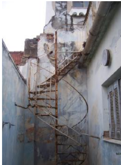
εικ.98: Εξωτερική μεταλλική κλίμακα για πρόσβαση στην οροφή
